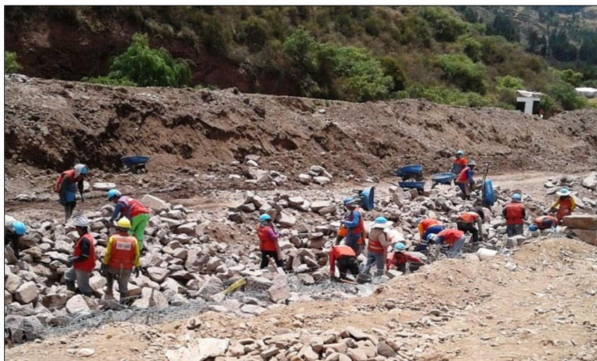
Figura 7. Evidencia de falta de organización en el frente de trabajo (Antes)
