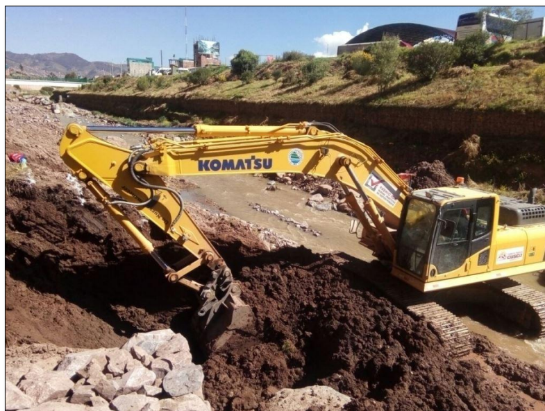
Figura 12. Se carece de check list de maquinaria de trabajo (Antes)
