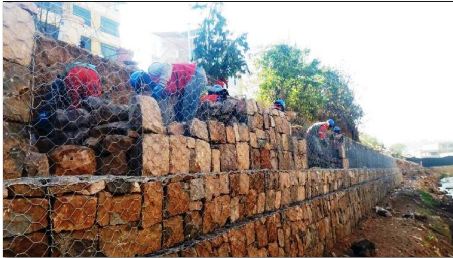
Figura 11. Falta de EPPs que identifique al personal con discapacidad (Antes)
