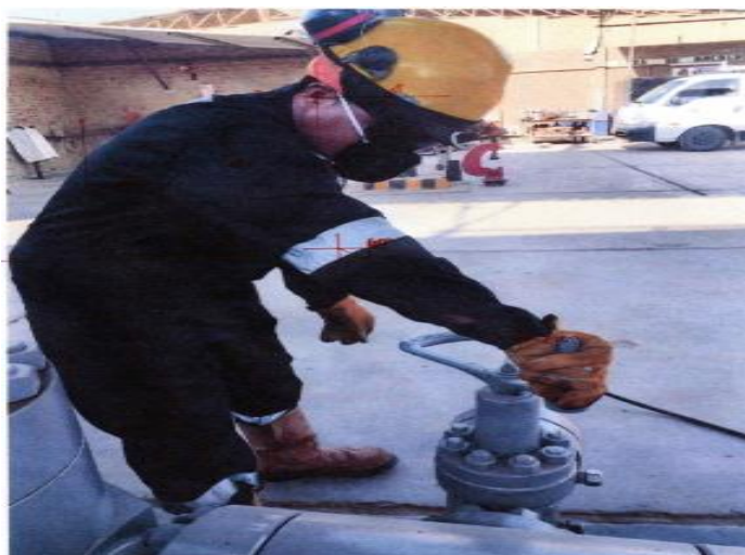
Ilustración 29. Cerrado de válvula que tiene el manifold.
