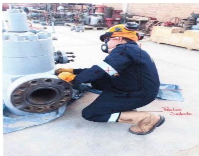
Ilustración 19. Revisión de la válvula.
