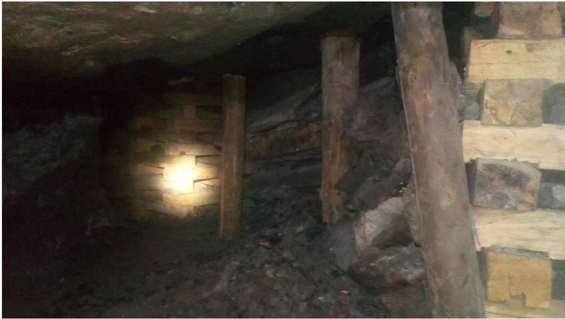
Figura 39. Sostenimiento de la labor, vista directa hacia el almacén de madera ubicada cerca a la rampa MAROSE NV 2670.
