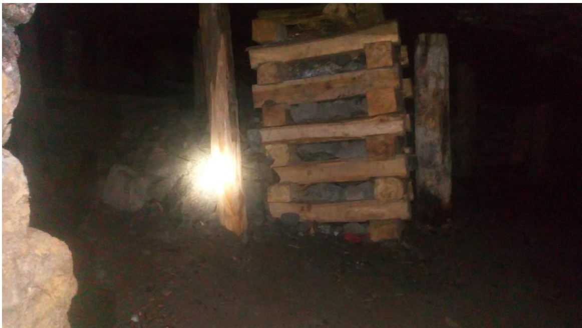
Figura 40. Sostenimiento en la labor mediante paquetes de madera o woodpacks con relleno y puntales de madera, vista directa hacia la salida principal frontera a la labor de la contrata ARIANA.
