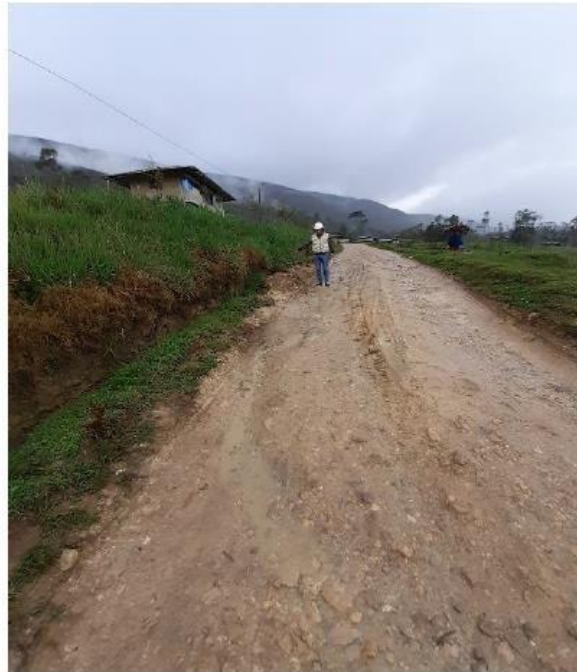
Figura 1. Vista del mal estado de la carretera.
