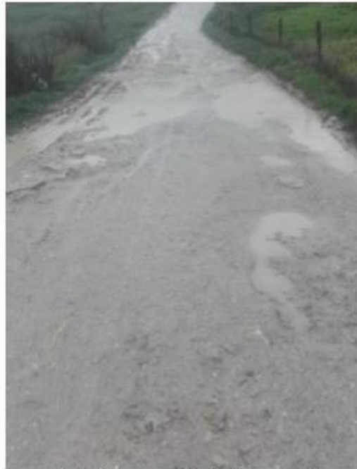
Figura 1. Emposamiento de agua en la vía Lucmacucho – nuevo san juan
