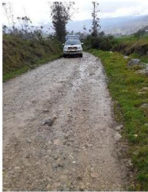
Figura 3. Vista de escorrentía de agua por falta de cunetas.
