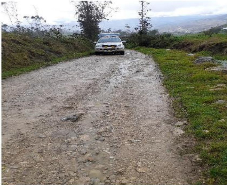
Figura 4. Mal estado de la carretera
