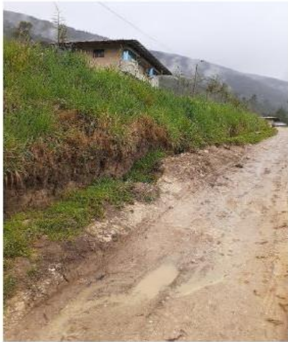
Figura 3 Mal estado de la vía..
