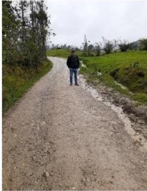
Figura 1. Vista de escorrentia de agua en la carretera.
