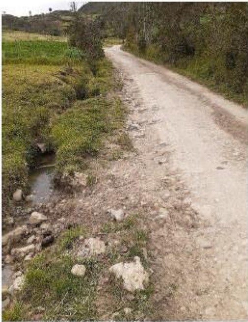
Figura 4. El agua estancada por falta de aliviaderos
