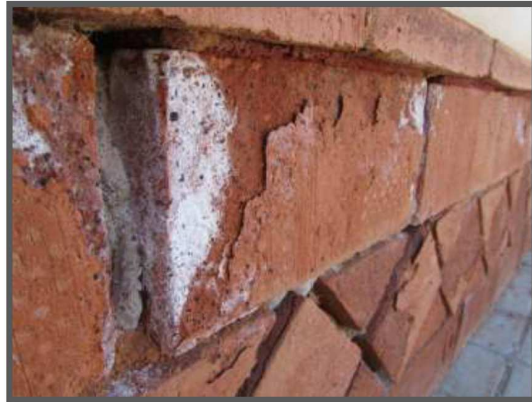
Figura 25 Eflorescencia en ladrillos (Fuente, Chapman P.)
