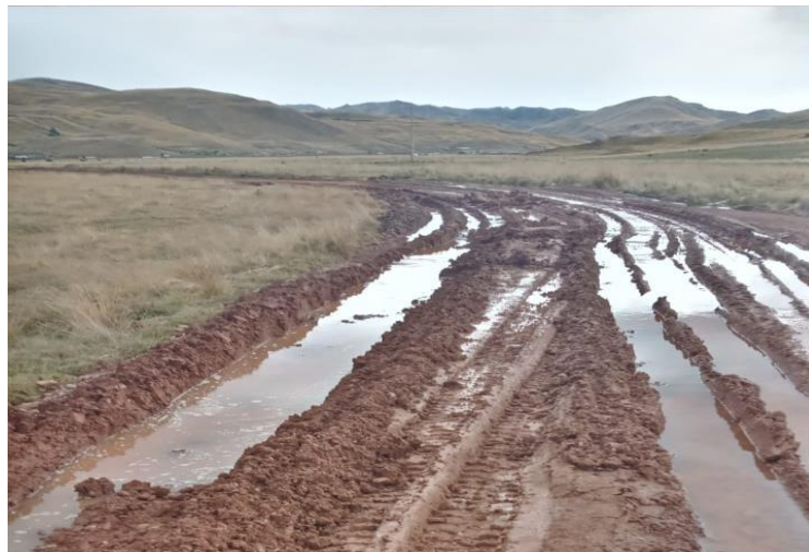
Figura 1. Camino vecinal en mal estado
