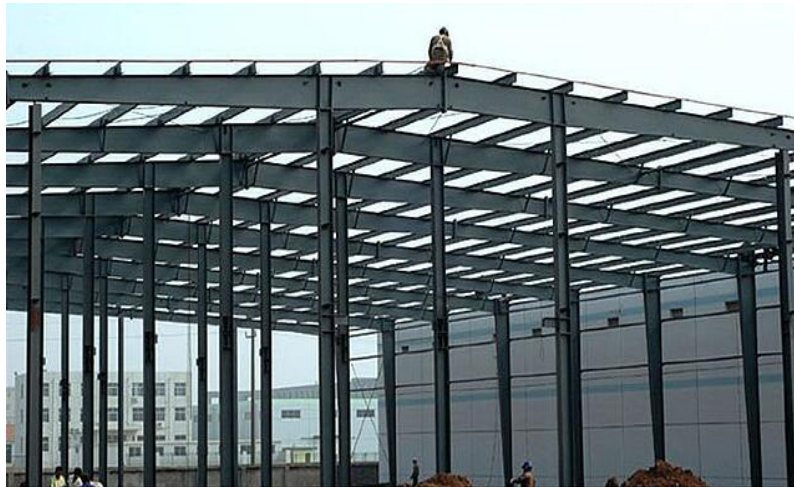
Figura 20: Columnas de Acero. Fuente: Laminas y Aceros.
