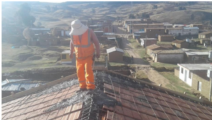
Anexo 14: Se denota el vaciado de concreto en losa aligerada del segundo nivel con el espesor de 5cm
