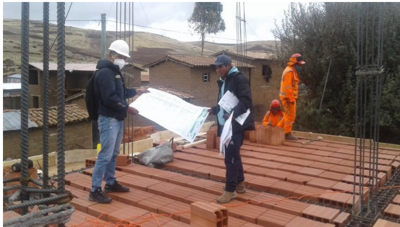
Anexo 08: Se denota al supervisor, verificando la parte de losa aligerada que esté de acuerdo al plano.
