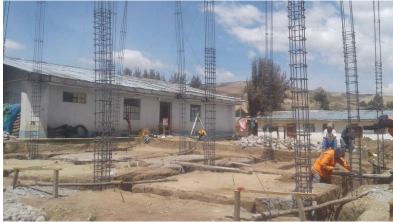
Anexo 04: En la imagen se denota la nivelación vertical de la armadura de acero para columnas, para luego hacer el vaciado de zapatas.
