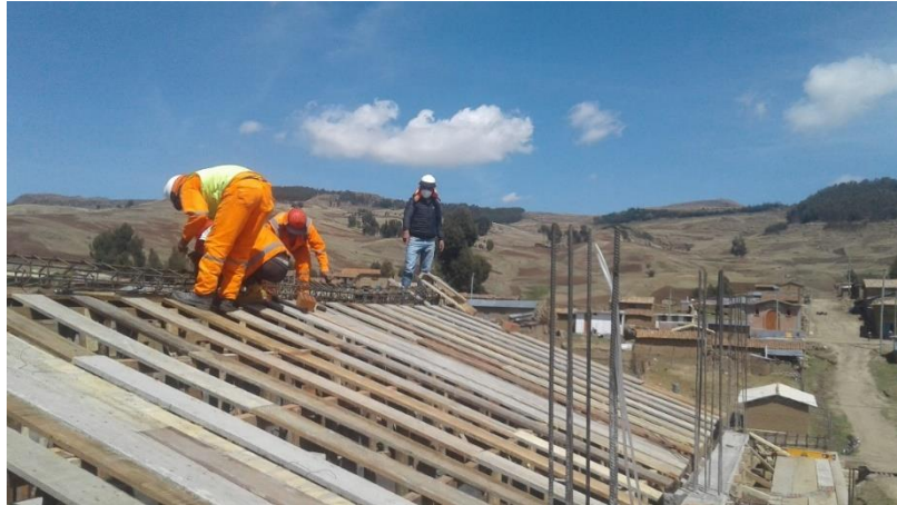
Anexo 13: Se denota el encofrado para losa aligerada del segundo nivel y el armado de acero para la viga cumbre.
