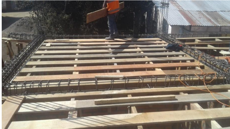
Anexo 07: En la imagen se denota, el encofrado para la losa aligerada del primer nivel.
