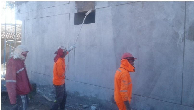
Anexo 17: Se denota la aplicación del pegamento SEKA para luego aplicar imprimante.
