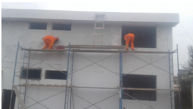
Anexo 18: Se denota la aplicación del imprimante, siguiendo con el proceso para aplicar la pintura.
