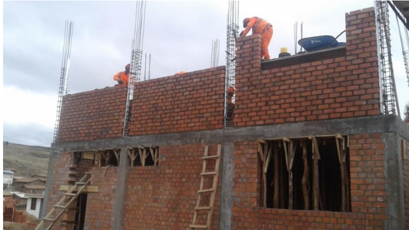
Anexo 10: Se denota el asentado de ladrillo en muros del segundo nivel con el espesor de 15cm.
