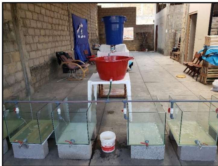
Figura 16: Vista frontal del sistema de biofiltro Fuente: Elaborado por los autores.
