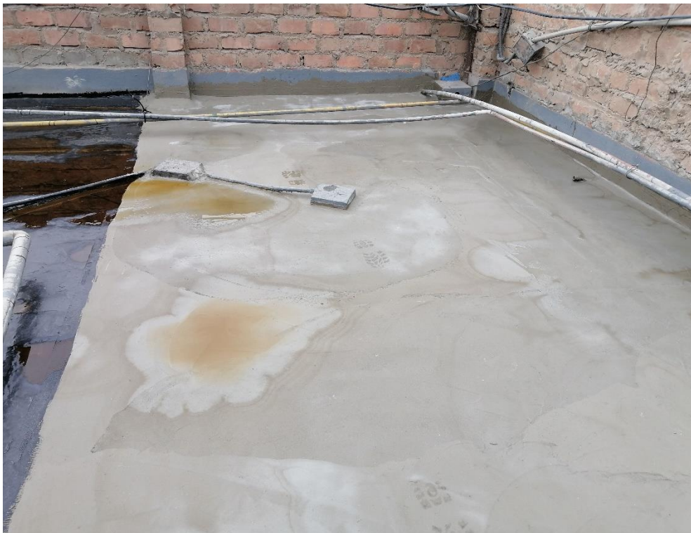
Foto N° 44: Se logró visualizar áreas donde se han acumulado el agua producto de lloviznas en zona de donde se aplicó la malla de fibra de vidrio con el mortero cementoso, la cual se fue a inspeccionar al interior y verificando que no había ninguna filtración.
