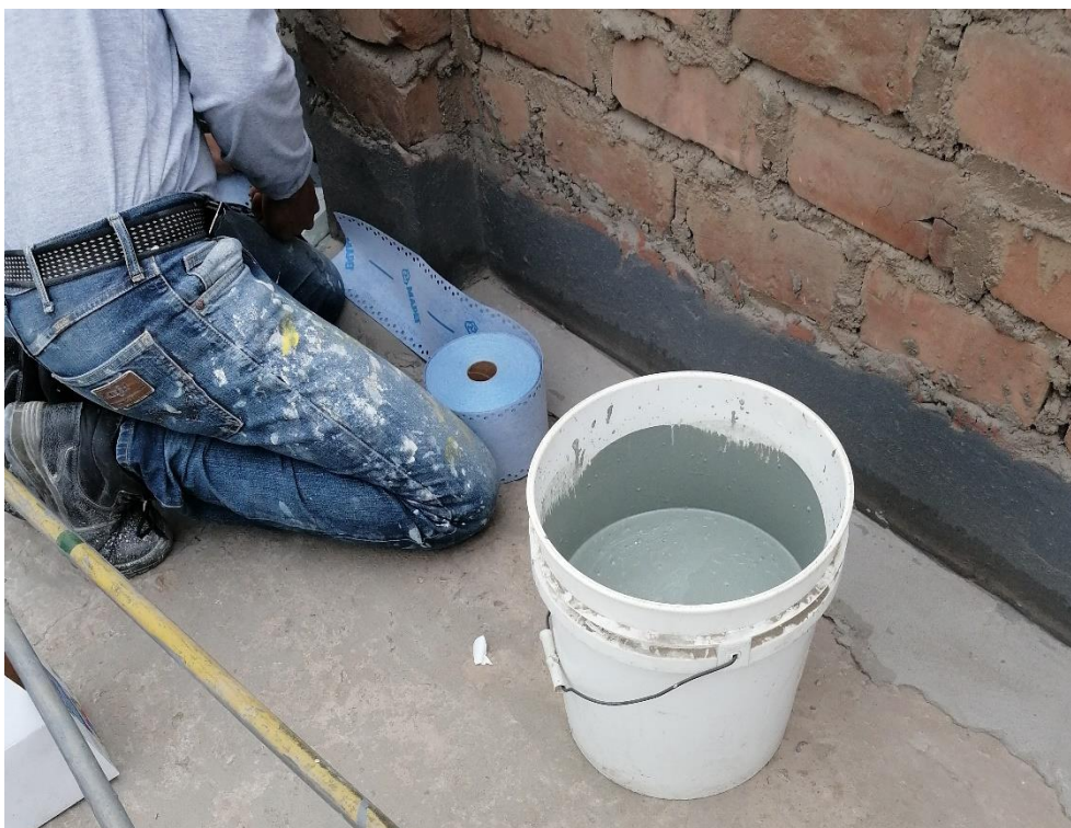
Foto N° 22: Se empezó la impermeabilización de la zona de la malla de fibra de vidrio con la aplicación del rollo de mapeband easy en la unión entre la losa aligerada y el muro.
