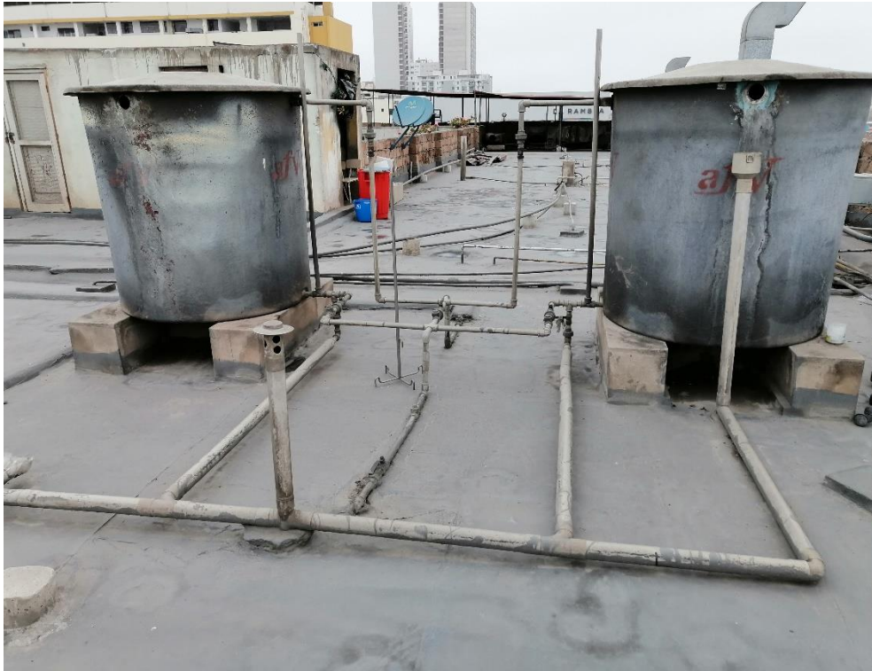
Foto N° 7: Vista de los tanques elevados con sus tuberías en el área designada.
