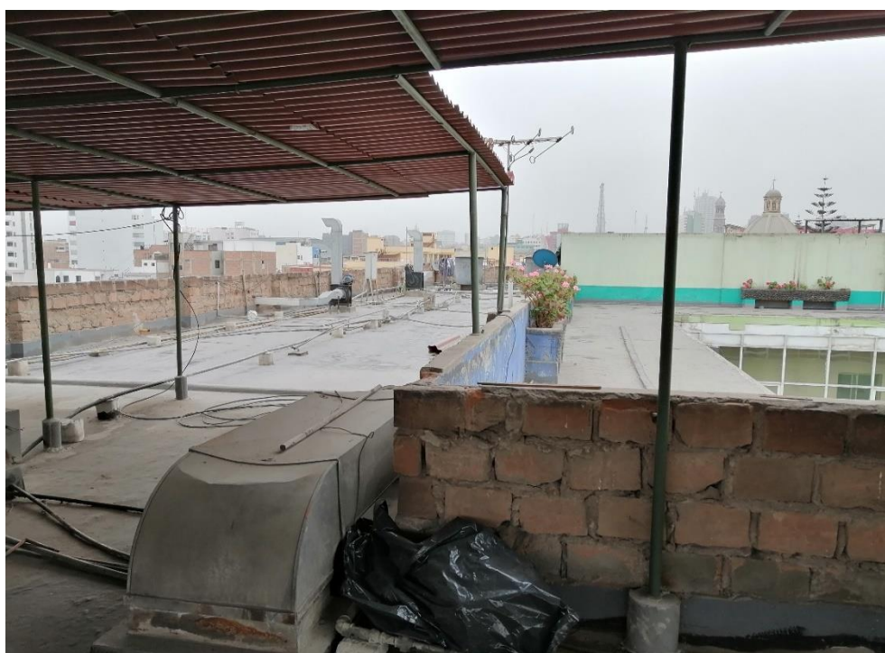
Foto N° 2: Vista del techo del pabellón 1 del Instituto Nacional del Niño donde se observa el uso de calamina para evitar las filtraciones ocasionadas por las lluvias.
