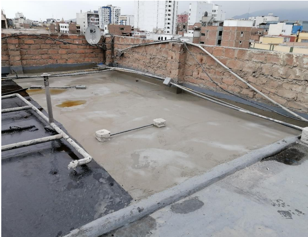
Foto N° 43: Se logró visualizar áreas donde se han acumulado el agua producto de lloviznas en zona de donde se aplicó la malla de fibra de vidrio con el mortero cementoso.
