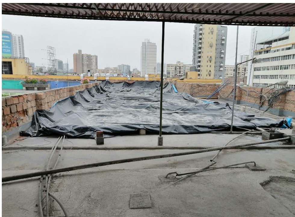
Foto N° 1: Vista del techo del pabellón 1 del Instituto Nacional del Niño donde se observa el uso de un plástico impermeable para evitar las filtraciones ocasionadas por las lluvias.
