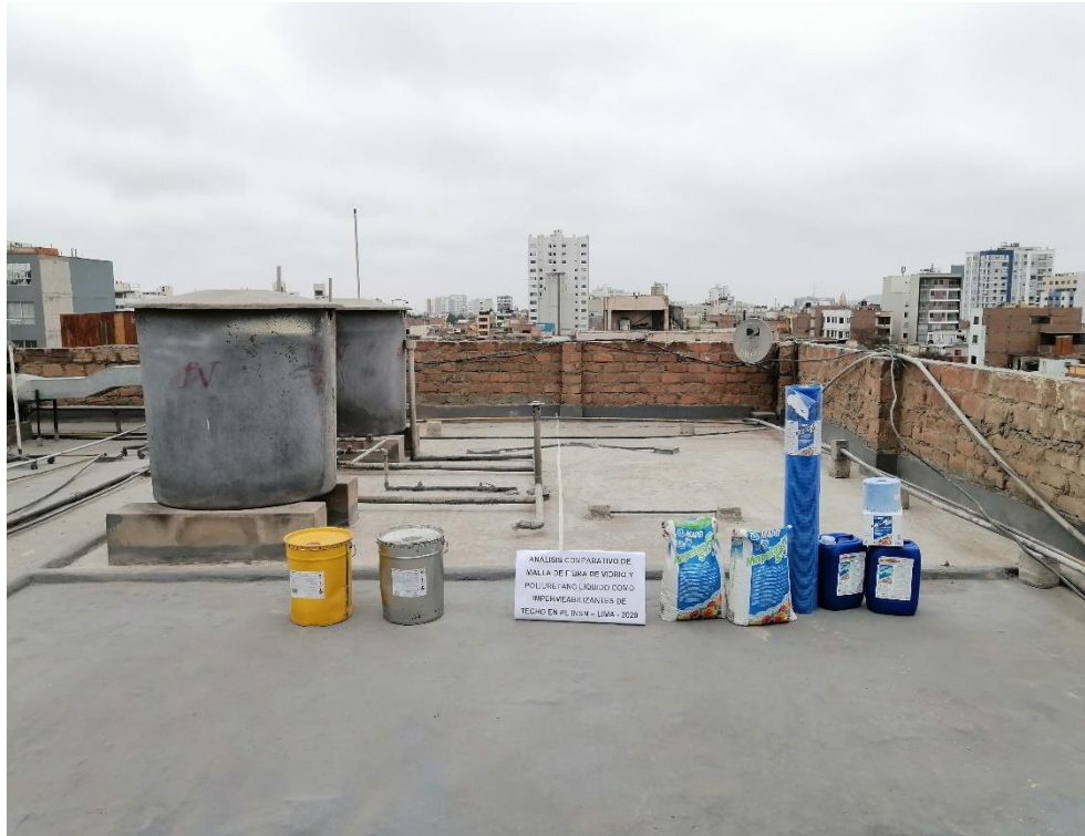
Foto N° 11: Vista general de las áreas delimitadas con los productos respectivos para la impermeabilización de cada área.
