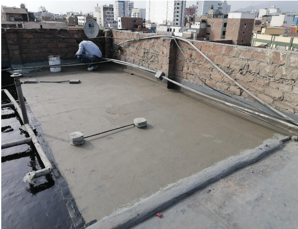
Foto N° 37: Vista de la impermeabilización de la segunda capa de la malla de fibra de vidrio Mapenet 150 con el mortero cementoso mapelastic Smart en el encuentro entre la losa y el muro.
