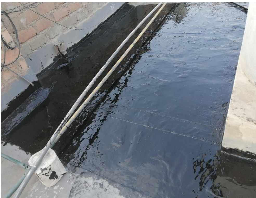
Foto N° 34: Vista específica del acabado de la impermeabilización de la segunda capa del poliuretano líquido Hyperdesmo.
