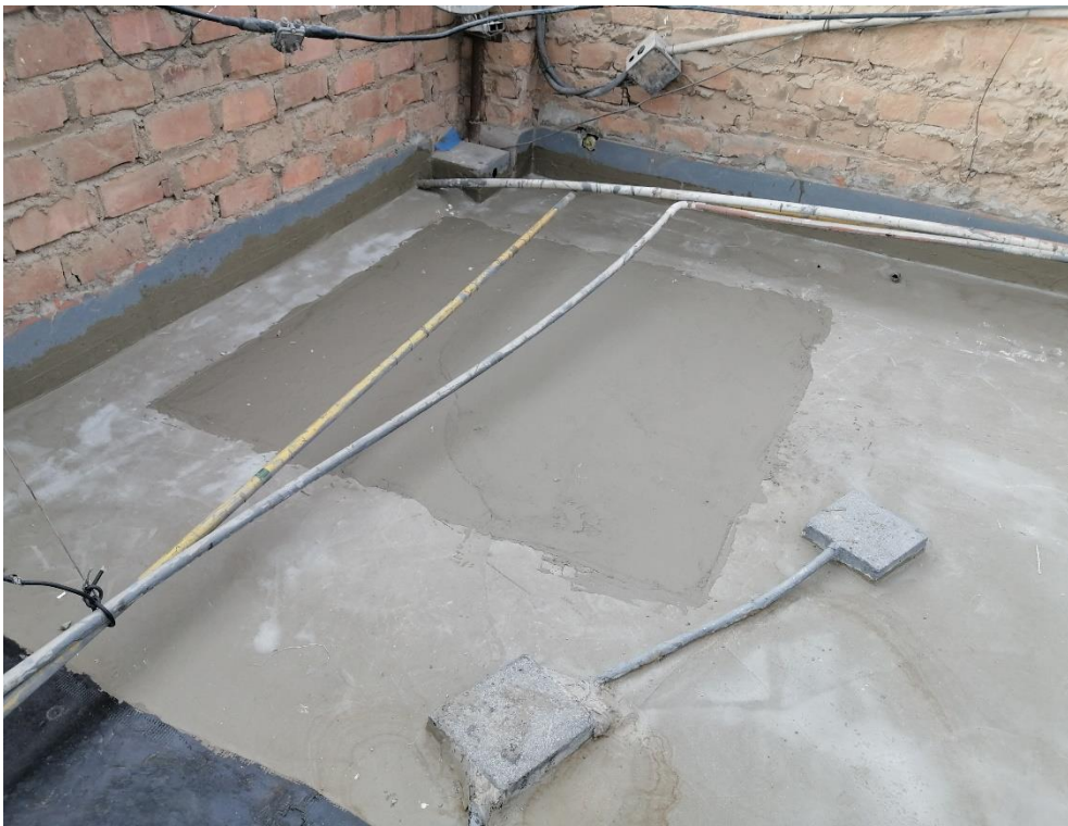
Foto N° 48: Se logró volver a aplicar el mismo material el cual se ha extraído y verificar de cubrir el área completa la cual se extrajo.
