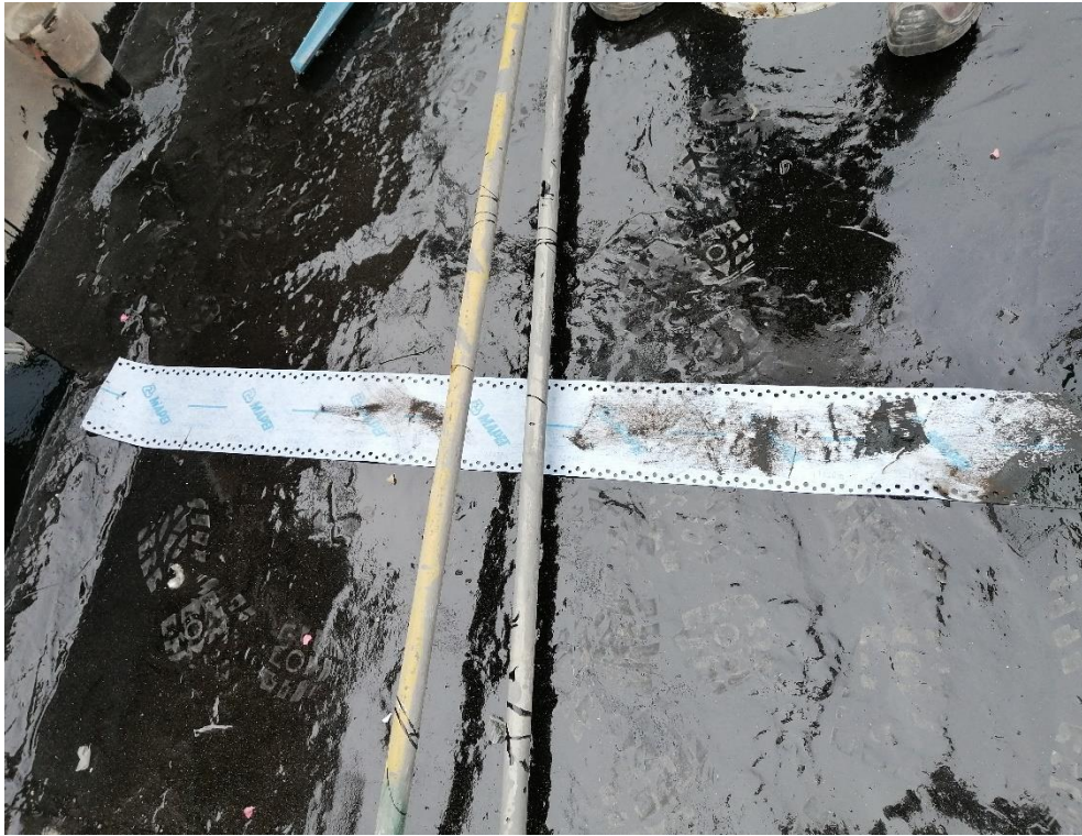
Foto N° 29: Se colocó a manera de refuerzo la cinta mapeband easy en la zona donde se observó una fisuración en la losa aligerada a manera de refuerzo.
