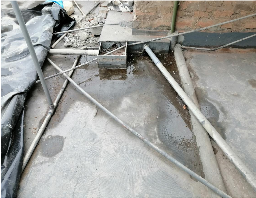
Foto N° 3: Vista del estado situacional del techo en donde se observa el empozamiento de agua producto de las lluvias, lo cual ocasiona las filtraciones.
