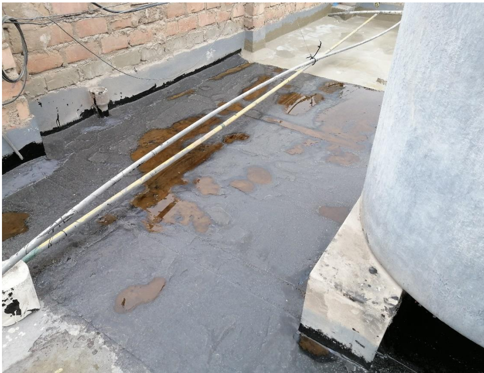
Foto N° 42: Se logró visualizar áreas donde se han acumulado el agua producto de lloviznas.
