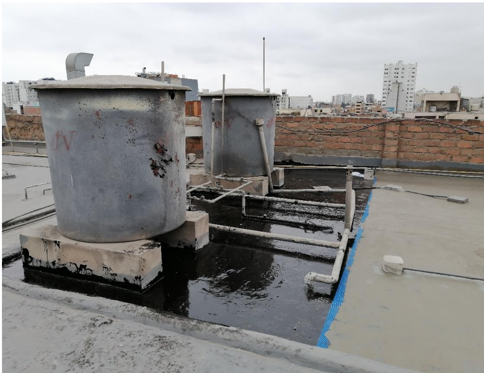
Foto N° 28: Vista general de concluida la aplicación de la primera capa del poliuretano líquido Hyperdesmo.
