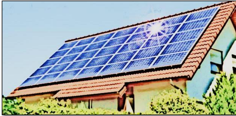
Figura 11: Paneles solares. Recuperado de: https://diarioms.com.br/energia-solar-fotovoltaica-atinge-
