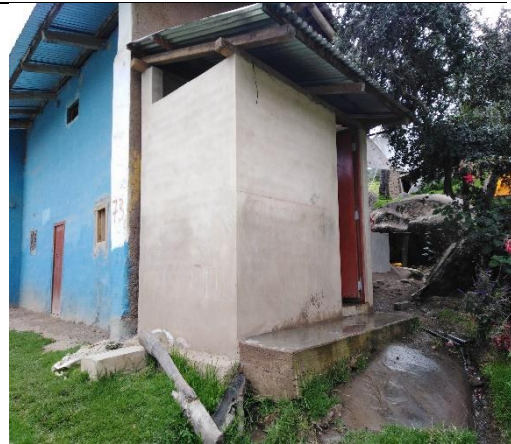
Foto N 02: Servicio higiénico con sistema biodigestor ubicado en el Centro Poblado Nitisuyo Bajo.
