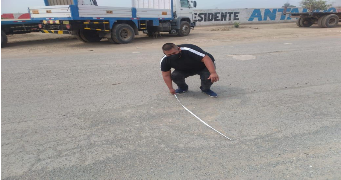
Imagen 12: Falla tipo piel de cocodrilo y bache km 03+100
