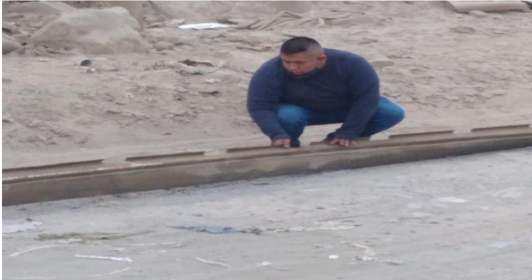
Imagen 7: Falla tipo desnivel km 01+750
