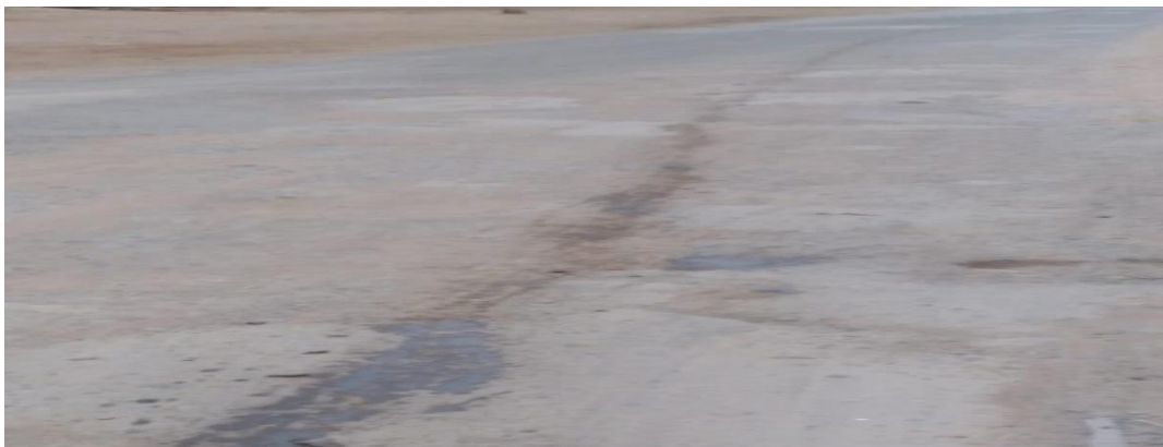
Imagen 5: Falla tipo grieta km 01+200
