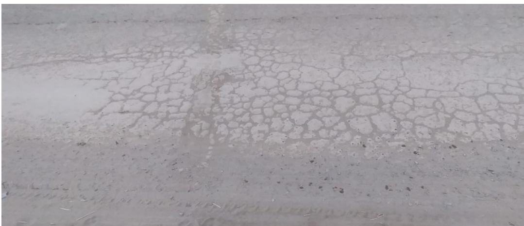
Imagen 2: Falla piel de cocodrilo KM 00+400
