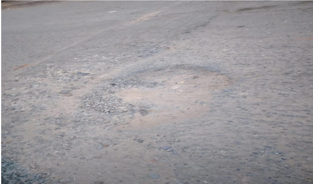
Imagen 3: Falla por bache km 00+680
