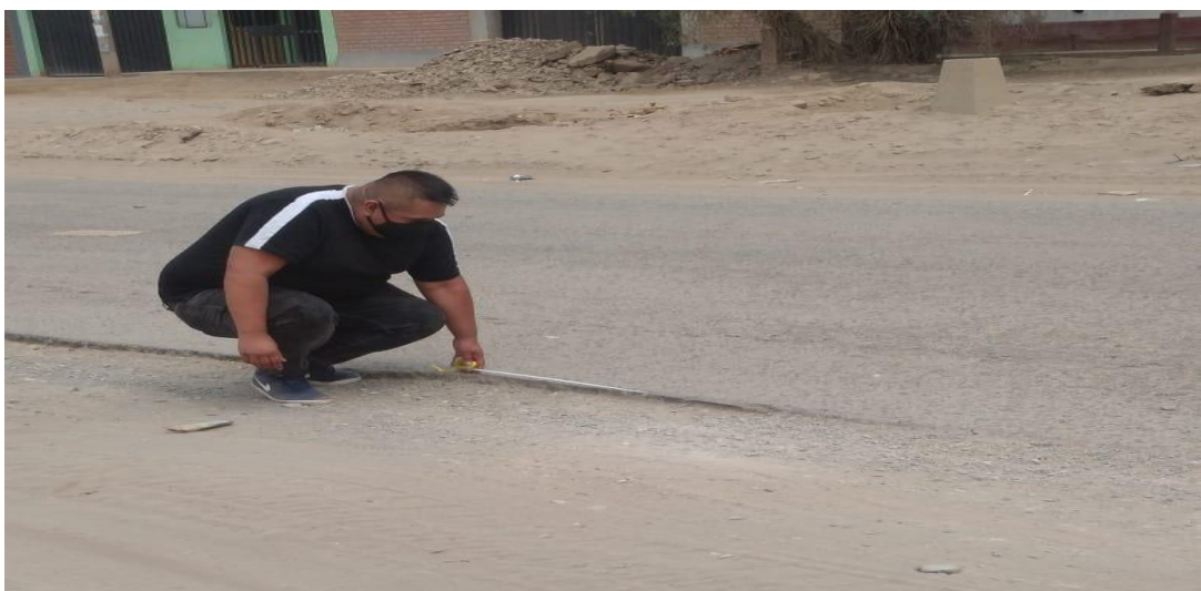
Imagen 13: Falla tipo grieta y bache km 03+380
