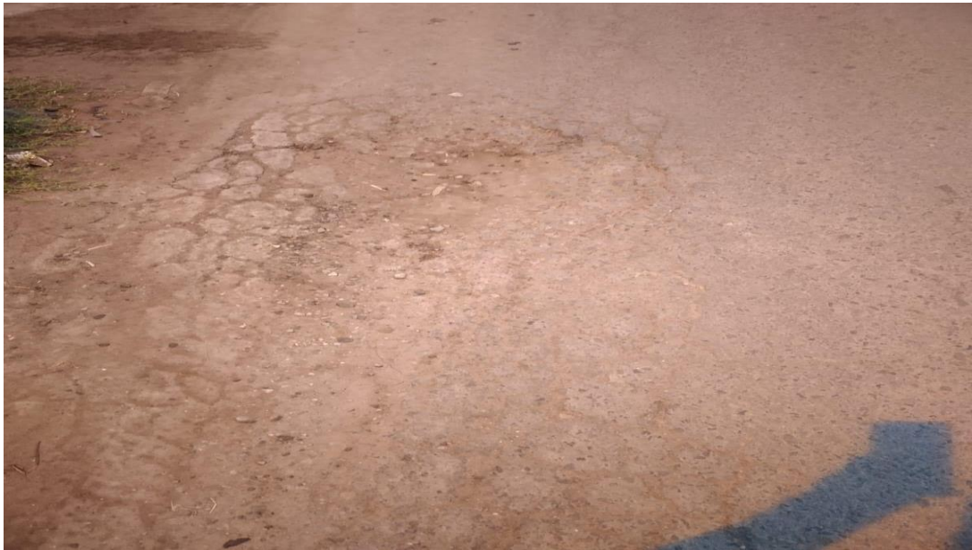
Imagen 4: Falla tipo piel de cocodrilo y bache KM 00+950
