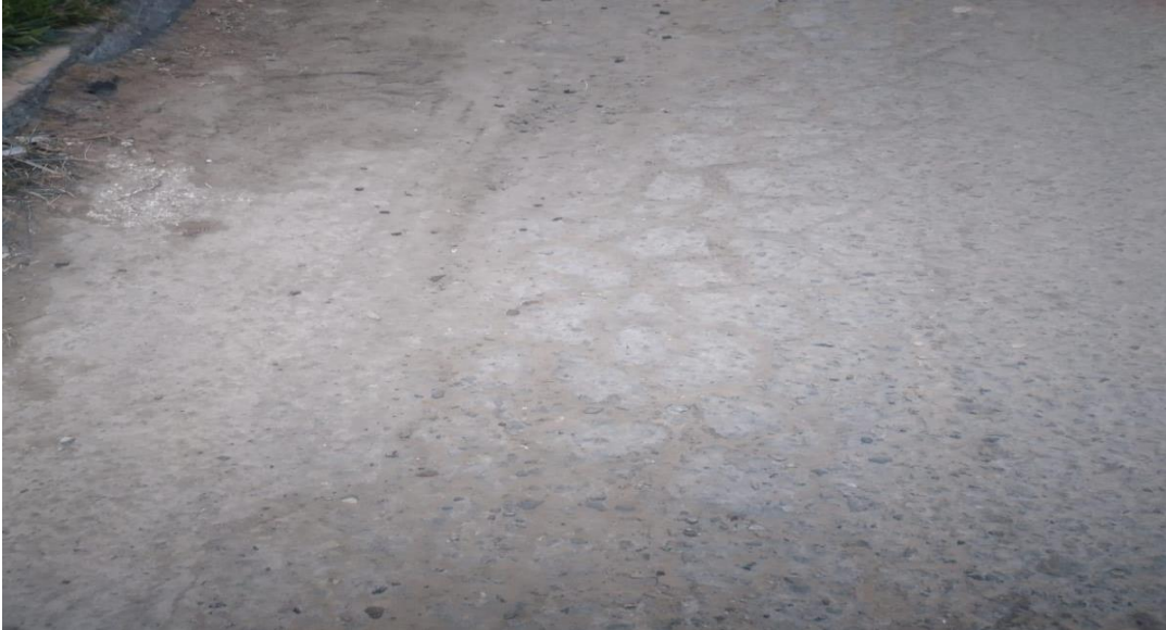
Imagen 1: Falla piel de cocodrilo KM 00+130
