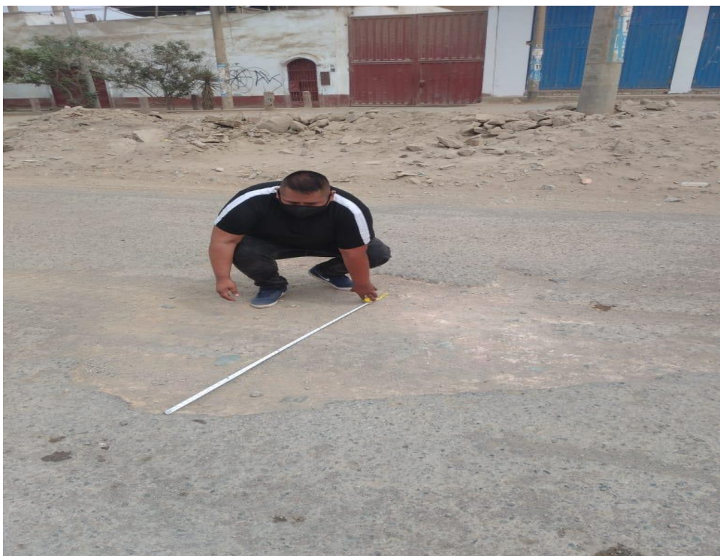
Imagen 14: Falla tipo piel de cocodrilo y bache km 03+650
