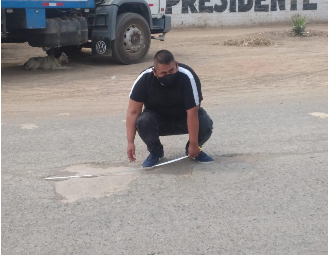
Imagen 10: Falla tipo grieta y bache km 02+570
