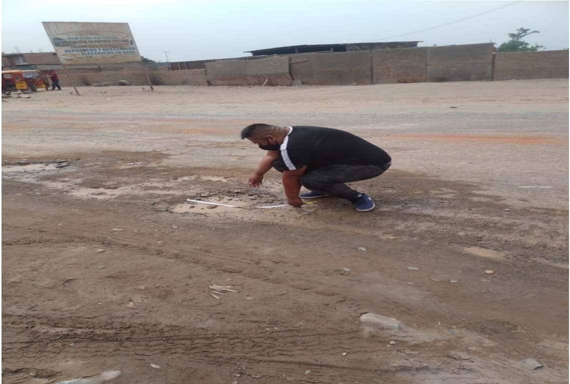
Imagen 11: Falla tipo bache km 02+830
