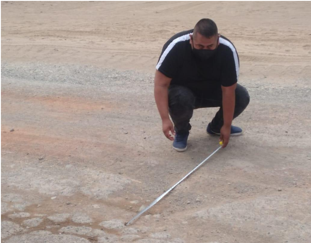
Imagen 9: Falla tipo piel de cocodrilo y bache km 02+300
