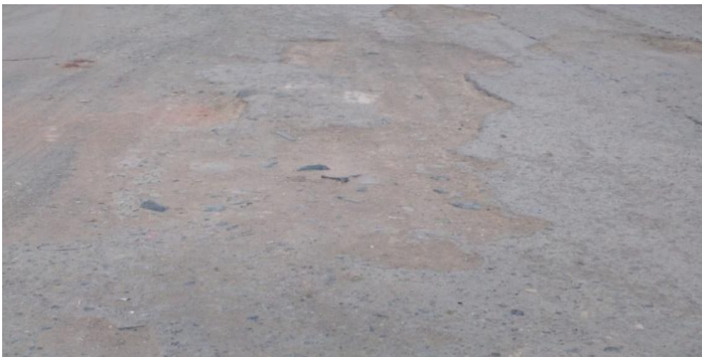
Imagen 8: Falla tipo bache km 02+030
