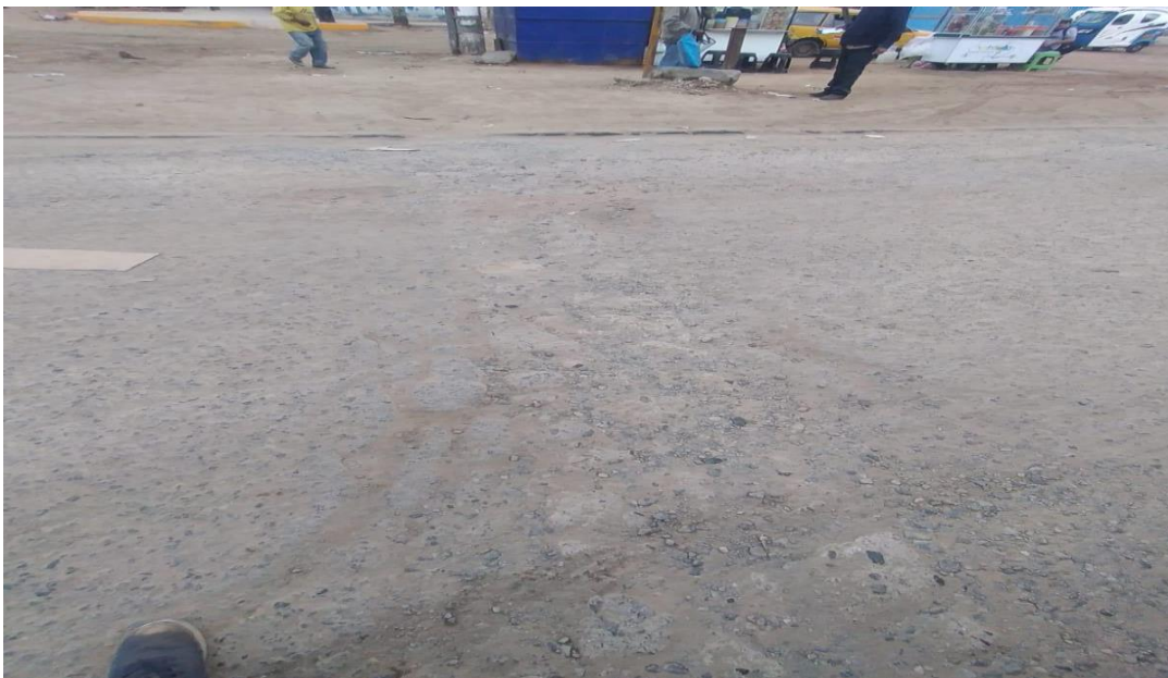
Imagen 6: Falla tipo piel de cocodrilo y grietas km 01+490
