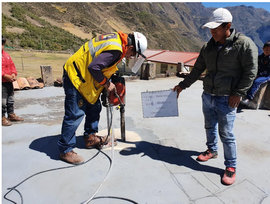
Figura 45: Ensayo de corazones diamantinos en techo D-6 de las Aulas de 3° y 4° grado.
