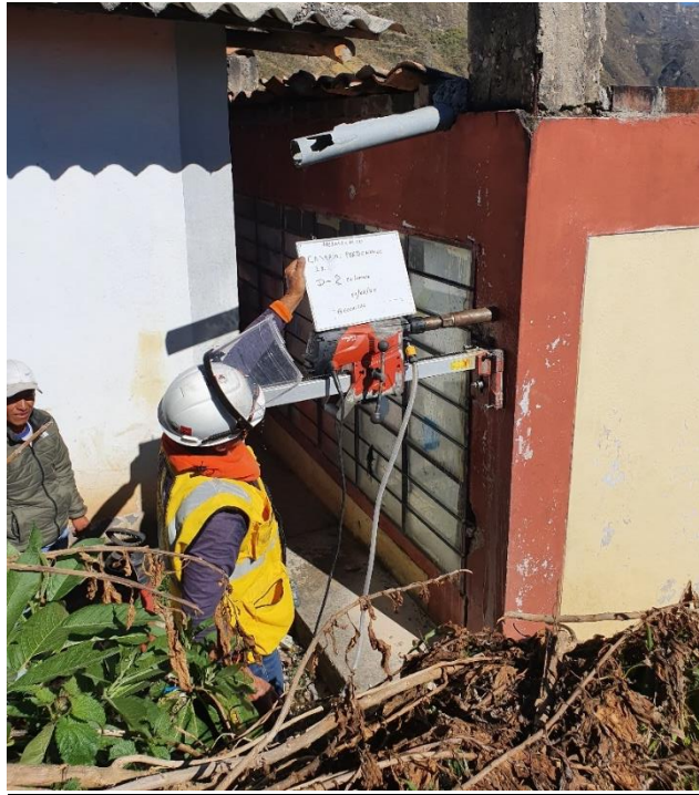
Figura 41: Extracción de muestra en columna esquinada D-2 para el ensayo de corazones diamantinos de las Aulas de 3° y 4° grado
