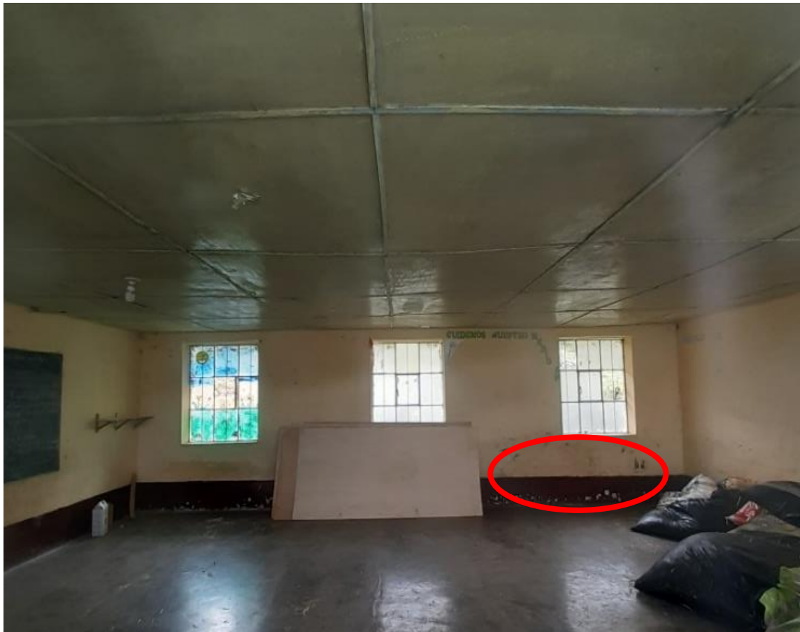
Figura 35: vista interior del Aulas con presencia de humedad en los muros.
