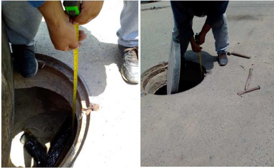
Figura 38. Medición del buzón de descarga 27/10/2020 – 10:20 am
