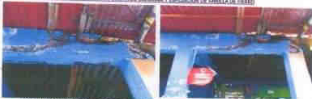
PANEL FOTOGRAFICO: SE OBSERVA EXPOSICION DE VARILLA DE FIERRO
