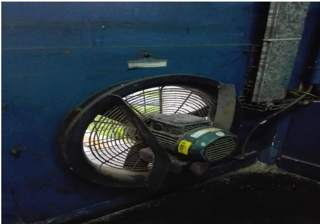
Extractor de aire en caso de fuga de gas.
