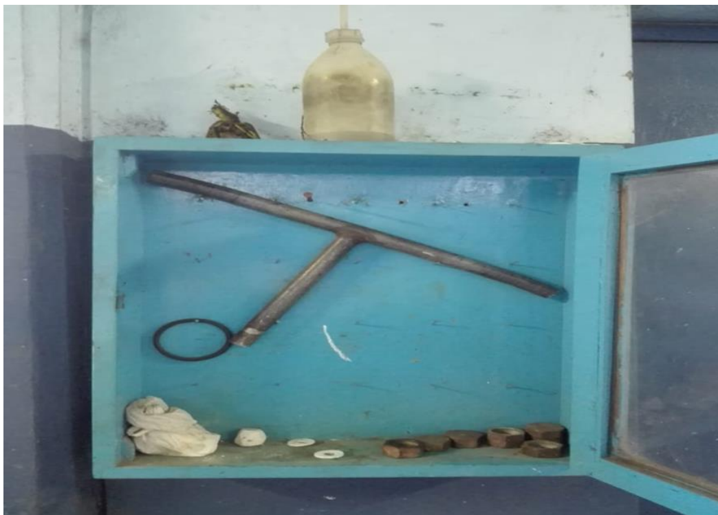
1 Área de cloración –herramientas y materiales para trabajos
