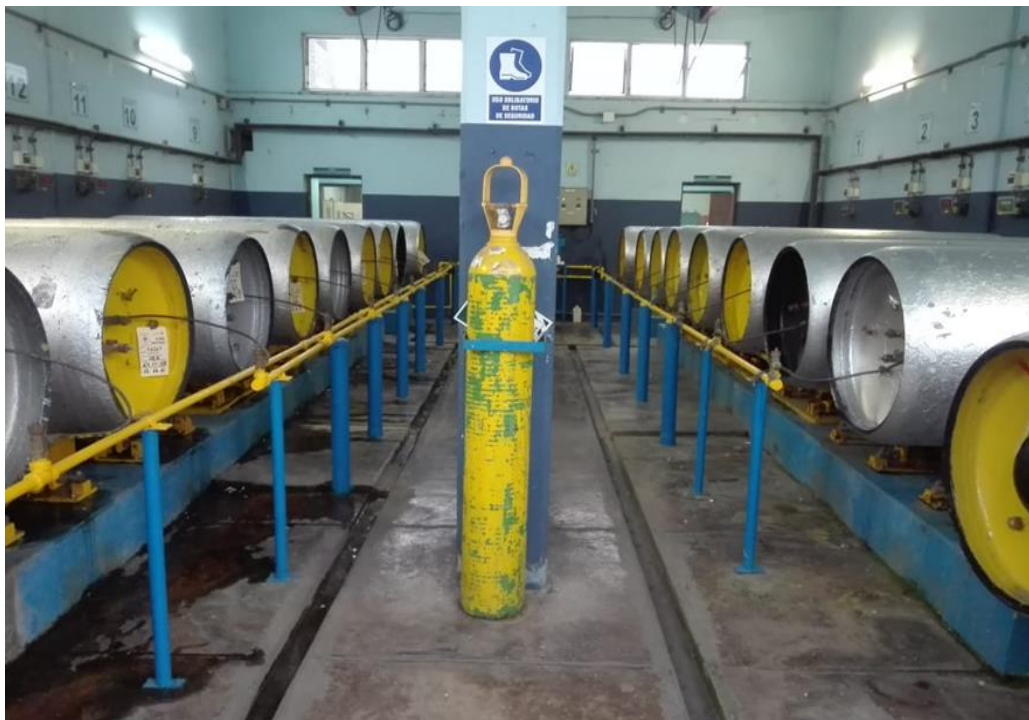
Área de cloración de la planta Nro. 2 de la atarjea Sedapal lima 2020
