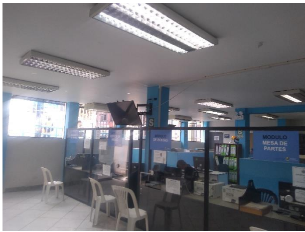
No se encuentra viga peraltadas dentro de semi-sotano
