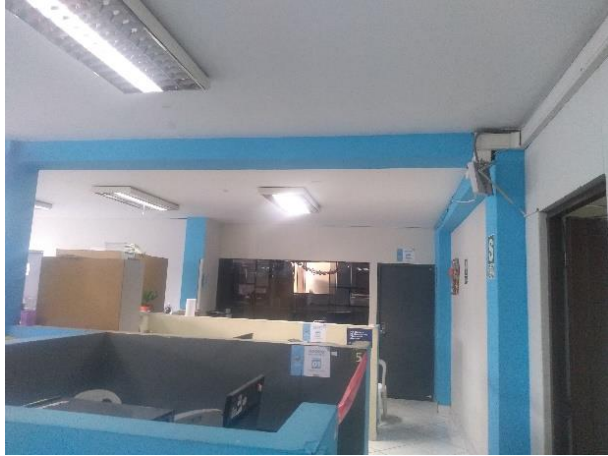
En el Semi-sótano se observa que hay una viga que sobre sale 20cm de la losa
