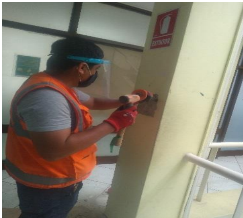
Figura 13. Picado del tarrajeo para poder encontrar el concreto.
