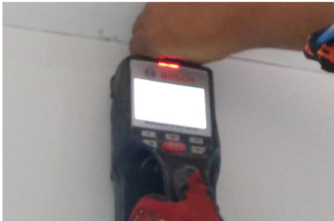
Se realizó el trabajo con el escáner para saber ah que altura hay los fierros existentes.
