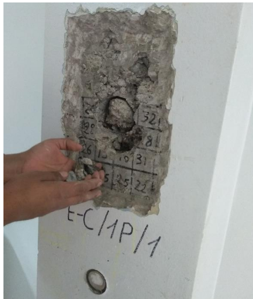
Se tiene que esta columna de las cuales se ve que el concreto está en mal estado el punto D-C/1p-1
