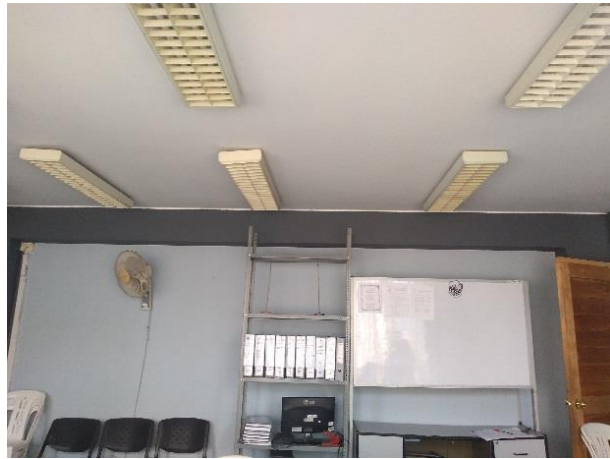
Se encuentra 2 columnas en la sala de Regidores, con un peraltalte alto.
