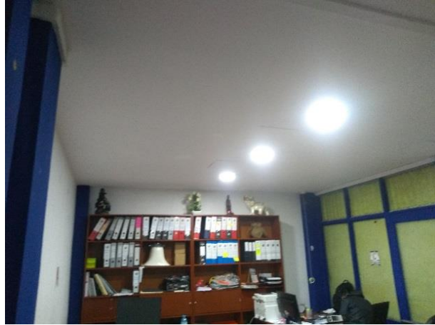
En la Sala de Asesores, igualmente no se observa el elemento estructural de la Viga.
