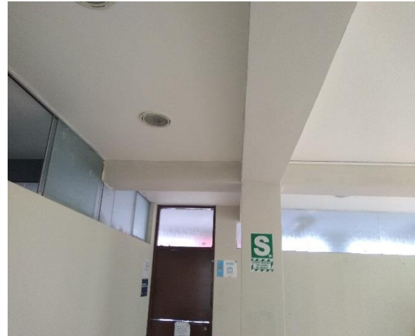
Figura 7. Vigas peraltadas con losa sobresaliente en 22 cm (aprox.) ubicadas en el piso 3 en el área
