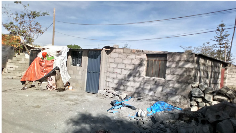
Figura 11: Vivienda de silla
