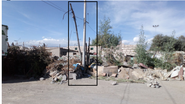
Figura 23: Poste de alumbrado eléctrico inclinado
