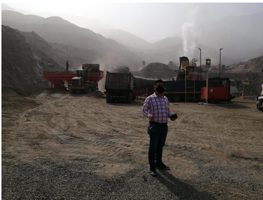
Figura 17. Planta de elaboración de mezcla asfáltica.
