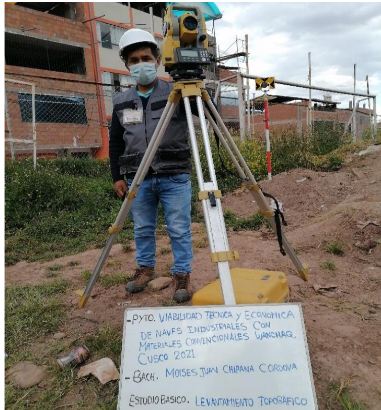
Figura 16.4 Se puede apreciar el equipo topográfico ya instalado para empezar con los trabajos de levantamiento topográfico. Fuente: propia
