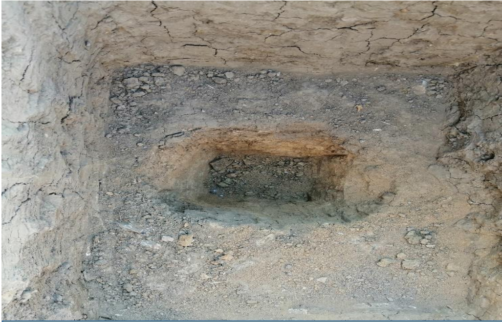
Foto N° 09. Excavación de Calicata para realizar el Test de percolación en el caserío de Cangrejera
