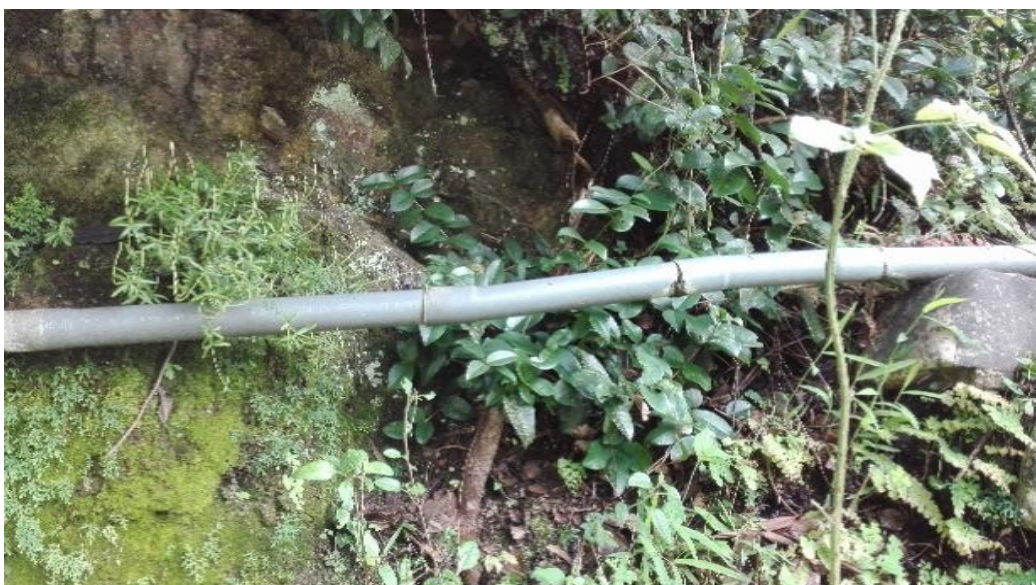
Figura 02. Línea de conducción expuesta del sistema de agua del caserío Cangrejera (Fuente propia)
