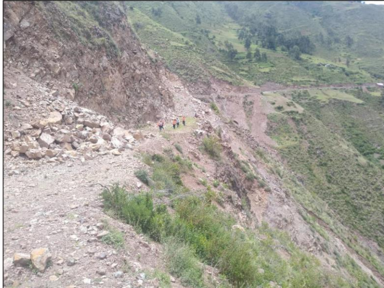
Figura 6: Vista de deslizamientos en el talud Km. 33+670 al Km. 33+880.
