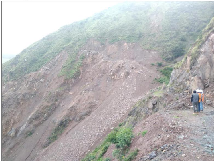
Figura 7: Vista de deslizamientos en el talud Km. 33+670 al Km. 33+880.
