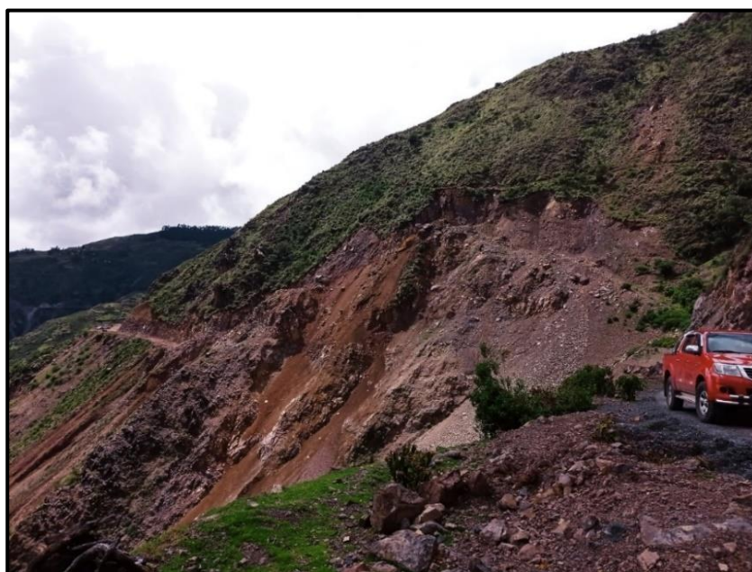
Figura 1. Vista panorámica de la inestabilidad de talud – Mayhuaccacca.
