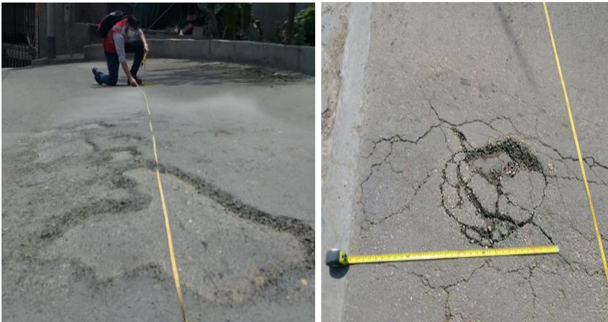
Figura 78: Desprendimiento de agregados nivel alto y hueco nivel bajo
