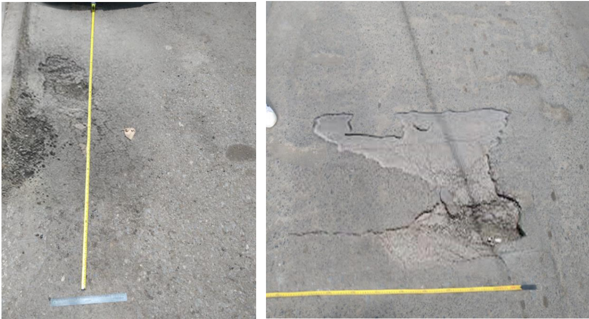
Figura 77: Desprendimiento de agregados de nivel bajo y medio
