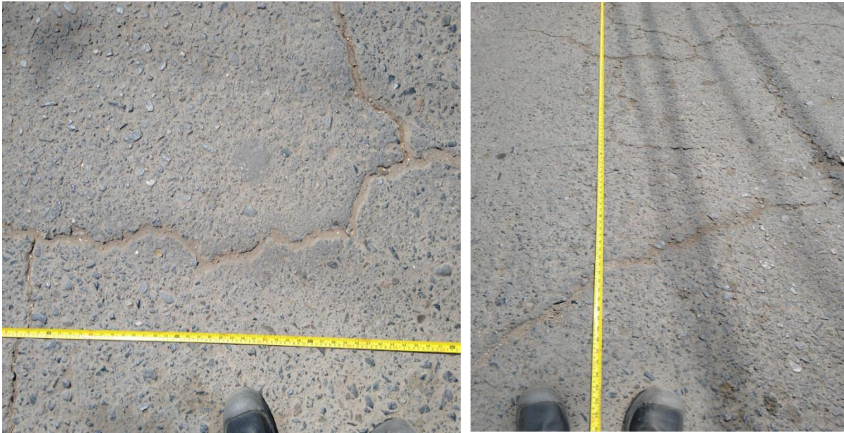
Figura 73: Fisuras longitudinales y transversales de nivel bajo y medio
