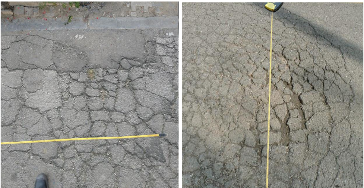
Figura 76: Fisuras piel de cocodrilo nivel alto
