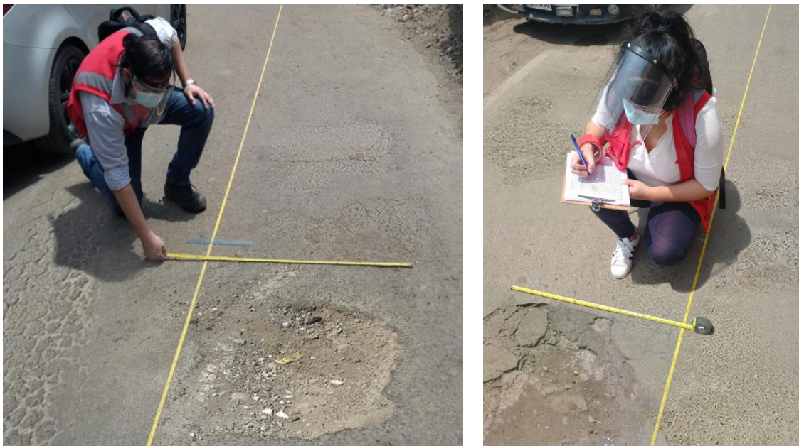
Figura 71: Identificación y medición de patologías
