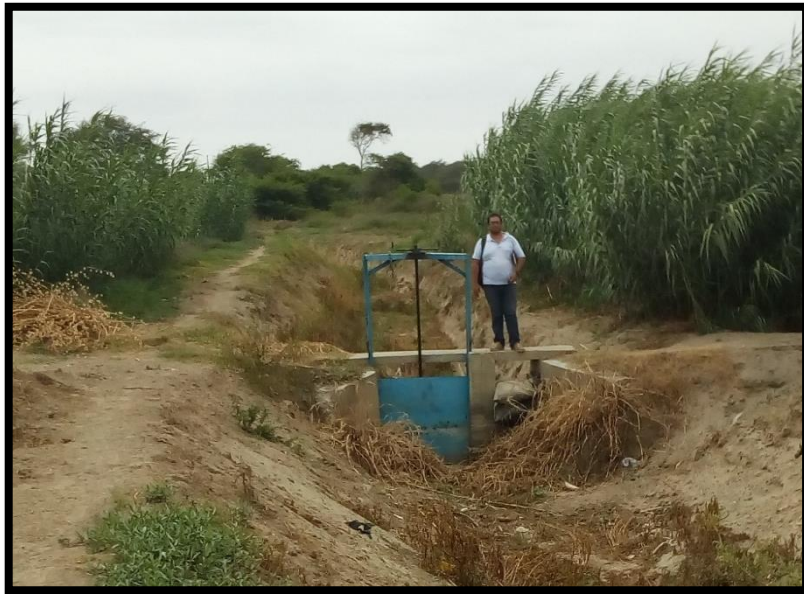
Foto N° 1. Canal Angolo sin revestir, presencia de malezas dentro del canal
