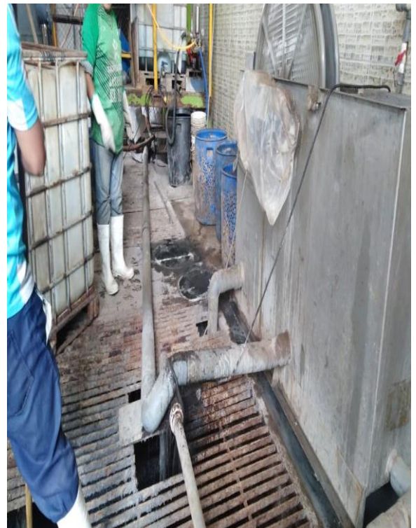
Figura 10. Descarga de efluentes de remojo
