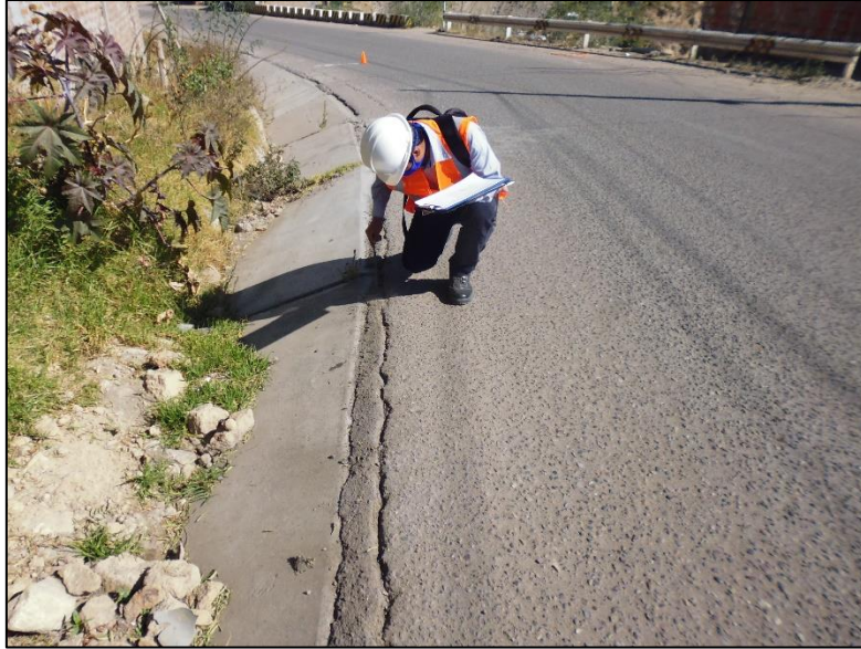
EVALUACIÓN DE FALLA GRIETAS DE BORDE
