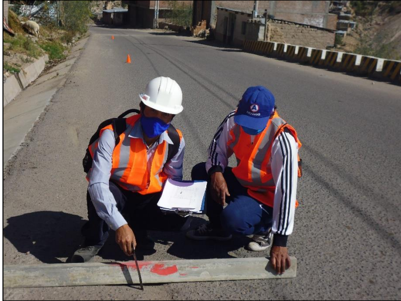
EVALUACIÓN DE FALLA DESPRENDIMIENTO DE AGREGADOS
