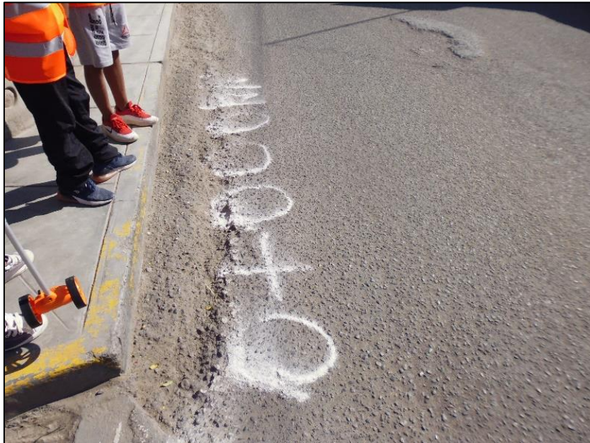
EVALUACIÓN DE FALLA DESPRENDIMIENTO DE AGREGADOS
