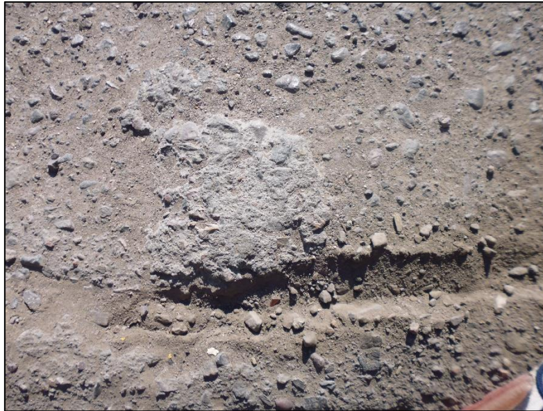
EVALUACIÓN DE FALLA DESGASTE SUPERFICIAL
