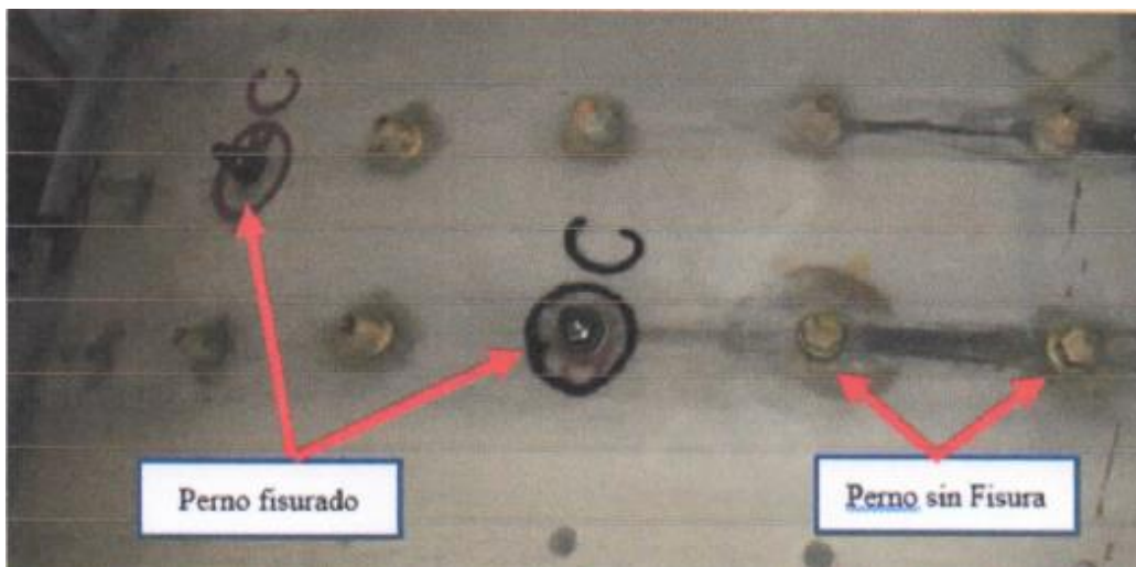
Figura N° 3. Detección de pernos con fisura y sin fisura
