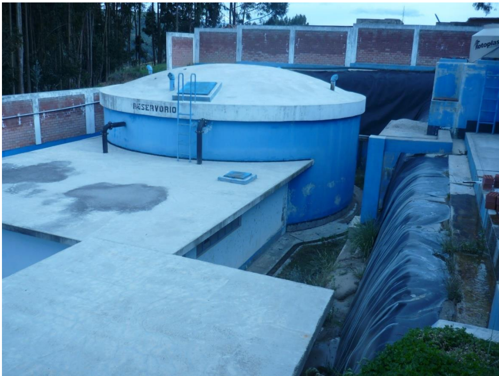
FOTOGRAFÍA N°18: Reservorio de 300m 3
