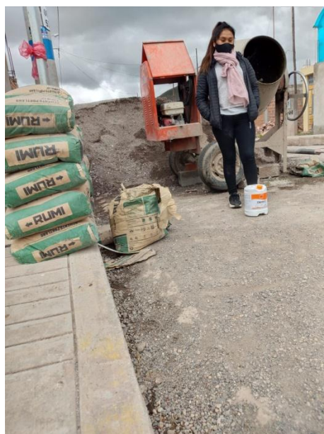
Fotografía N°2 : Se visualiza los materiales con los que se realizaran las briquetas con el aditivo Chema 3
