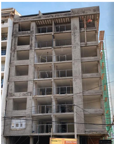
Figura 1 Edificio multifamiliar Torre las Retamas, urb. Larapa se visualiza la construcción de un edificio de 7 niveles con un sótano.
