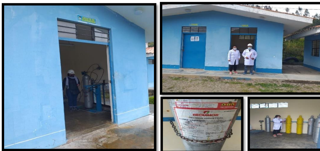
Figura 16. Caseta y equipos de cloración.
