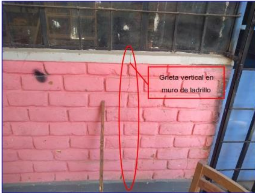
Imagen 31: Grieta vertical en paño de muro
