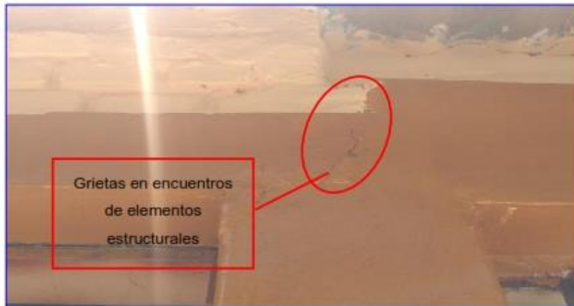
Imagen 11: Grietas en encuentros de miembros estructurales
