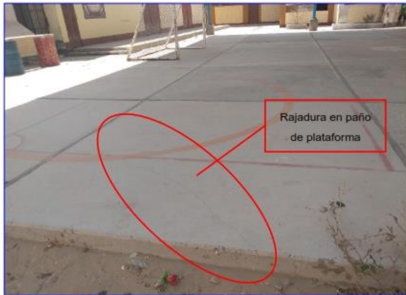
Imagen 48: Rajadura en paño de plataforma deportiva
