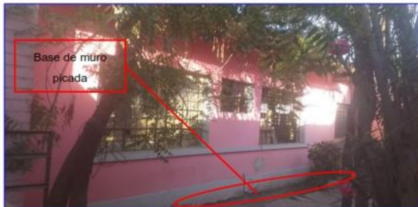
Imagen 25: Base de muro picada.
