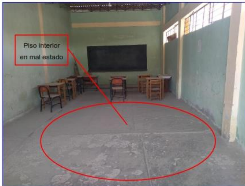
Imagen 55: Piso interior en mal estado.
