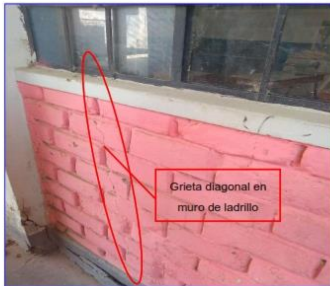
Imagen 30: Grieta diagonal en paño de muro.
