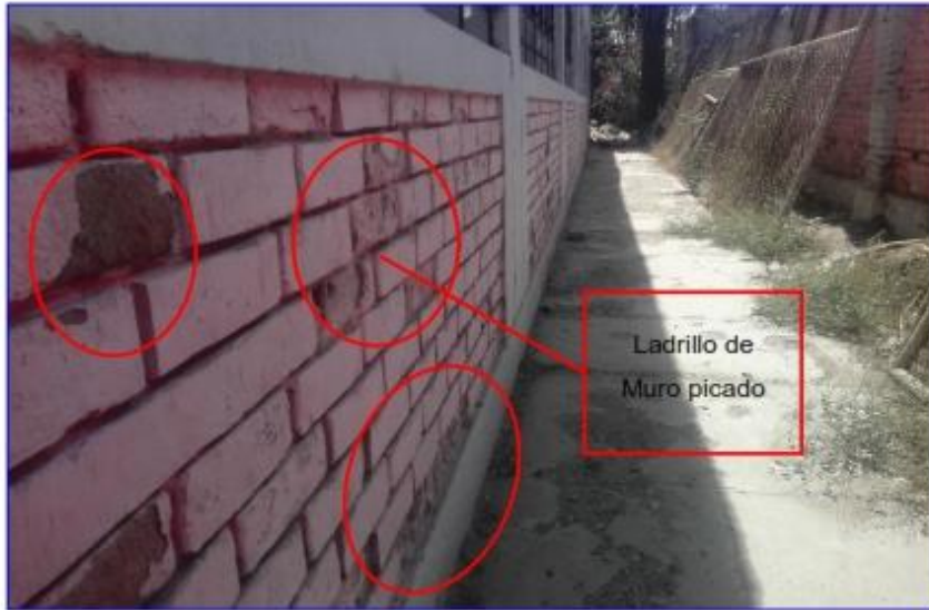
Imagen 14: Vista posterior, se observa el ladrillo del muro picado
