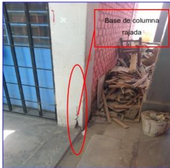
Imagen 35: Base de columna rajada.
