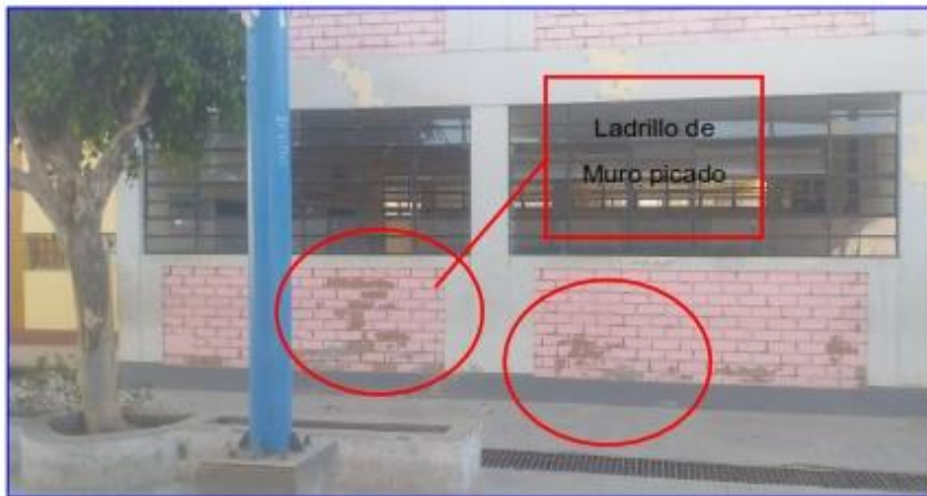
Imagen 15: Vista posterior, se observa el ladrillo del muro picado
