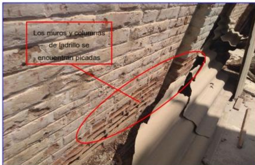
Imagen 63: Muro y columna de ladrillo picados.
