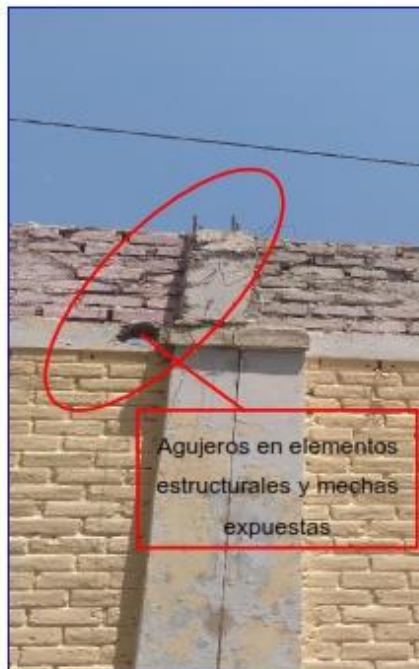
Imagen 65: Agujeros en elementos estructurales.
