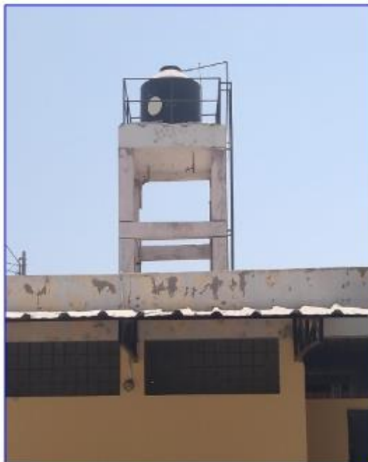
Imagen 59: Tanque elevado de PVC.
