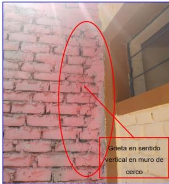
Imagen 66: Grieta vertical en cerco perimétrico.
