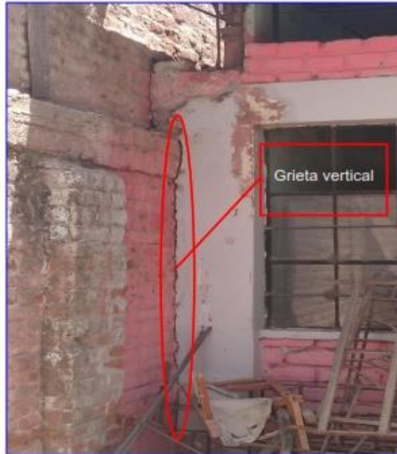
Imagen 29: Ambiente apoyado en cerco sin junta provocando grieta vertical.
