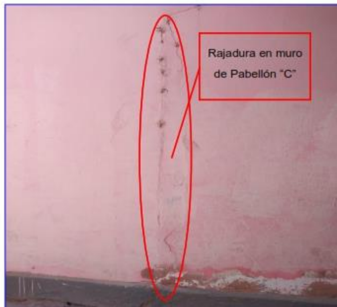
Imagen 23: Rajadura de muros en Pabellón "C"
