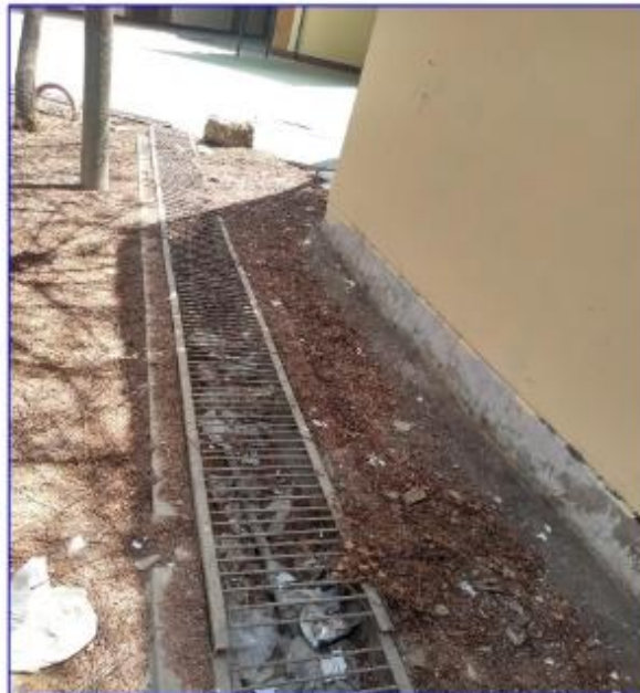
Imagen 73: Cunetas metálicas obstruidas.
