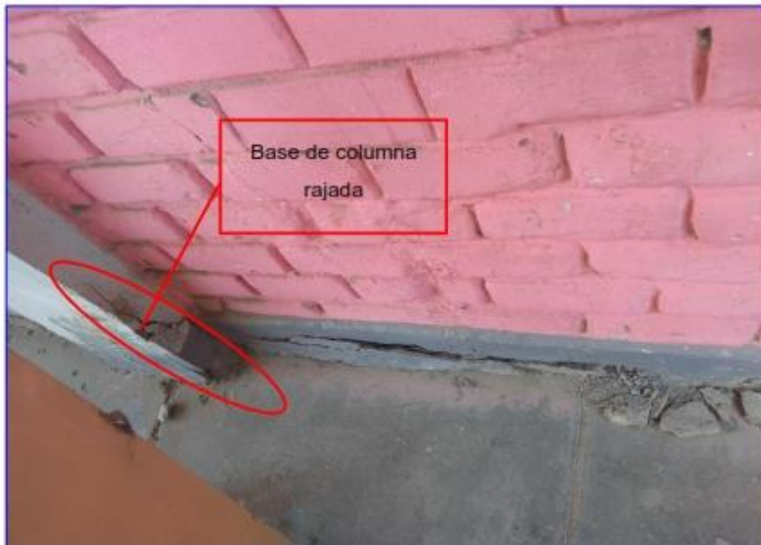
Imagen 34: Base de columna rajada.
