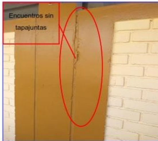
Imagen 16: Encuentros de columnas y columnetas sin tapajuntas
