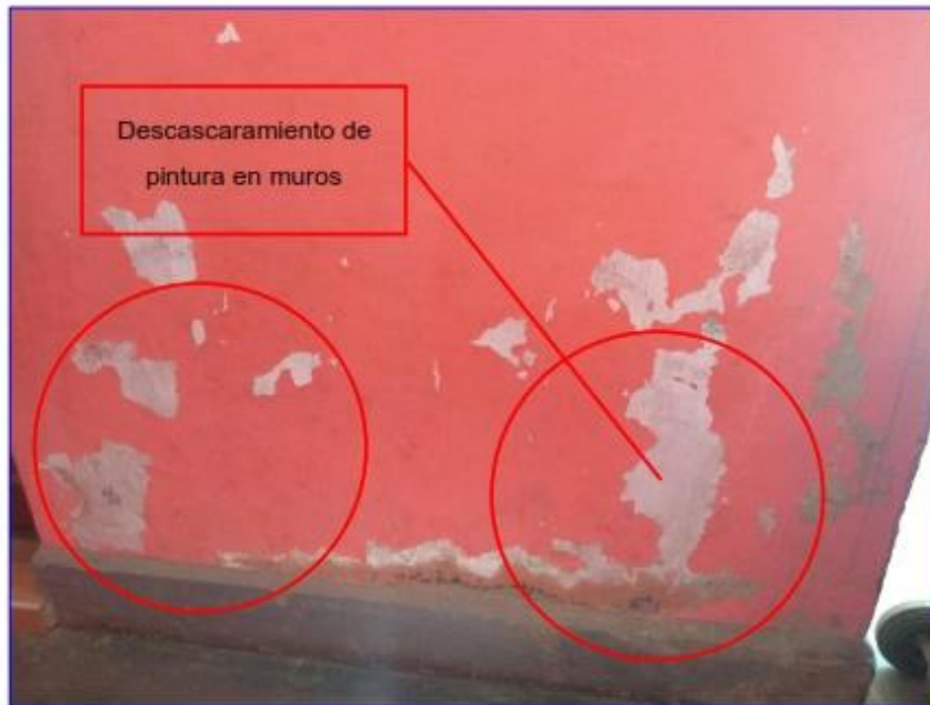
Imagen 22: Descascaramiento de pintura de muros.
