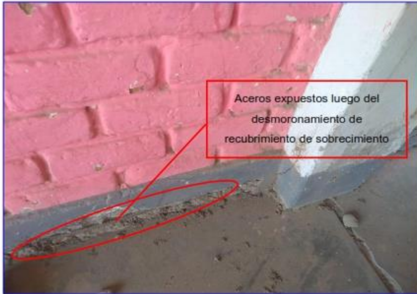
Imagen 33: Aceros expuestos en sobrecimiento.
