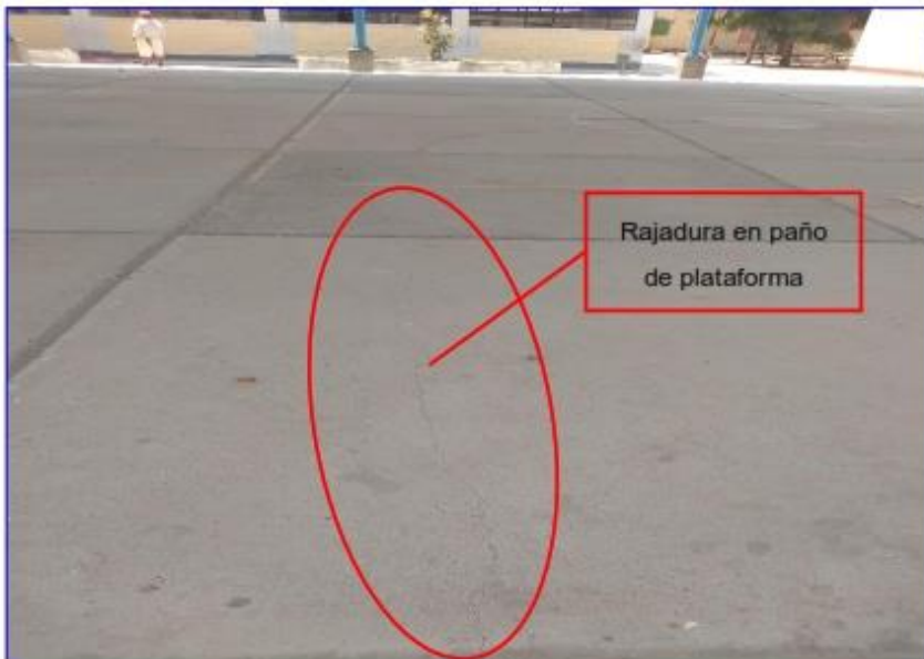
Imagen 47: Rajadura en paño de plataforma.
