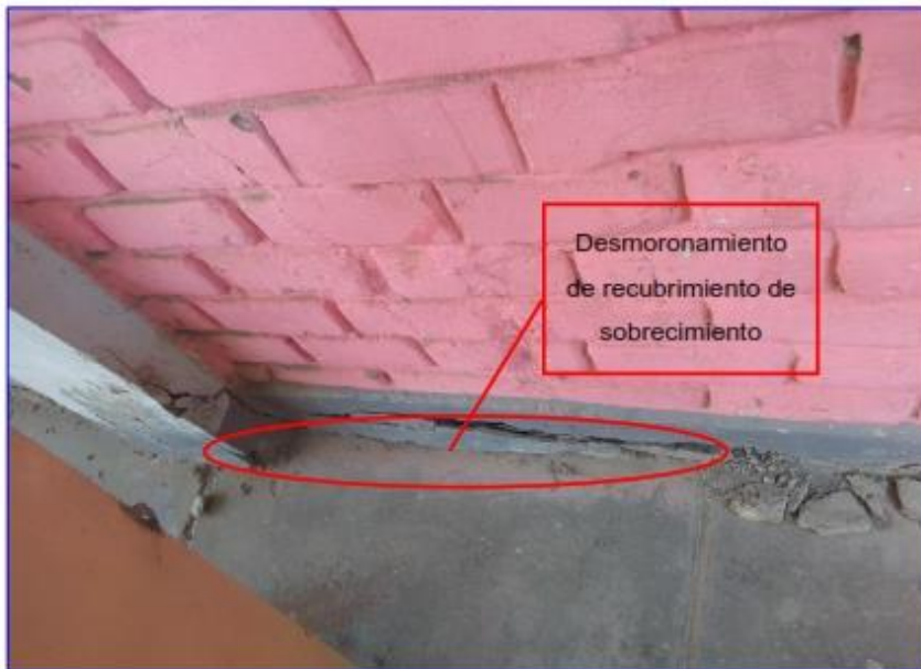
Imagen 32: Desmoronamiento de recubrimiento de sobrecimiento.
