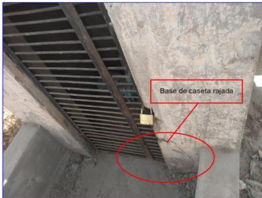
Imagen 57: Base de caseta de válvulas rajada.
