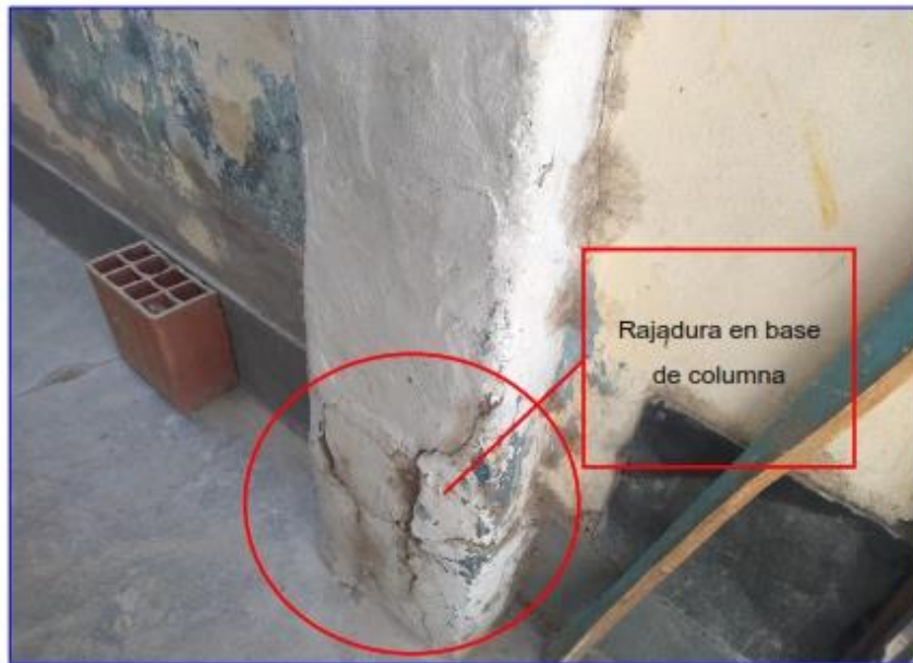
Imagen 39: Rajadura en base de columna.
