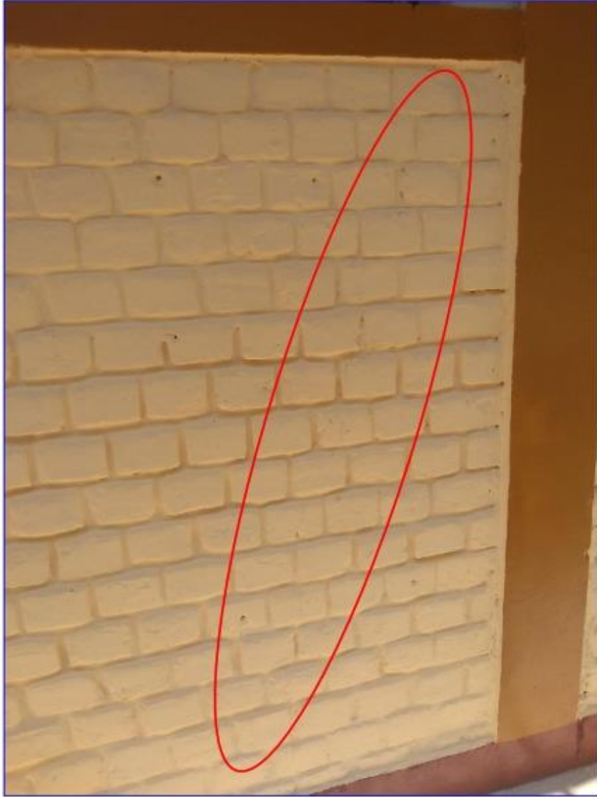
Imagen 13: Grietas diagonales en muros
