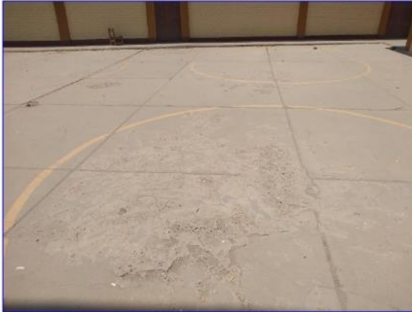
Imagen 72: Veredas con resto de material de concreto.
