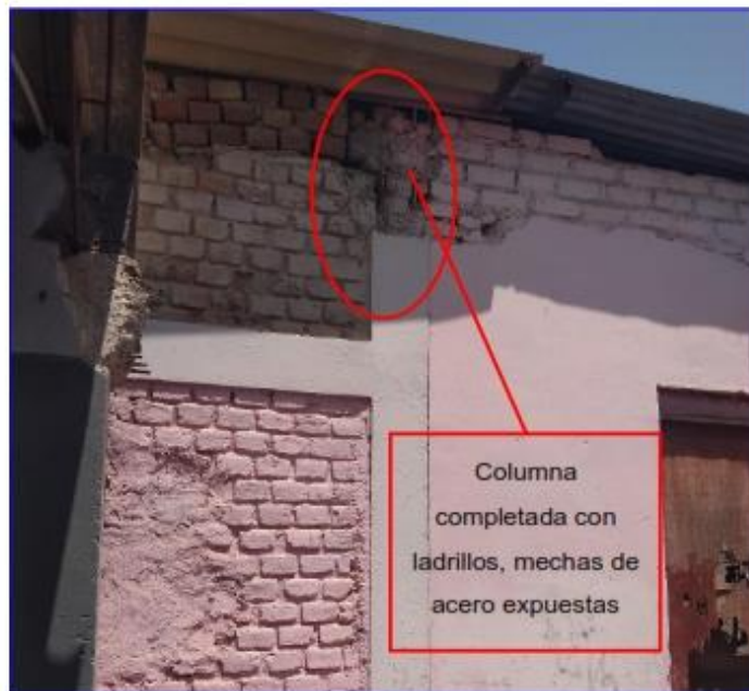
Imagen 36: Columna completada con ladrillos y mezcla de concreto, mechas de aceros expuestas.
