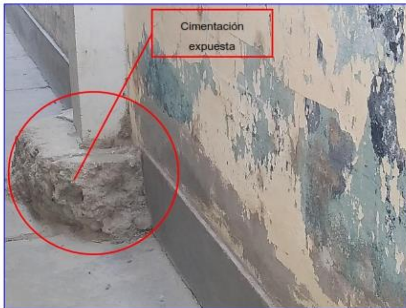
Imagen 40: Cimentación de columna expuesta.
