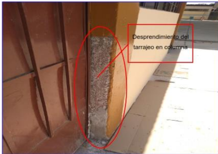
Imagen 52: Desprendimiento de Tarrajes
