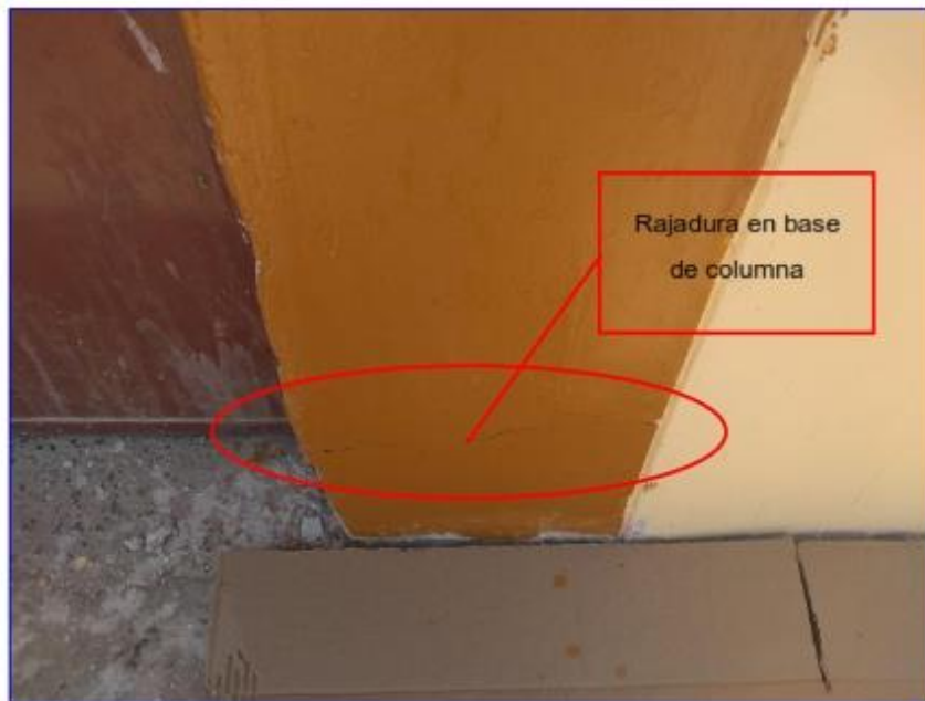
Imagen 53: Rajadura en base de columna.
