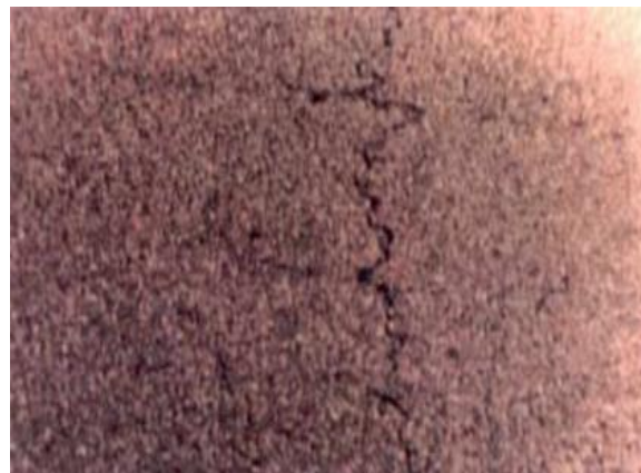
Figura 3. Fisura en las huellas de tránsito
