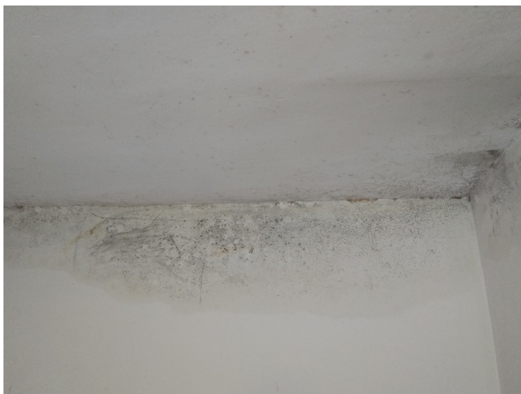
Interior del Bloque C – C6 – Presencia de humedad en el cielo raso y muro.
