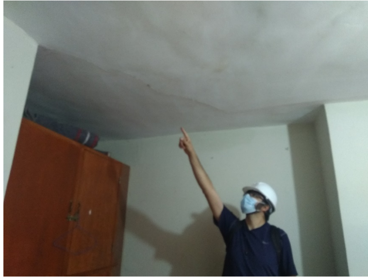
Interior del Bloque C – C6 – Fisura en cielo raso.
