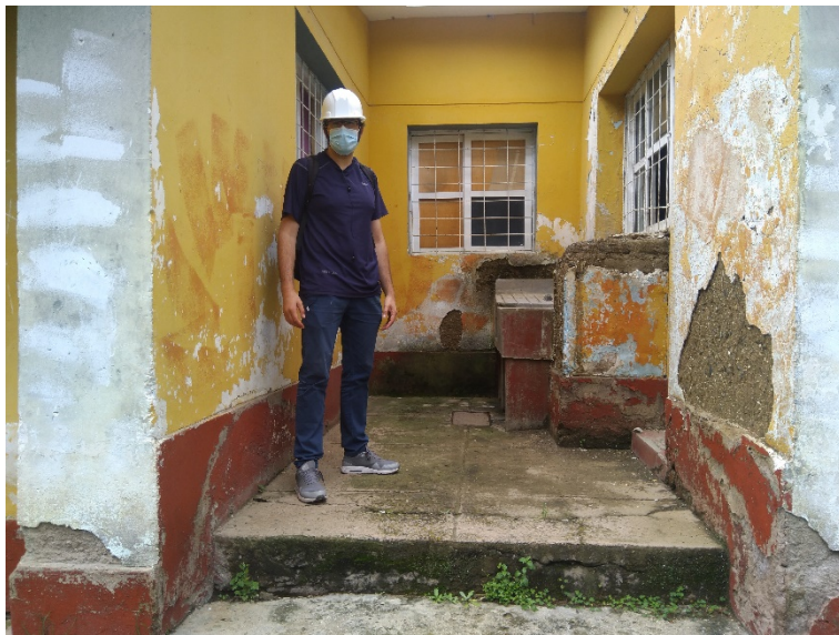
Exterior del Bloque B – C4 – Acceso lateral en mal estado.
