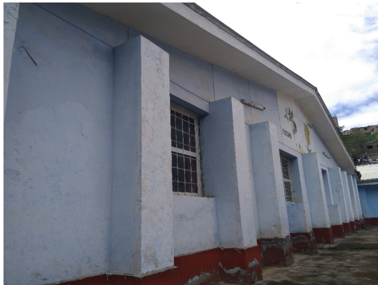
Exterior del Bloque B – Fachada principal – Presencia de contrafuertes y zócalo exterior deteriorado.
