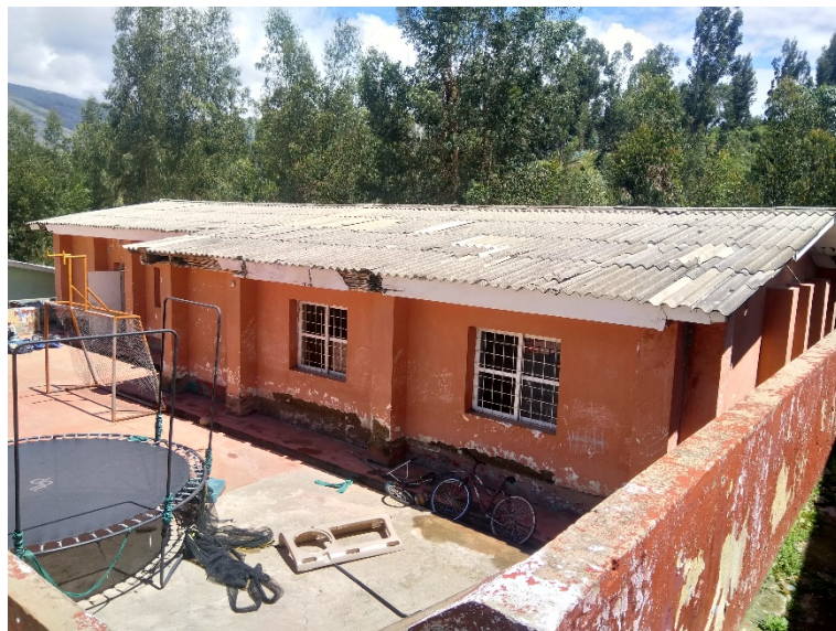
Fachada principal del Bloque E – Auditorio - Con deterioro en parte de la cobertura.
