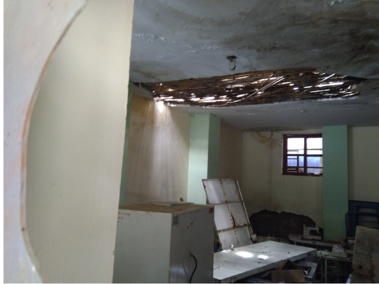
Interior del Bloque Abandonado – Techo colapsado.
