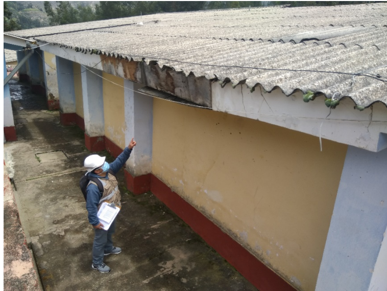
Exterior del Bloque B – C3 – Parte de la cobertura en mal estado.
