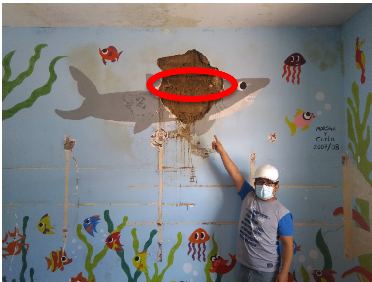
Interior del Bloque E – Auditorio – Presencia de cadena de amarre.
