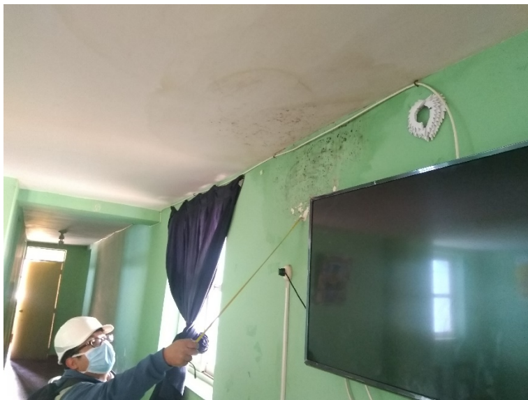
Interior del Bloque C – C6 – Presencia de humedad en el cielo raso y muro.
