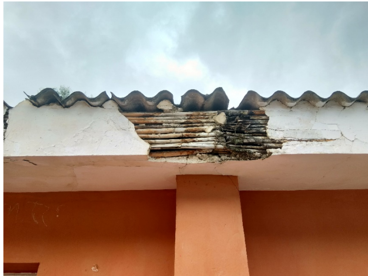
Exterior del Bloque E – Auditorio – Cobertura deteriorada.
