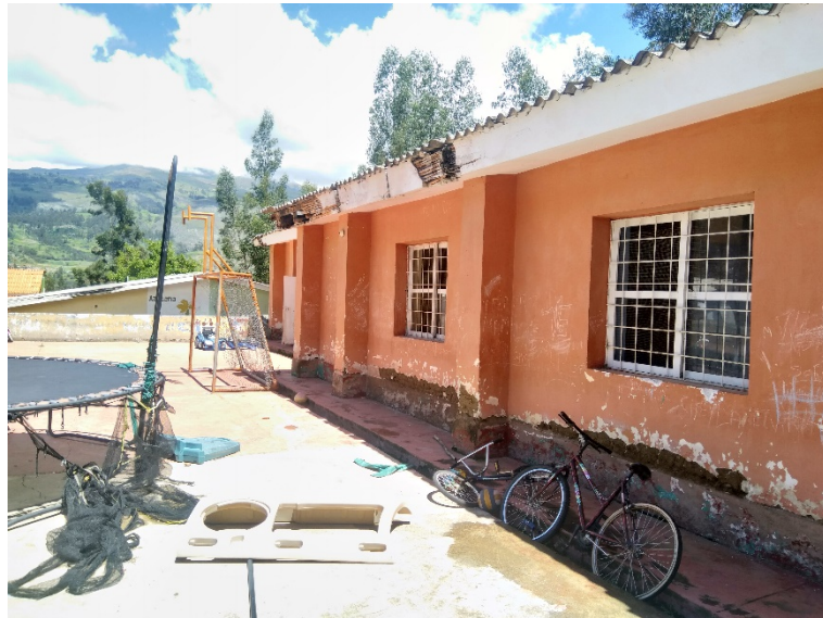
Fachada principal del Bloque E – Auditorio - Con deterioro en el tarrajeo de yeso.
