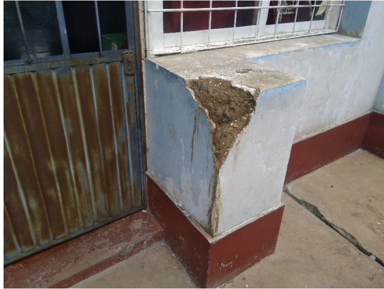
Exterior del Bloque C – C6 – Deterioro del contrafuerte bajo.
