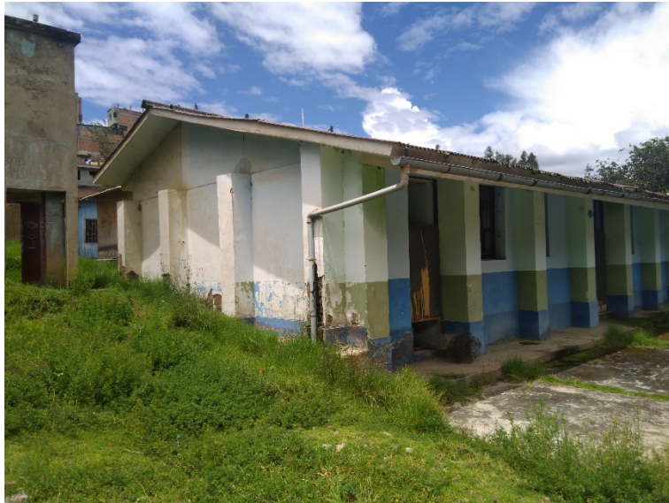
Bloque Abandonado – Edificación en desuso y tanque elevado deteriorado.
