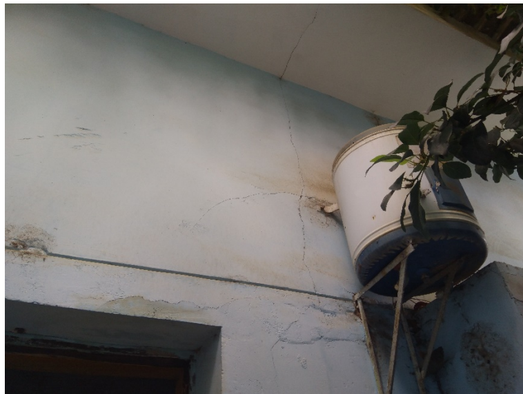
Exterior del Bloque D – Terma anclada a la estructura resistente.
