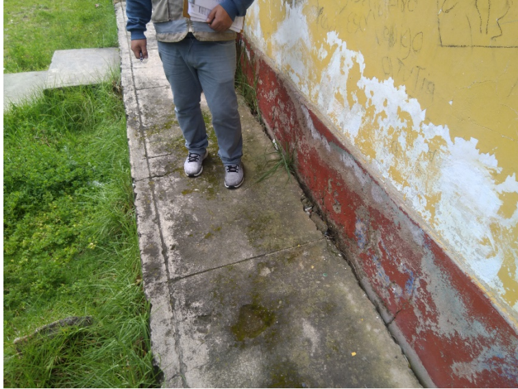
Exterior del Bloque B – C4 – Vereda deteriorada, zócalo y pintura en mal estado.
