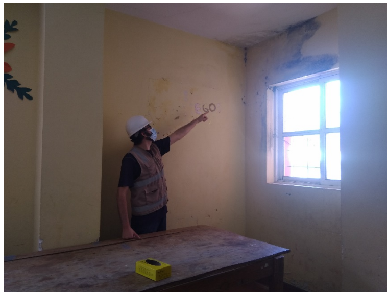
Interior del Bloque E – Auditorio – Presencia de moho y humedad en el techo y estructura horizontal.
