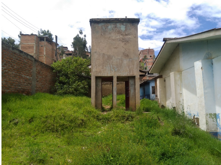
Bloques Abandonados – Tanque elevado deteriorado y en desuso.
