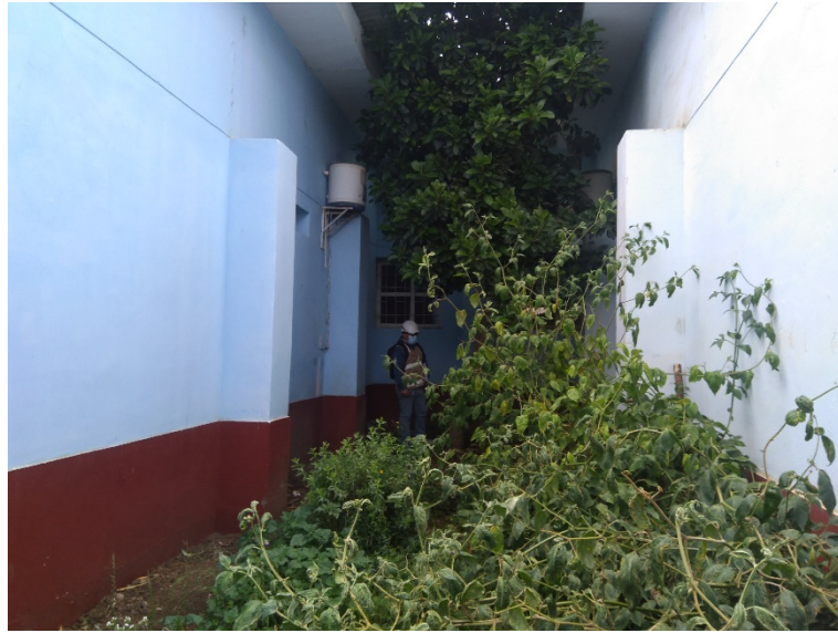
Exterior del Bloque D – Presencia de terma y maleza en la espalda del bloque.
