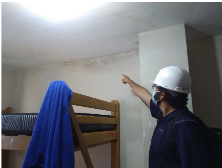
Interior del Bloque C – C6 – Presencia de humedad en el cielo raso y muro.
