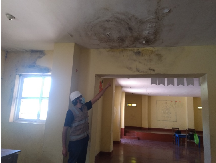
Interior del Bloque E – Auditorio – Presencia de humedad en el cielo raso.
