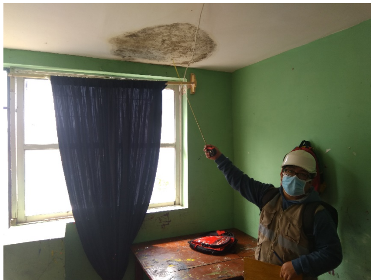
Interior del Bloque E – Auditorio – Humedad en el cielo raso.
