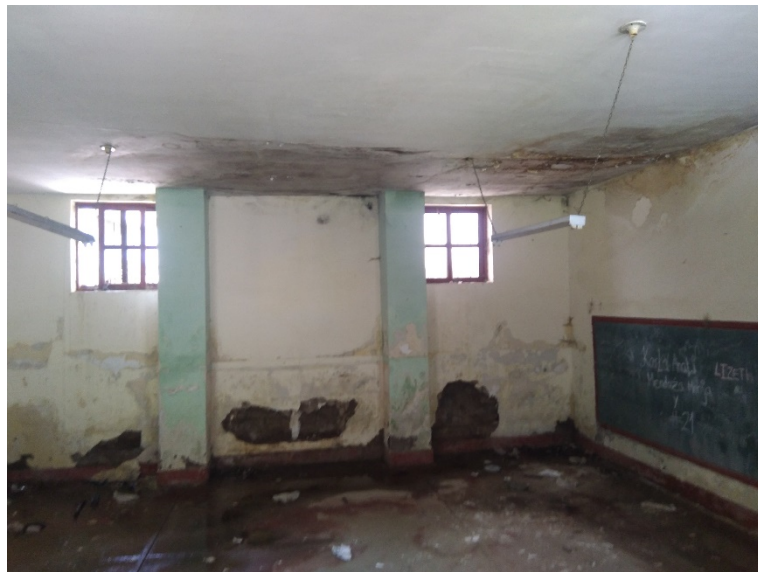
Interior del Bloque Abandonado – Estructuras en condición precarias y ante posible colapso.
