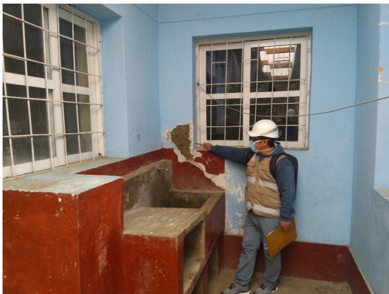
Exterior del Bloque D – C8 – Exposición del adobe por deterioro de tarrajeo.
