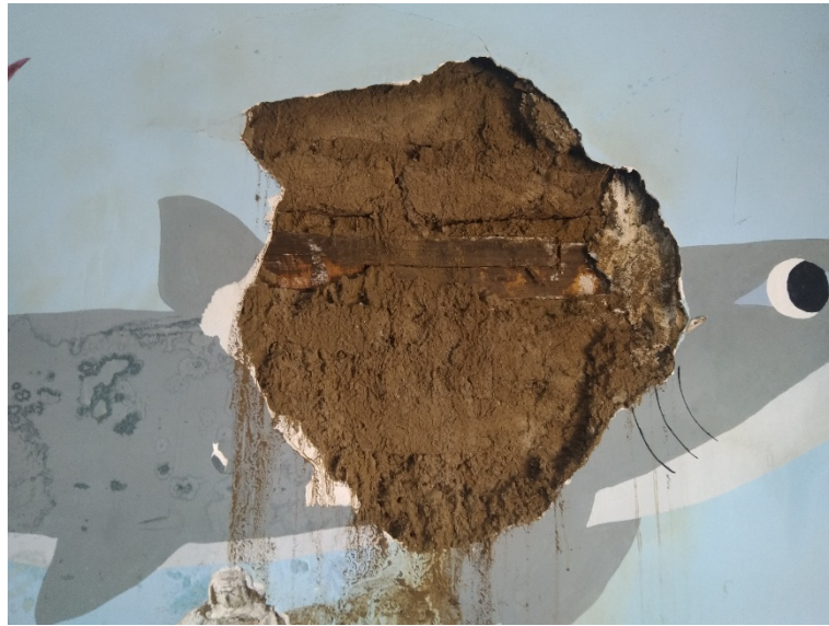
Interior del Bloque E – Auditorio – Presencia de cadena de amarre - detalle.
