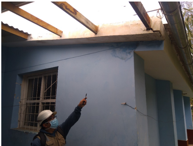
Exterior del Bloque D – C8 – Presencia de humedad en techo.
