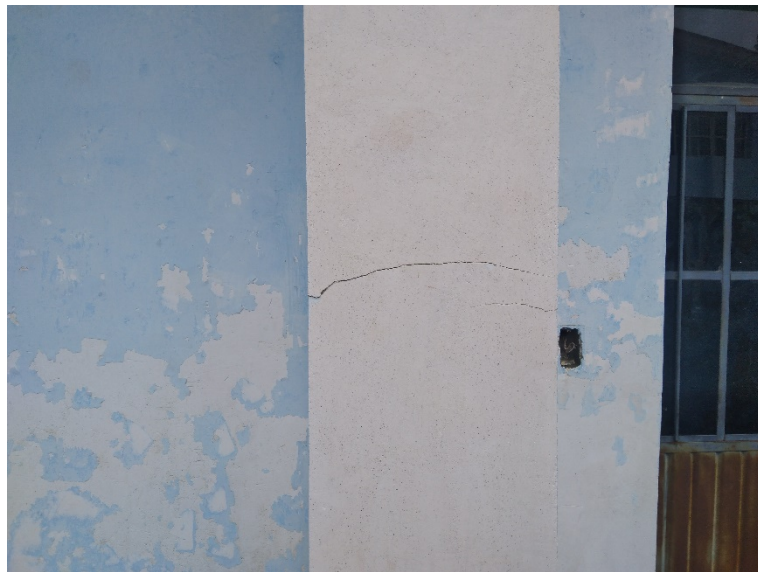
Exterior del Bloque C – C6 – Fisura del tarrajeo del contrafuerte.
