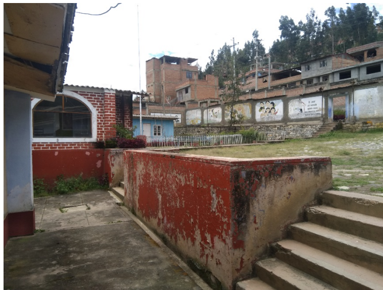
Patio Principal – Deterioro de escaleras y veredas exteriores con presencia de humedad.
