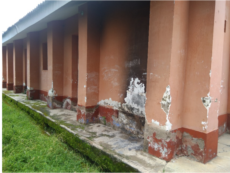
Exterior del Bloque E – Auditorio – Fachada posterior y zócalo exterior deteriorado.
