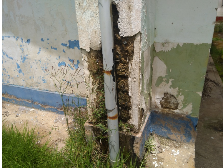
Bloque Abandonado– Contrafuerte deteriorado por el mal estado de la tubería.
