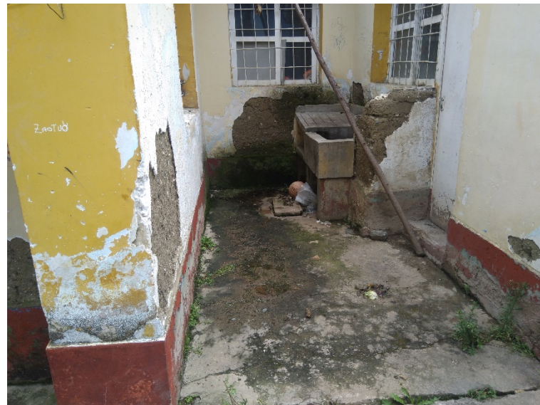
Exterior del Bloque D – C7 – Entrada lateral completamente deteriorada por falta de mantenimiento, se aprecia la humedad por efecto del intemperismo.
