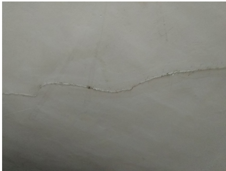
Interior del Bloque C – C6 – Fisura en cielo raso - Detalle.
