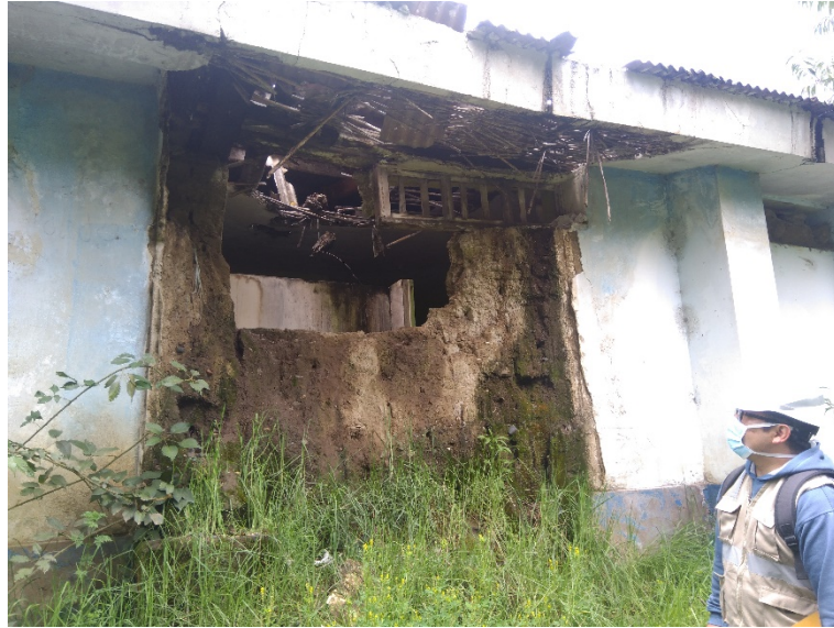
Bloque Abandonado – Edificación en desuso por colapso estructural.
