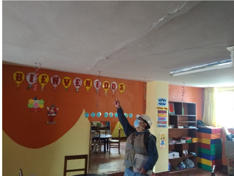
Interior del Bloque B – C3 – Fisura en el cielo raso.
