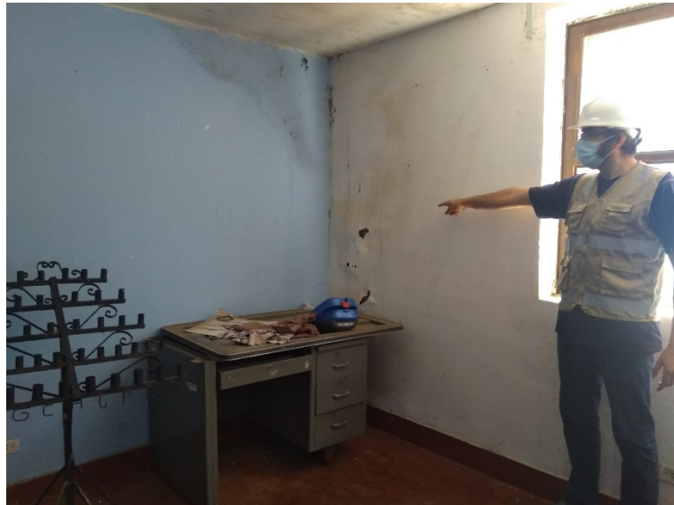
Interior del Bloque E – Auditorio – Presencia de humedad en la pared.
