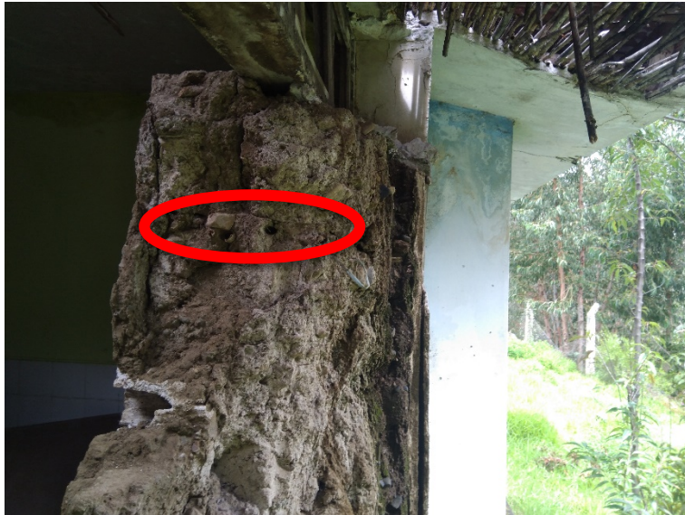
Bloque Abandonado – Refuerzos horizontales de carrizo.
