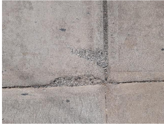
Figura 1. Falla encontrada en el Jr. Beltrán Rivera de la Ciudad de Puno
