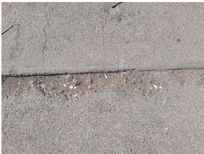
Figura 21. Descascaramiento de junta
