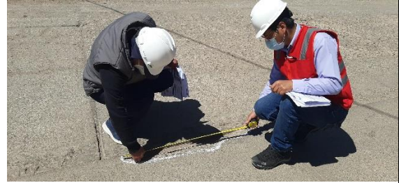
Verificación del tipo de falla y determinación de dimensiones
