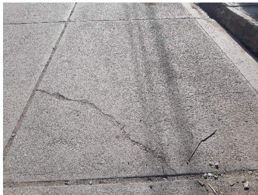
Figura 3. Grieta de esquina
