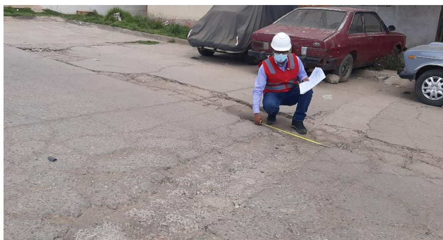
Figura 37. Determinación del tipo de falla “Parcheo grande” - Tramo 3
