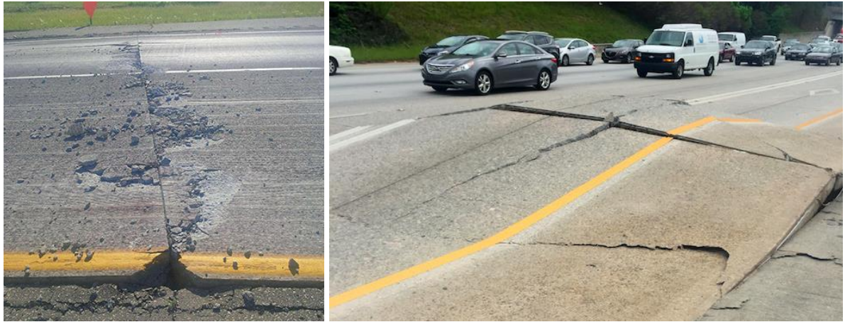
Figura 4. Falla tipo Blowups
