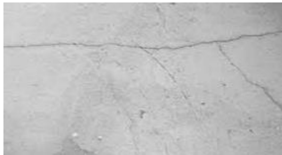
Figura 19. Falla de tipo mapa de grietas
