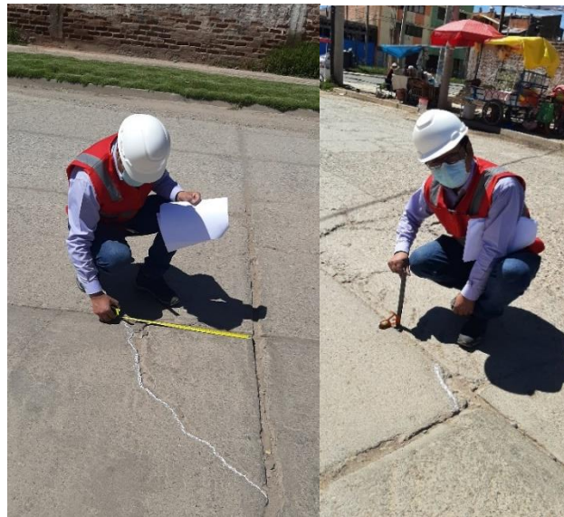
Figura 34. Evaluación de falla Grieta de esquina y Escala
