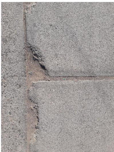
Figura 20. Falla de tipo descascaramiento de esquina
