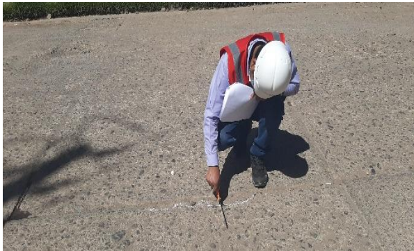
Falla de tipo pulimento de agregados
