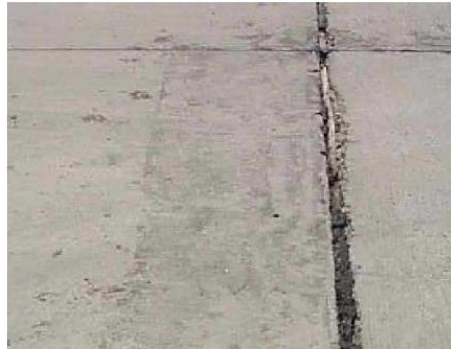
Figura 8. Escala de alta severidad
