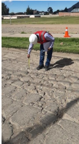
Figura 38. Tipo de Falla “Losa Dividida” Alto – Tramo 3
