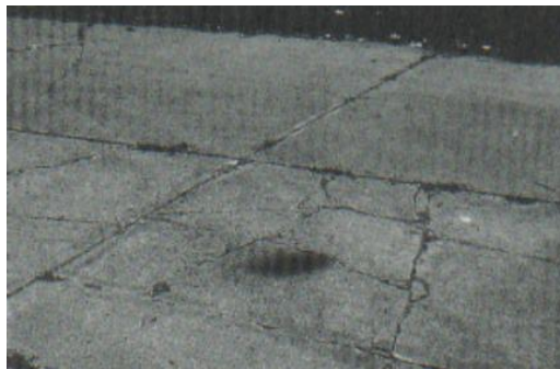
Figura 5. Losa dividida de alta severidad
