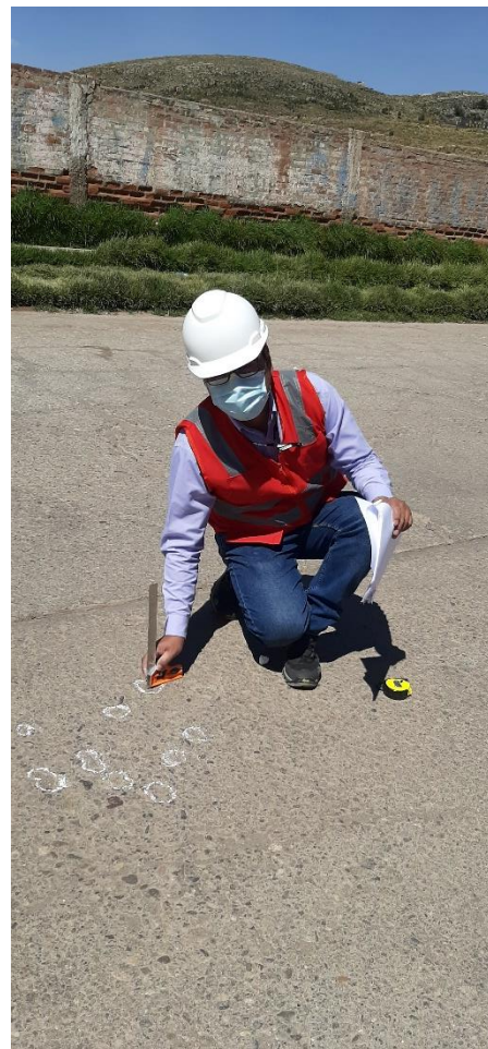
Falla de tipo Pulimento de agregados
