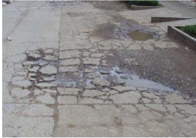
Figura 18. Falla de tipo mapa de grietas
