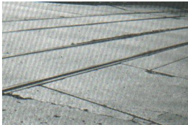
Figura 17. Falla de tipo cruce de vía férrea
