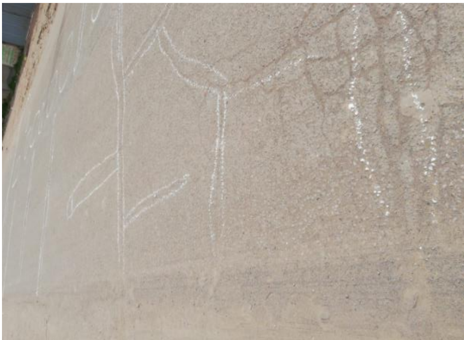
Fotografía 53. "Fisuras longitudinales, transversales y piel de cocodrilo de severidad alta"
