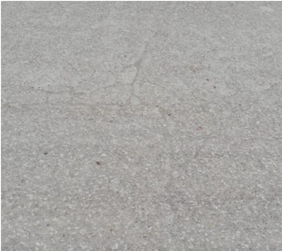
Fotografía 87. "Fisuras transversales y desprendimiento de agregados en la unidad de evaluación N°10"
