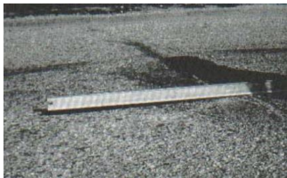
Figura 4. "Abultamiento y hundimiento presente en el pavimento"
