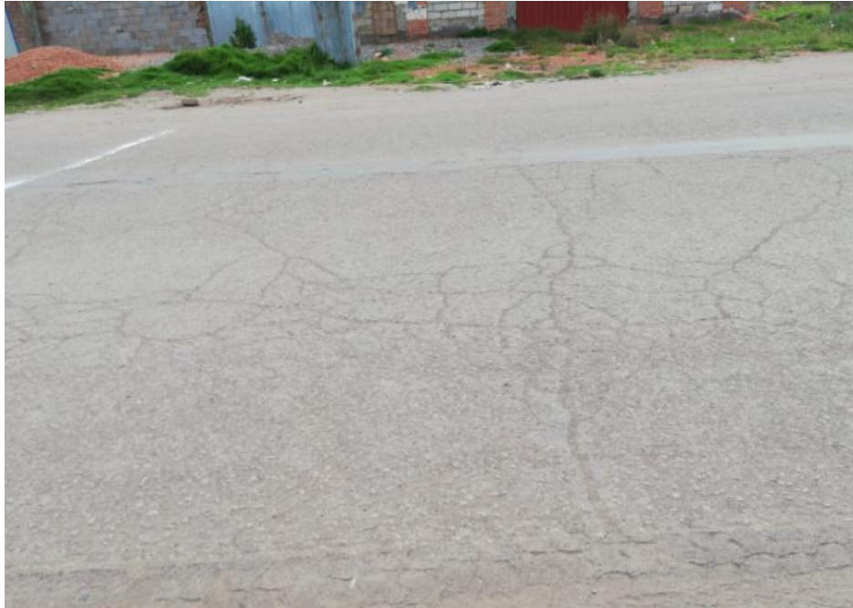
Fotografía 96. "Fisuras longitudinales, transversales y parches en la unidad de evaluación N°11"
