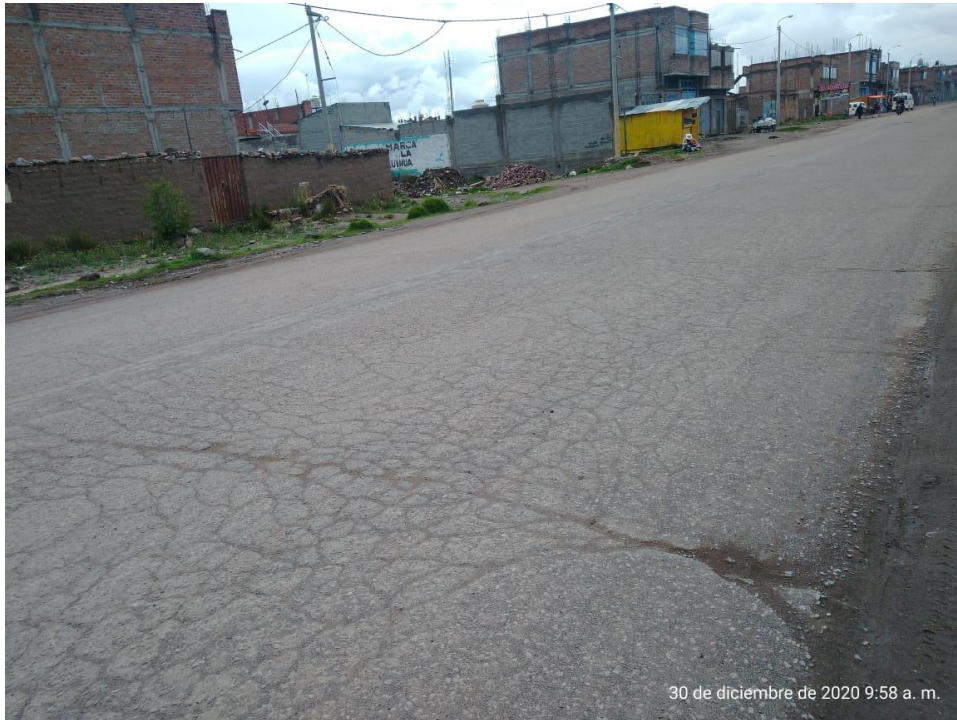
Fotografía 15. "Fisuras transversales y piel de cocodrilo en la vía Juliaca - Lampa"
