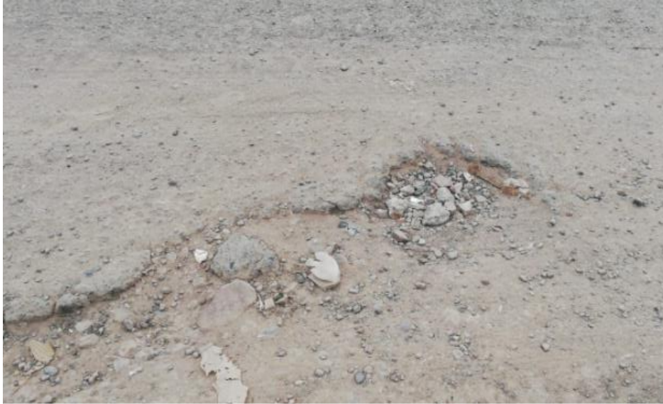
Fotografía 82. "Presencia grietas de borde en la unidad de evaluación N°09"
