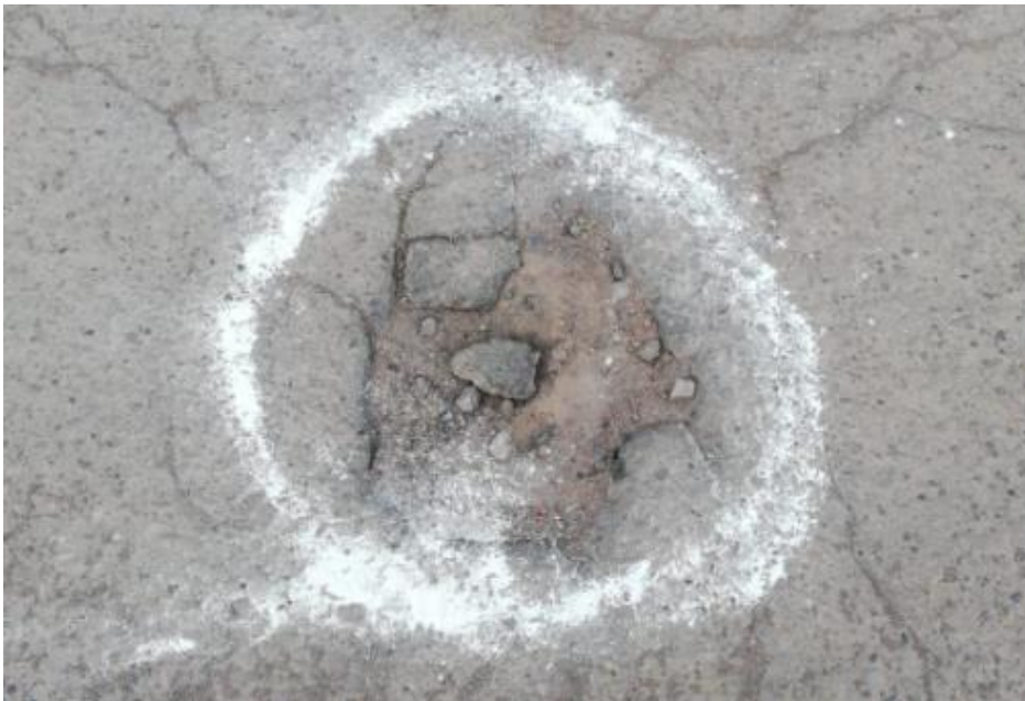
Fotografía 95. "Hueco de severidad alta en la unidad de evaluación N°11"
