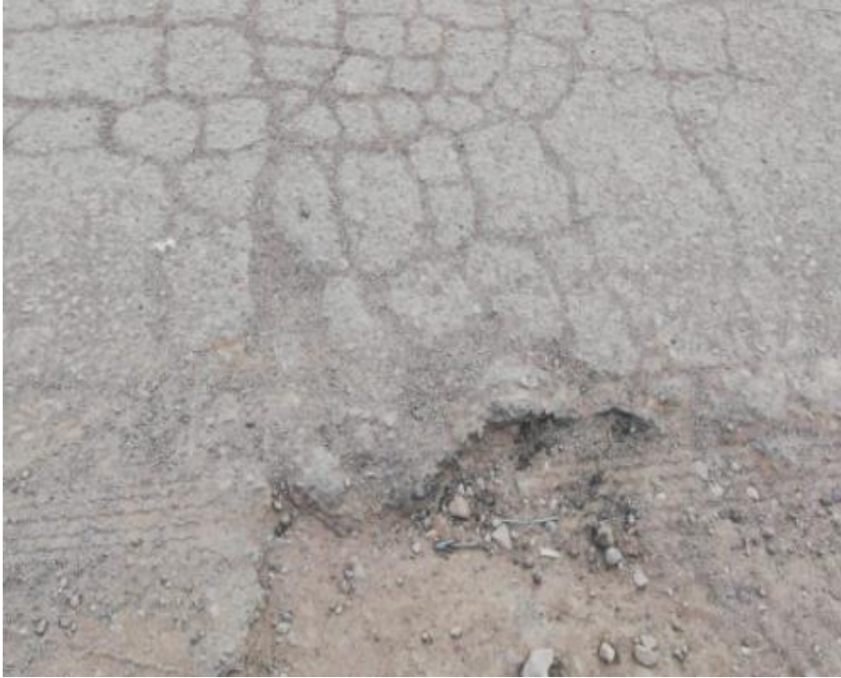
Fotografía 72. "Piel de cocodrilo y grieta de borde en la unidad de evaluación N°08"
