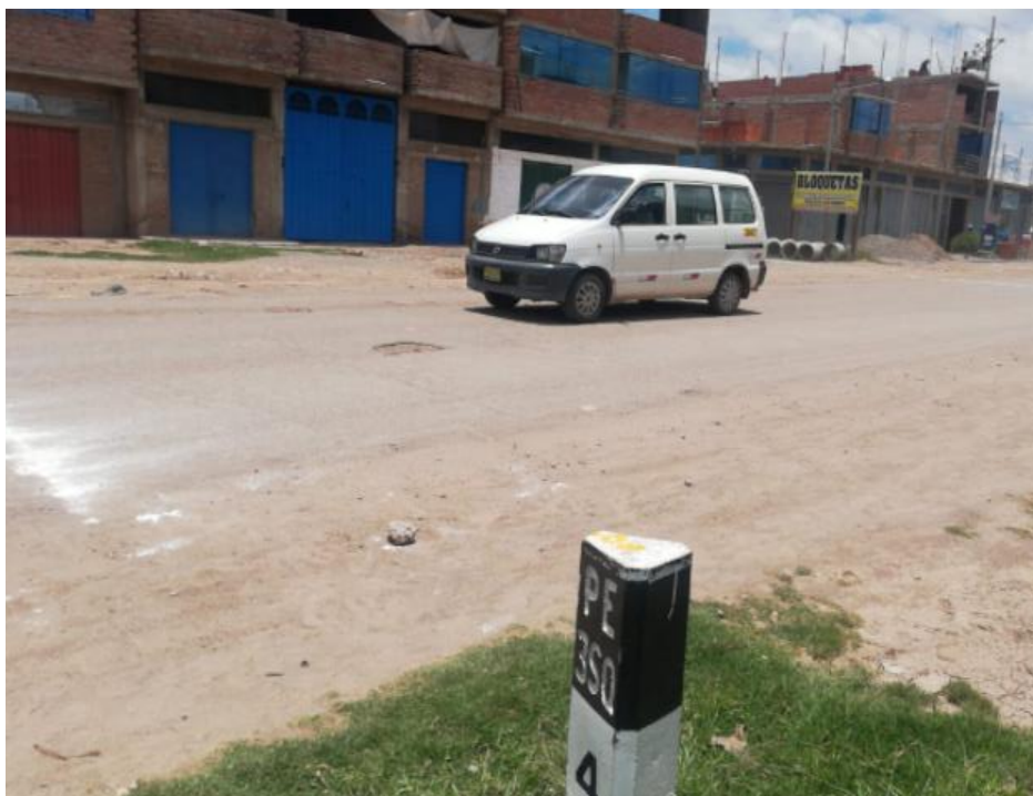
Fotografía 36. "Presencia de huecos en la unidad de evaluación N°01"
