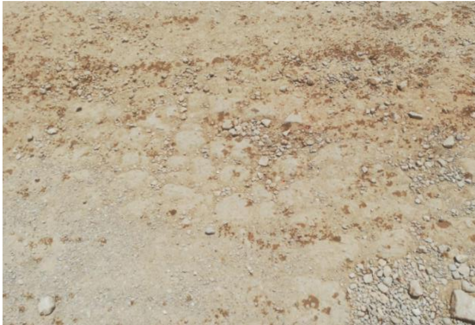
Fotografía 42. "Presencia de piel de cocodrilo de severidad alta en la unidad de evaluación N°02"
