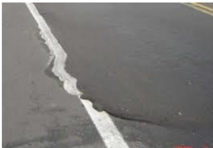
Figura 16. "Desplazamiento en pavimentos"
