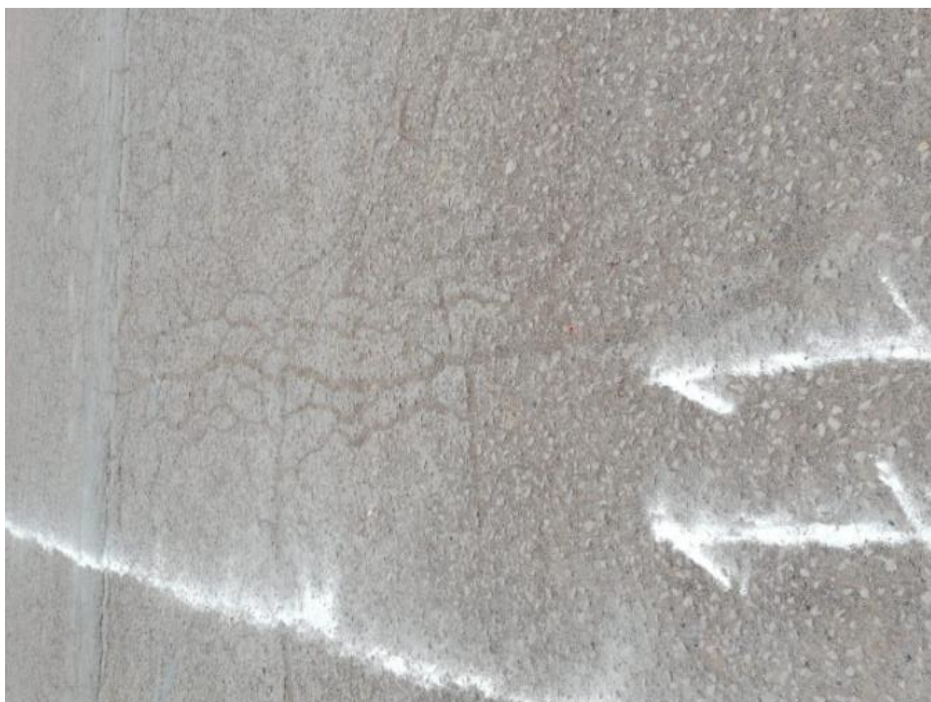
Fotografía 92. "Grietas transversales, parches y desprendimiento de agregados en la unidad de evaluación N°11"
