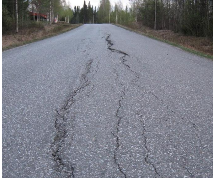
Figura 10. "Fisuras longitudinales en pavimentos"
