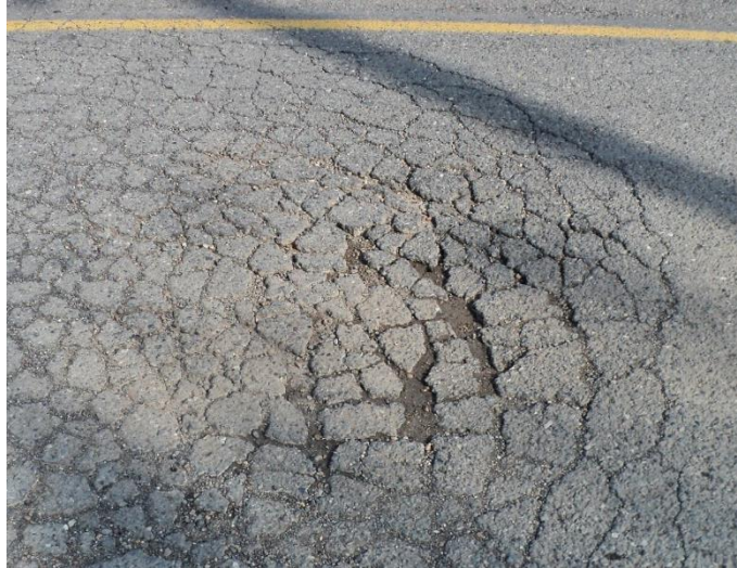
Figura 1. "Fisura de piel de cocodrilo"
