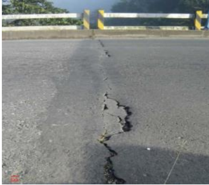
Figura 8. "Fisura de reflexión de junta"
