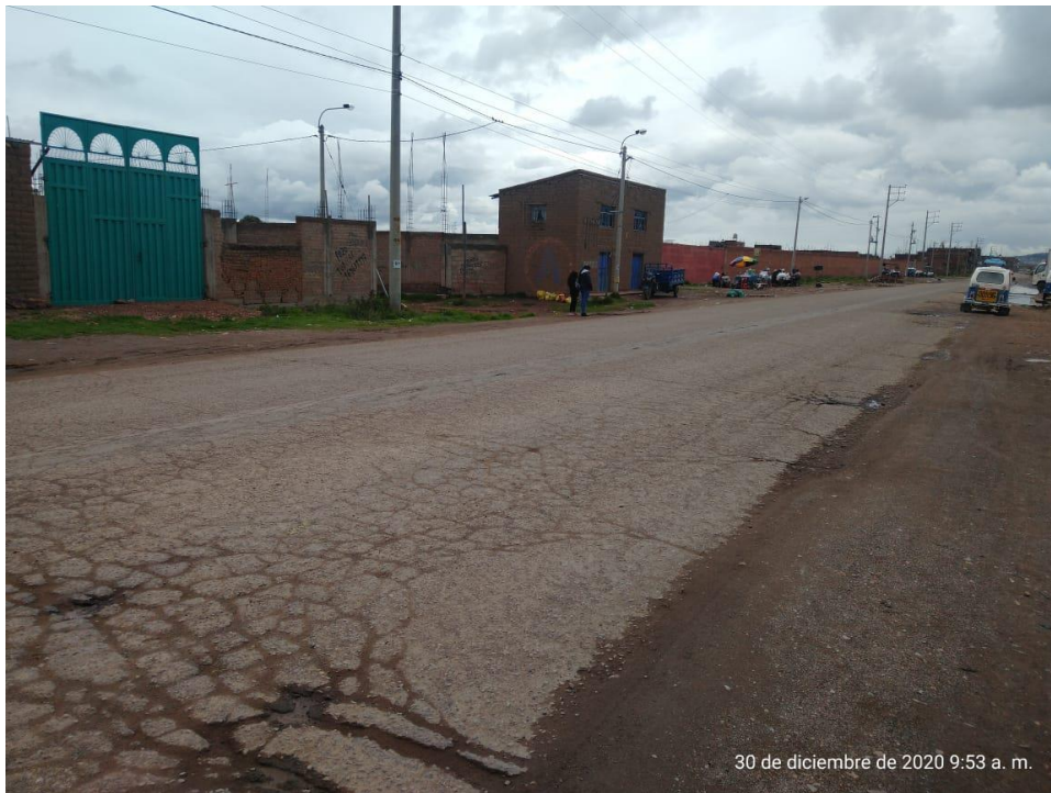
Fotografía 8. "Fisuras de borde y piel de cocodrilo presentes en la vía Juliaca - Lampa"
