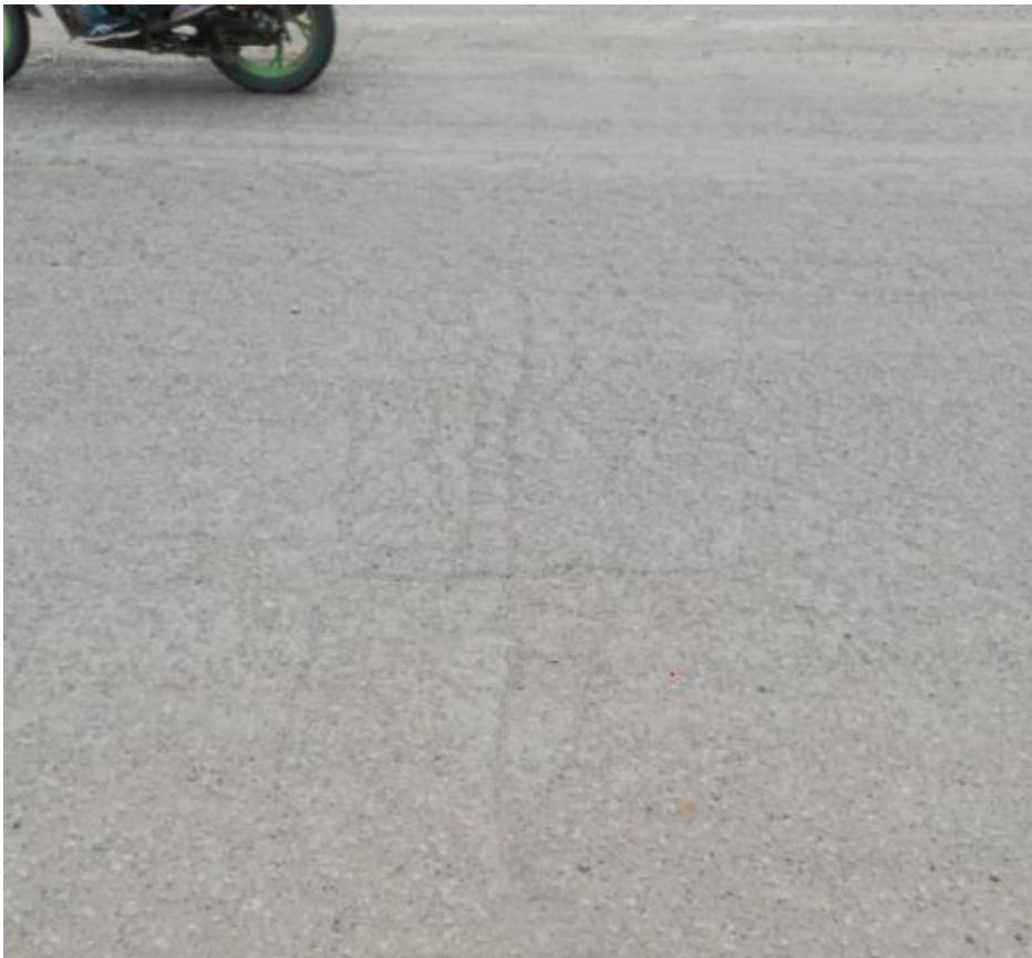
Fotografía 79. "Presencia de grietas transversales de severidad moderada en la unidad de evaluación N°09"
