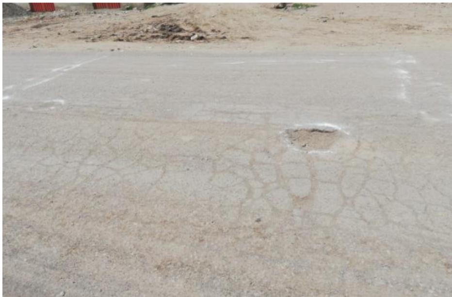
Fotografía 45. "Presencia de huecos, piel de cocodrilo y fisuras longitudinales en la unidad de evaluación N°01"
