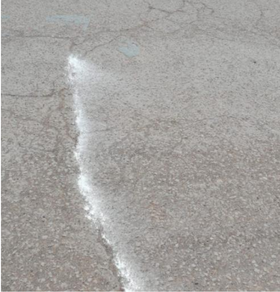
Fotografía 94. "Presencia de fisuras longitudinales y transversales en la unidad de evaluación N°11"
