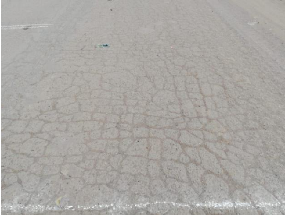
Fotografía 60. "Presencia de piel de cocodrilo de severidad alta en la unidad de evaluación N°06"
