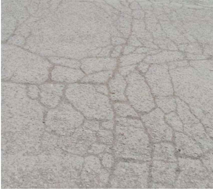
Fotografía 64. "Presencia de grieta longitudinales, transversales y piel de cocodrilo en la unidad de evaluación N°07"
