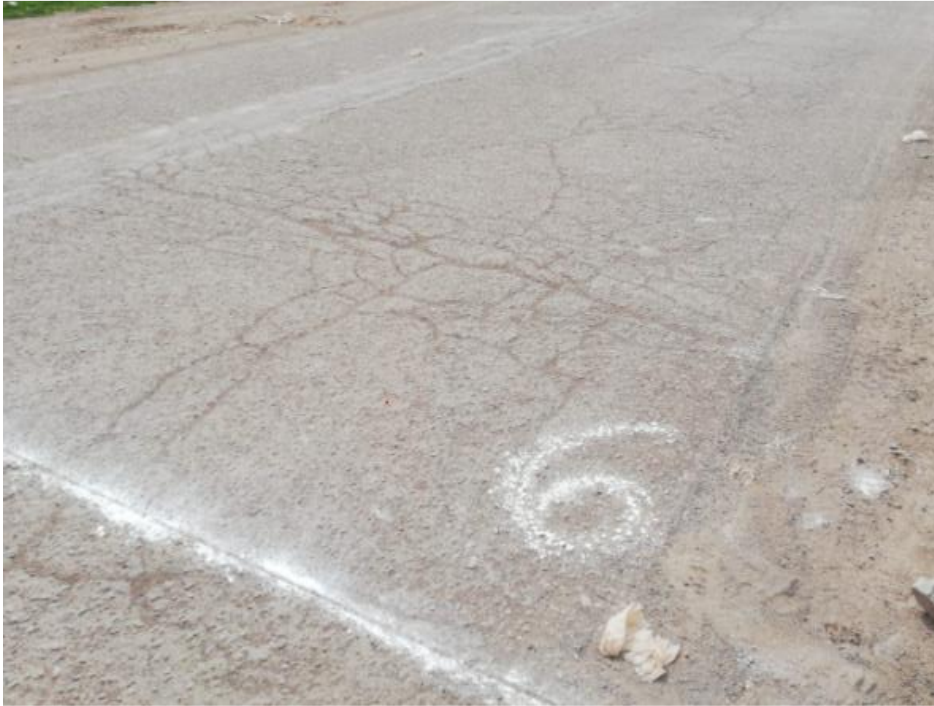
Fotografía 56. "Fisuras longitudinales, transversales y grietas de borde de la unidad de evaluación N°06"
