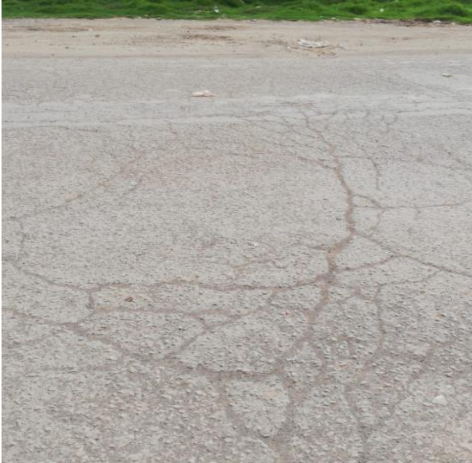
Fotografía 58. "Presencia de grieta parabólica en la unidad de evaluación N°06"
