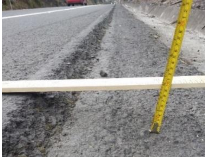
Figura 9. "Desnivel de carril y berma"
