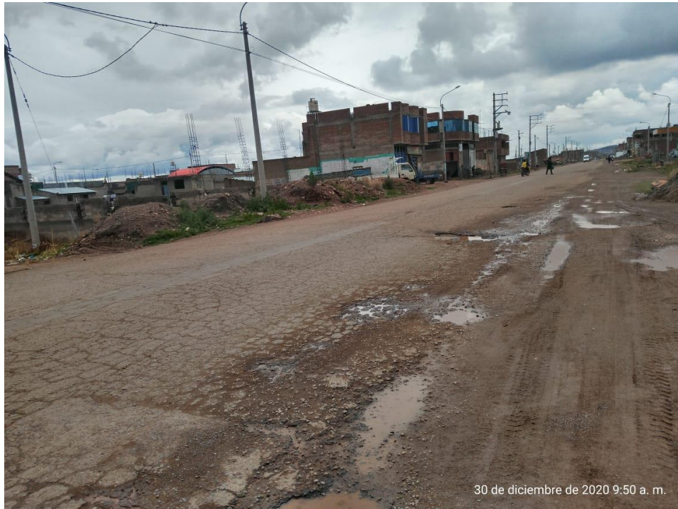
Fotografía 3. "Presencia de huecos con agua, grietas de borde y piel de cocodrilo de severidad alta en el tramo 5 de la vía Juliaca - Lampa"
