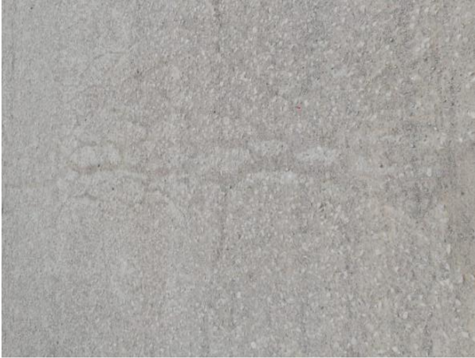
Fotografía 88. "Fisura transversal de severidad alta en la unidad de evaluación N°10"
