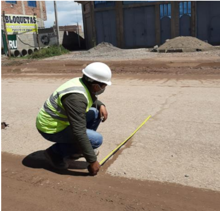
Fotografía 38. "Medición de las fallas encontradas en la unidad de evaluación N°01"
