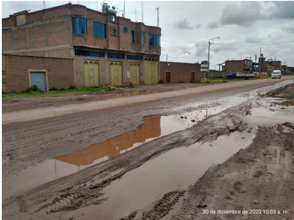
Fotografía 21. "Presencia de exudación i baches en la vía Juliaca - Lampa"
