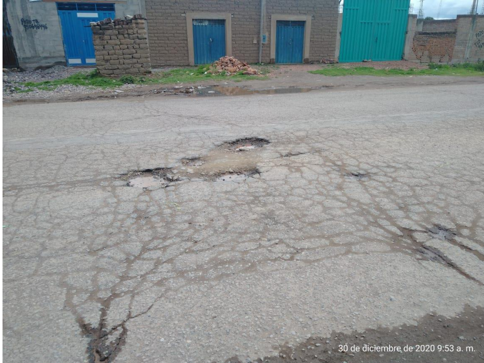
Fotografía 7. "Existencia de grietas de borde, piel de cocodrilo y huecos de severidad alta ubicada en el tramo 5 de la vía Juliaca - Lampa"
