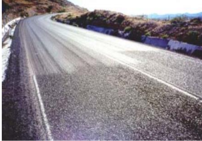
Figura 19. "Desprendimiento de agregados en pavimentos"
