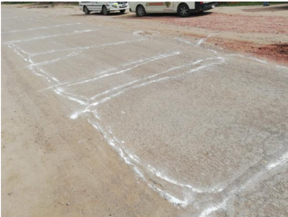
Fotografía 49. "Fisuras longitudinales, transversales y fisuras de borde en la unidad de evaluación N°04"
