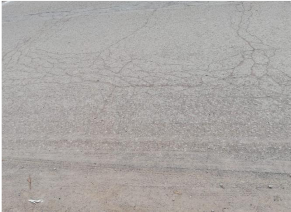
Fotografía 102. "Desprendimiento de agregados en la unidad de evaluación N°12"
