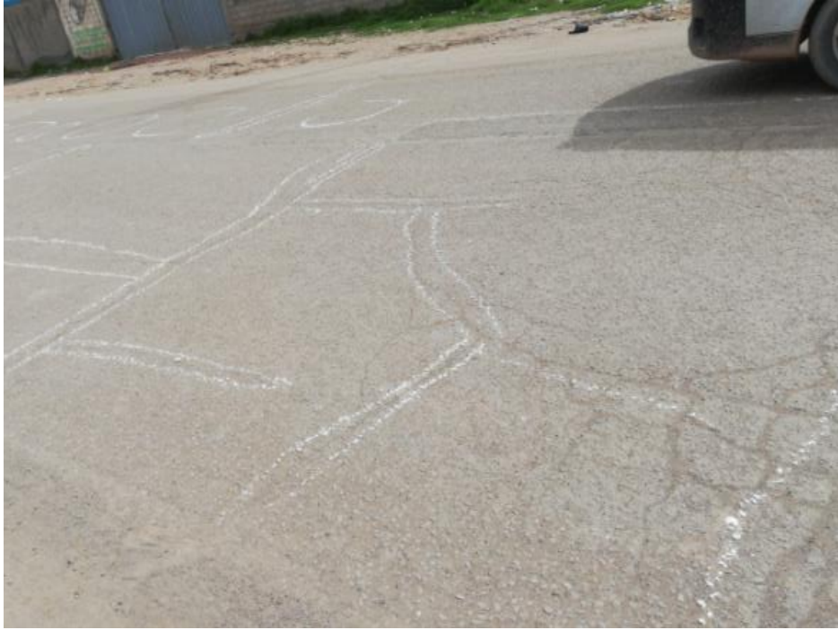
Fotografía 52. "Marcas de las fallas encontradas en la unidad de evaluación N°05"
