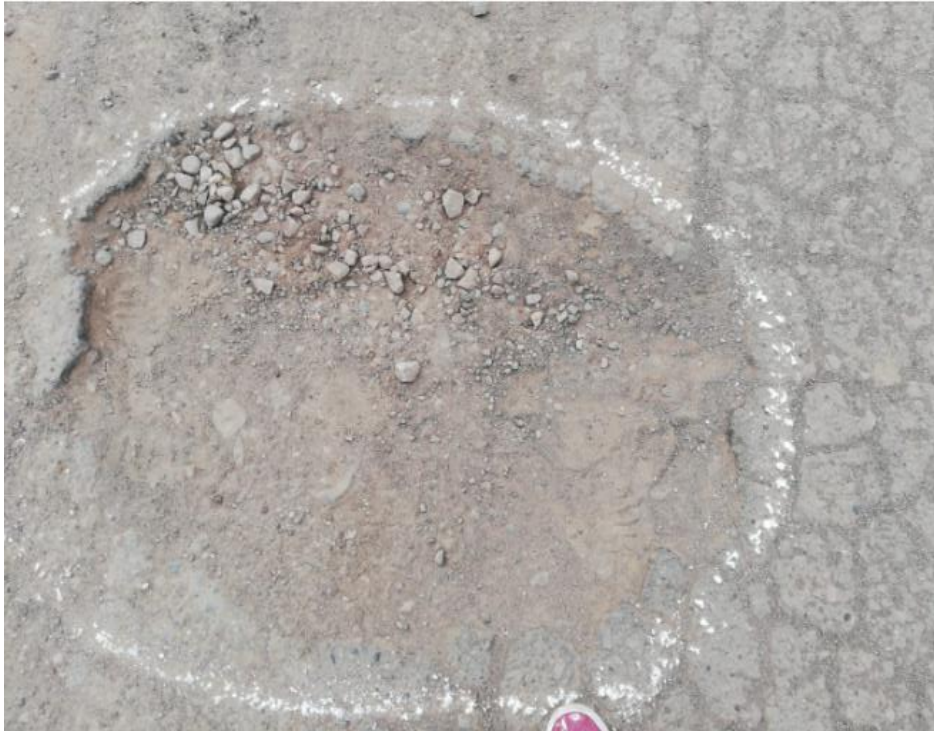
Fotografía 74. "Presencia de hueco de severidad alta en la unidad de evaluación N°08"
