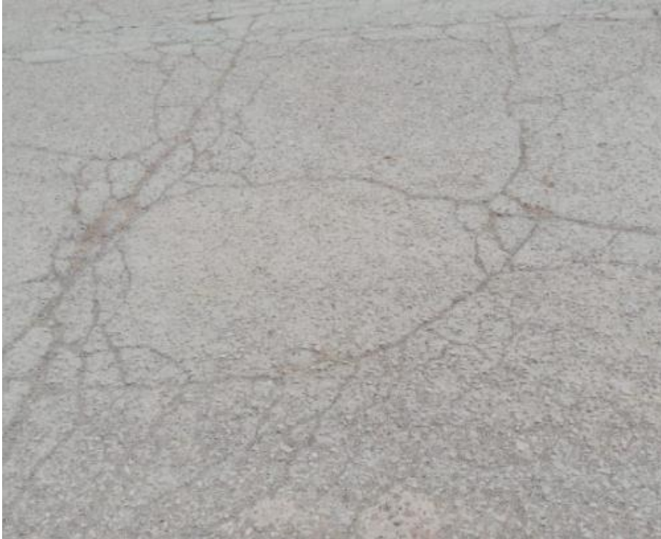
Fotografía 68. "Presencia de grieta parabólica de la unidad de evaluación N°07"
