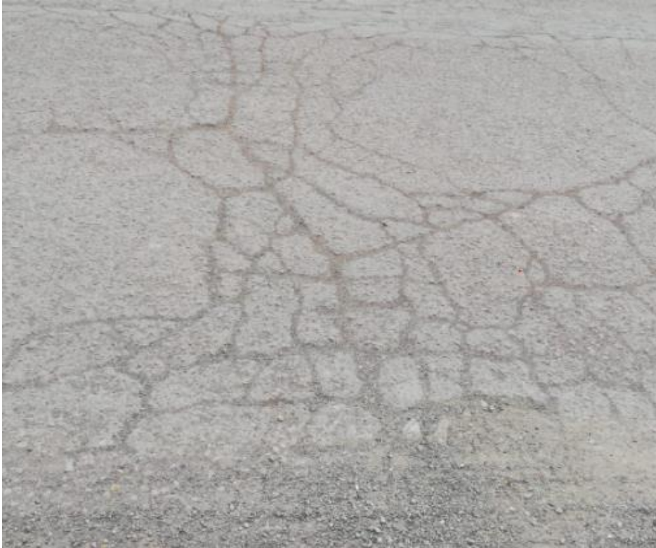
Fotografía 66. "Presencia de piel de cocodrilo de severidad alta en la unidad de evaluación N°07"
