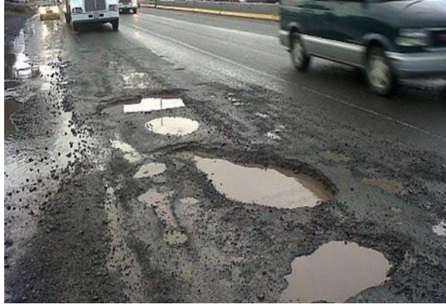
Figura 13. "Baches o huecos presentes en pavimentos"
