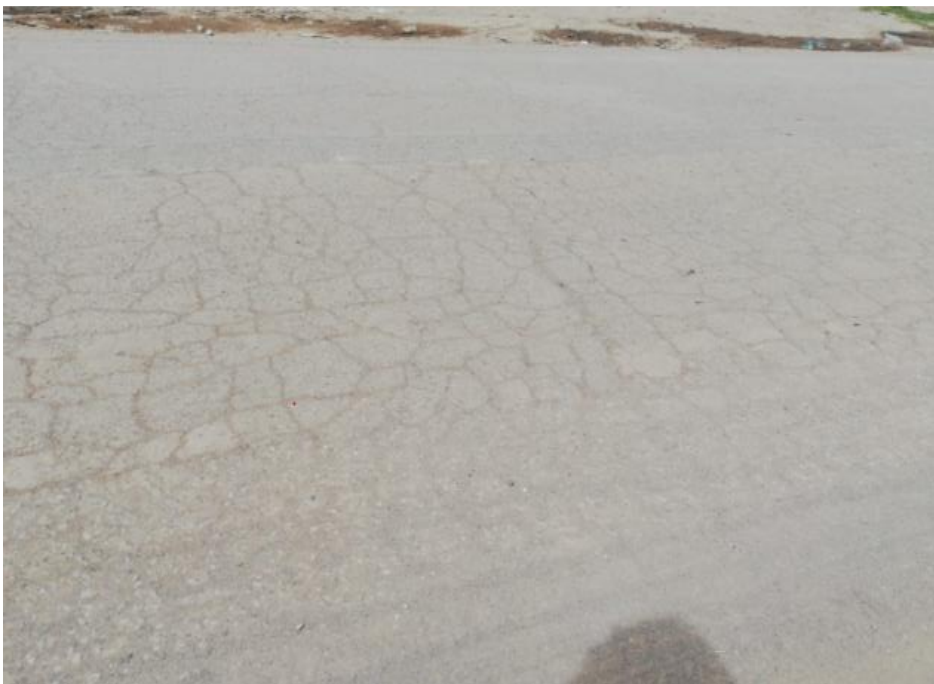
Fotografía 61. "Presencia de piel de cocodrilo y fisuras longitudinales de severidad alta en la unidad de evaluación N°06"
