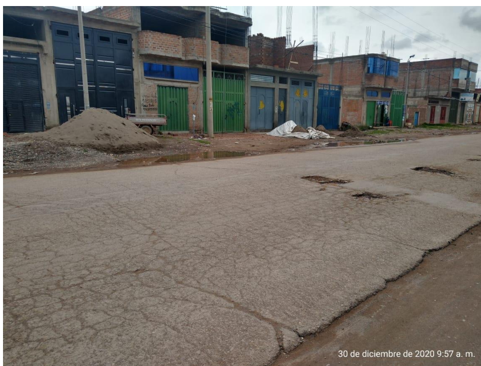
Fotografía 14. "Presencia de grietas de borde, piel de cocodrilo y huecos en la vía Juliaca - Lampa"
