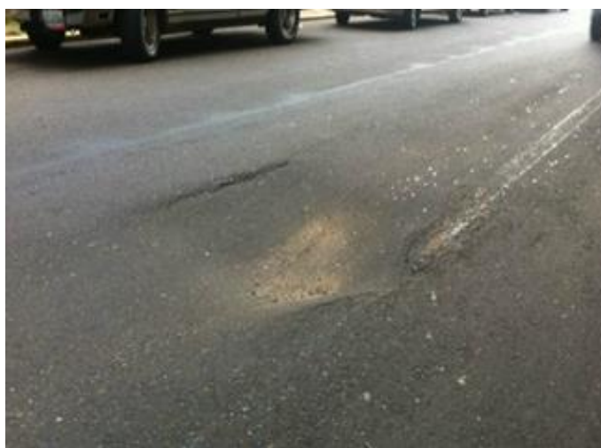
Figura 6. "Presencia de depresión en pavimentos"
