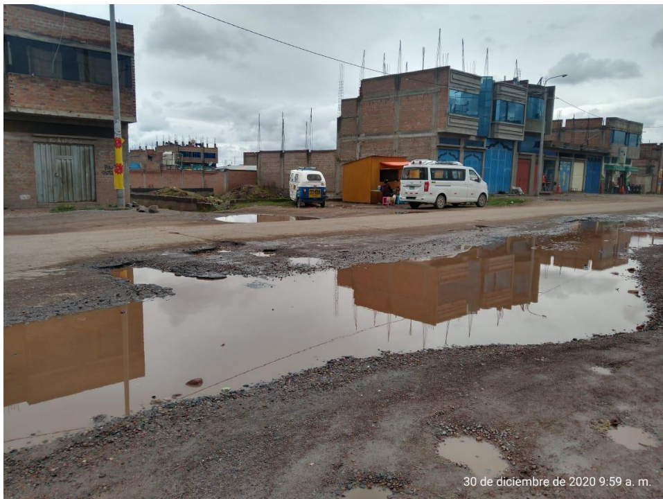
Fotografía 16. "Presencia de Baches en la vía Juliaca - Lampa"
