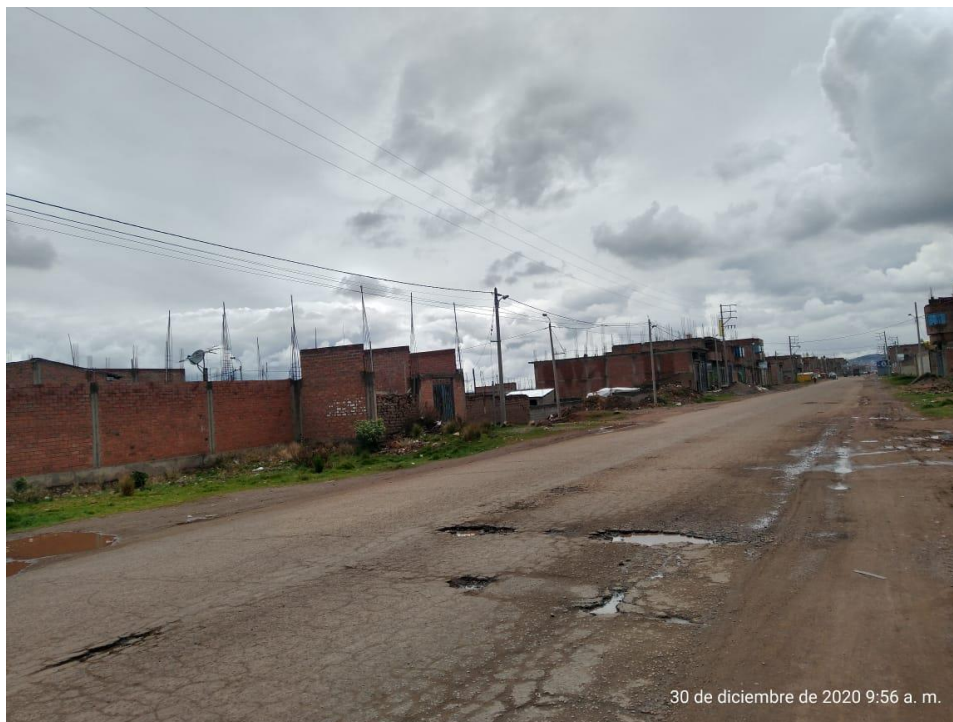
Fotografía 13. "Existencia de grietas de borde, piel de cocodrilo y exudación ubicada en el tramo 5 de la vía Juliaca - Lampa"
