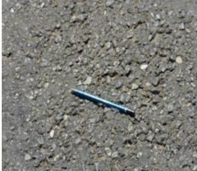
Figura 12. "Pulimento de agregados presente en pavimentos"
