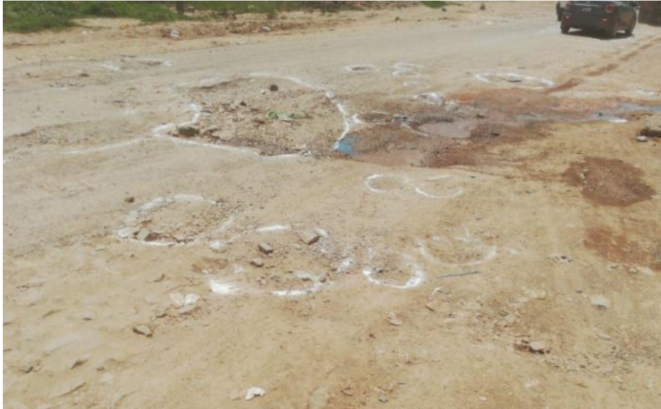
Fotografía 40. "Presencia de huecos en la unidad de evaluación N°02"
