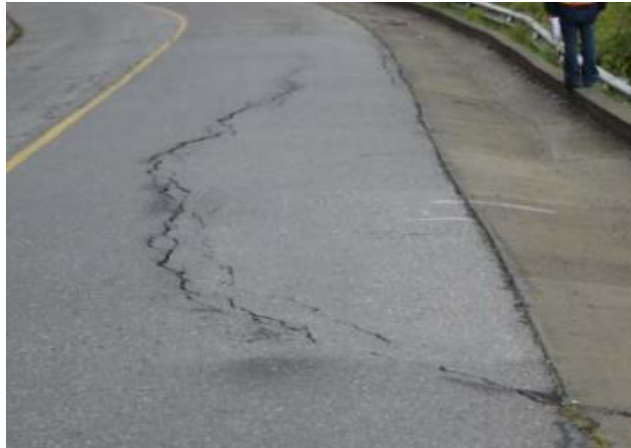
Figura 17. "Grieta parabólica presente en el pavimento"
