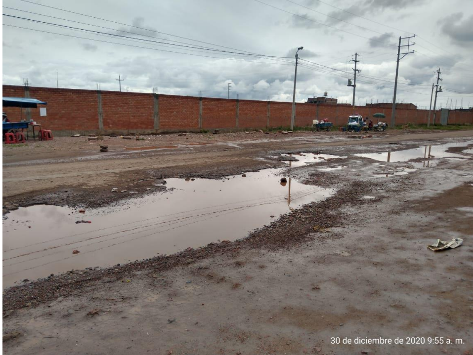
Fotografía 11. "Existencia de huecos de severidad alta, en donde ya no se observa la presencia del pavimento flexible en el tramo 5 de la vía Juliaca - Lampa"
