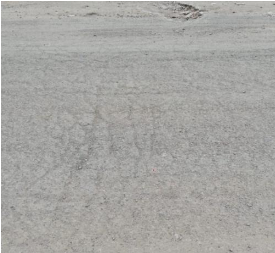
Fotografía 81. "Piel de cocodrilo y huecos en la unidad de evaluación N°09"
