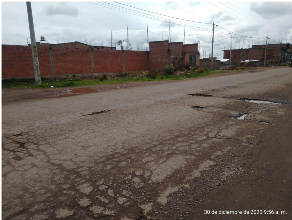
Fotografía 12. "Existencia de piel de cocodrilo, huecos con presencia de agua y exudación en el tramo 5 de la vía Juliaca - Lampa"
