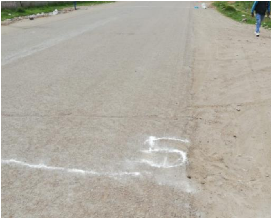
Fotografía 51. "Presencia de fisuras longitudinales, transversales y parches en la unidad de evaluación N°05"
