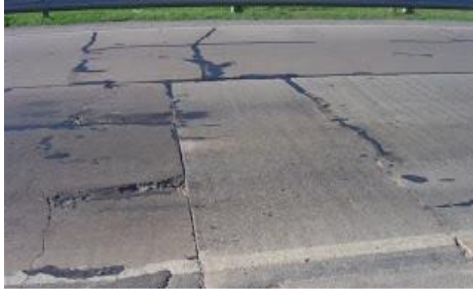
Figura 3. "Fisura en bloque"
