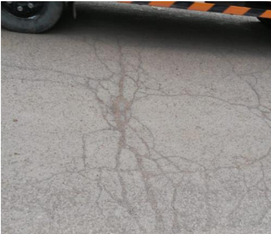
Fotografía 67. "Presencia de huecos y fisuras transversales de la unidad de evaluación N°07"
