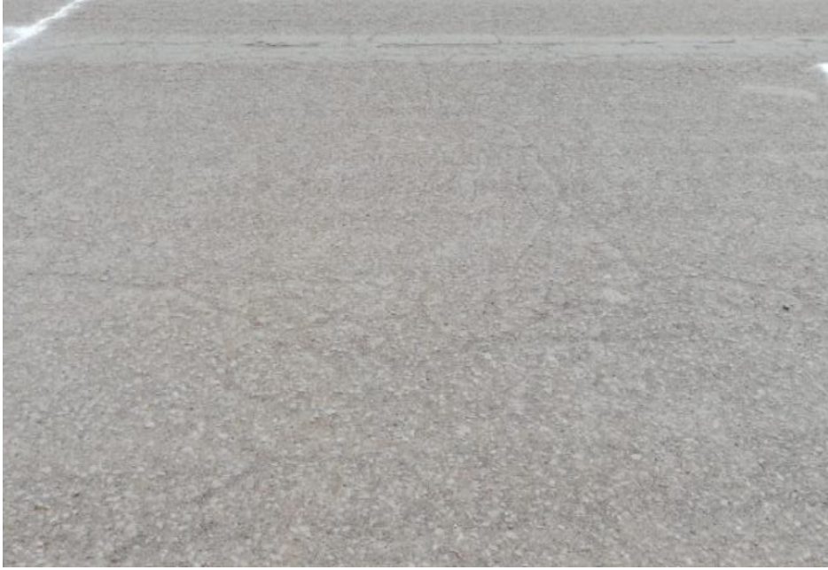
Fotografía 86. "Presencia de parches y grietas transversales de severidad moderada en la unidad de evaluación N°10"
