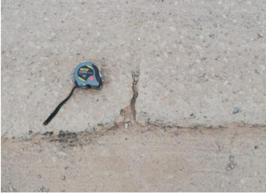
Fotografía 76. "Fisura de borde de severidad alta en la unidad de evaluación N°08"
