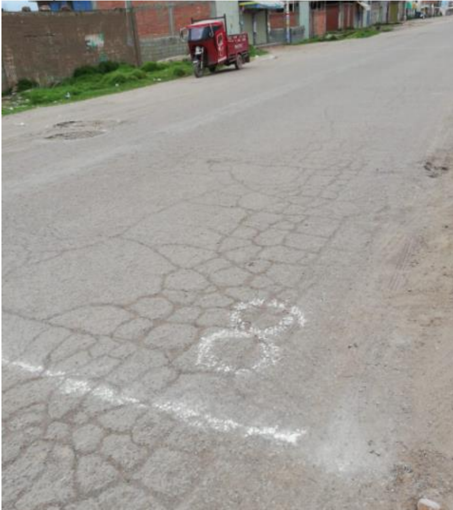
Fotografía 71. "Parches y fisuras de bloque en la unidad de evaluación N°07"
