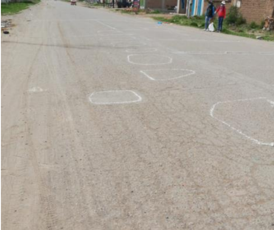
Fotografía 54. "Marcas de las zonas que no están afectadas por la falla piel de cocodrilo en el carril izquierdo de la unidad de evaluación N°05"
