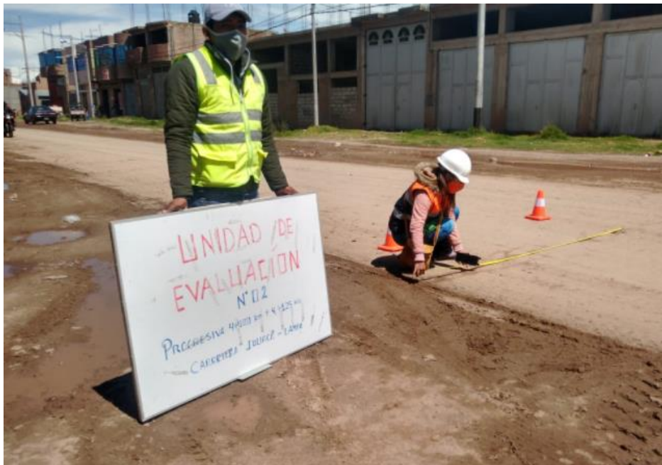
Fotografía 39. "Ubicación de la unidad de evaluación N°02 con progresivas del Km04 +100 al Km04 + 125"
