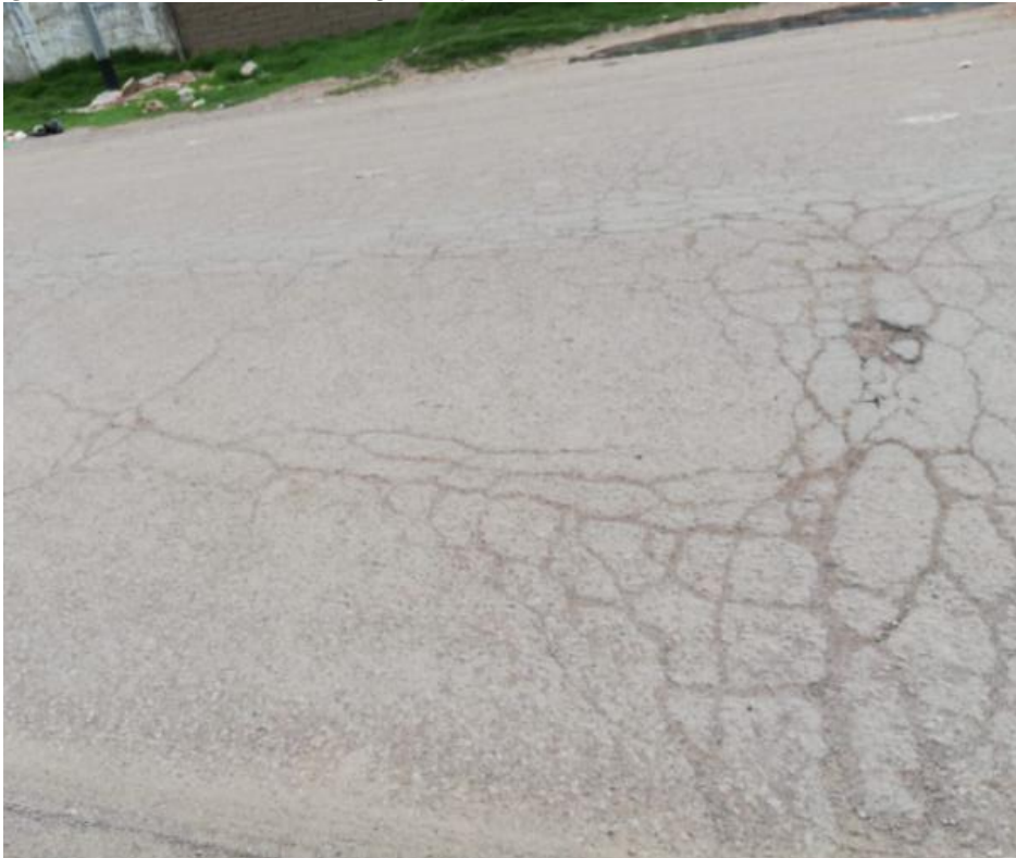
Fotografía 69. "Grietas longitudinales y piel de cocodrilo en la unidad de evaluación N°07"
