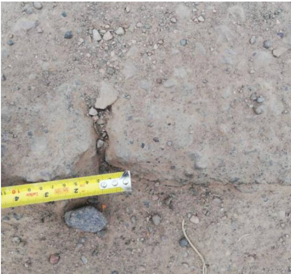
Fotografía 89. "Presencia de fisuras de borde de severidad alta"
