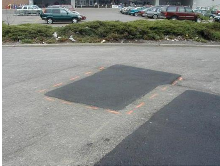
Figura 11. "Parches presentes en el pavimento"
