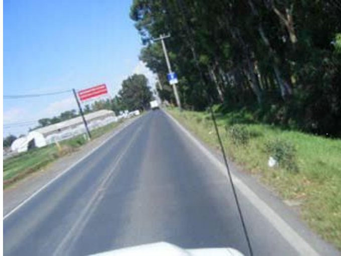
Figura 2. "Exudación presente en el pavimento" Fuente: David Azaña y Michael Gonzales (2019)
