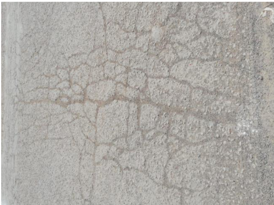
Fotografía 57. "Fisuras de piel de cocodrilo de severidad alta en la unidad de evaluación N°06"
