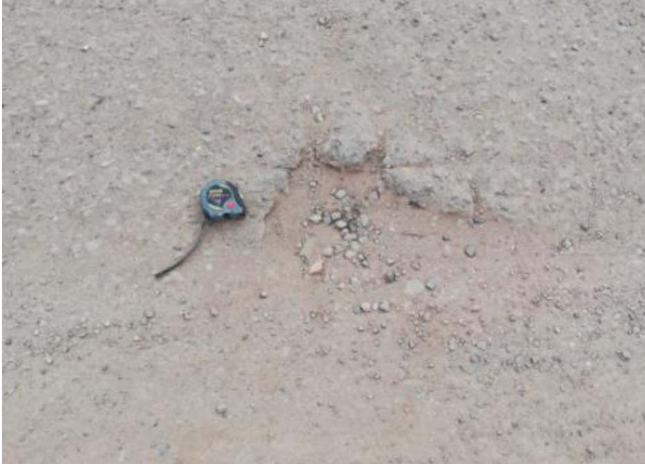
Fotografía 80. "Grieta de borde en la unidad de evaluación N°09"
