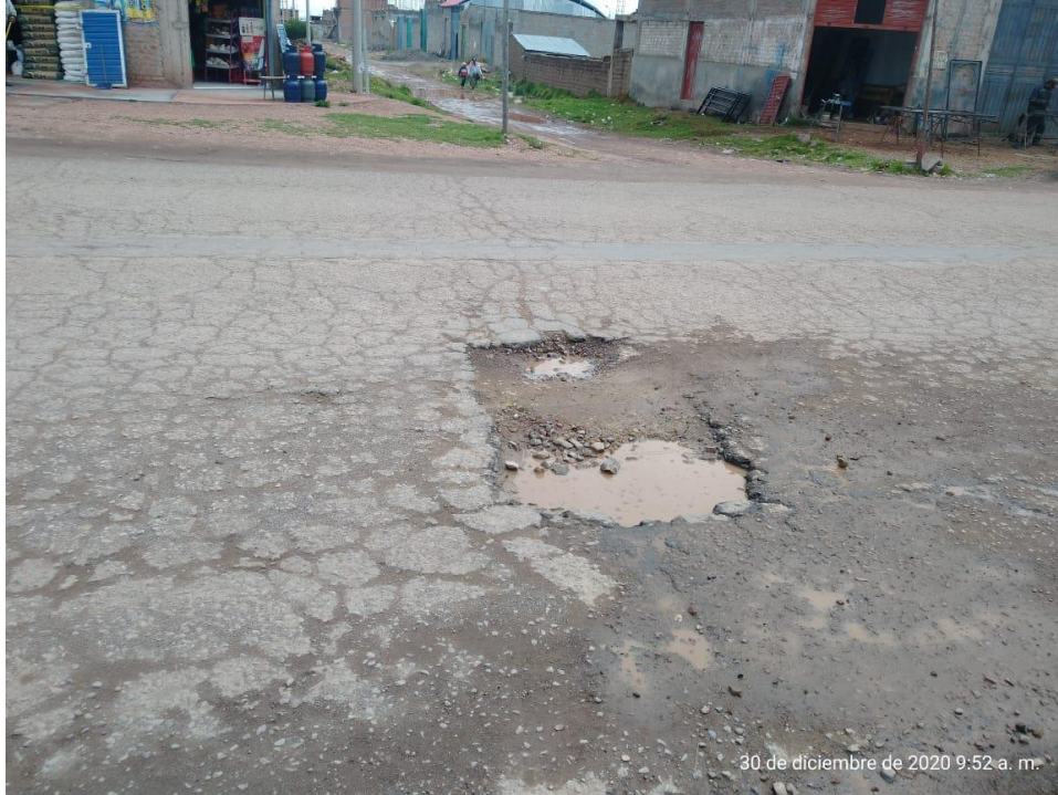
Fotografía 5. "Presencia de piel de cocodrilo, huecos de baja y alta severidad ubicada en el tramo 5 de la vía Julaica - Lampa"
