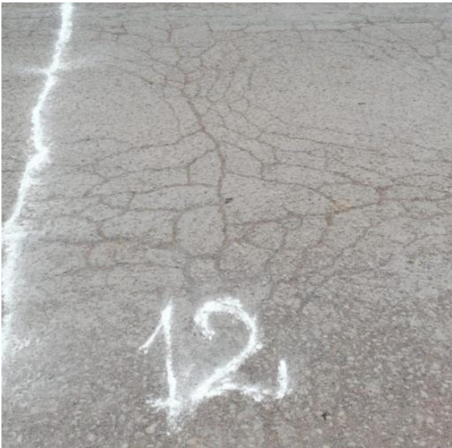
Fotografía 99. "Presencia de fisuras longitudinales, transversales y piel de cocodrilo en la unidad de evaluación N°12"
