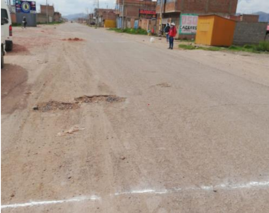
Fotografía 48. "Presencia de huecos y fisuras longitudinales de la unidad de evaluación N°04"
