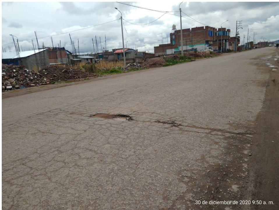
Fotografía 2. "Falla transversal y piel de cocodrilo ubicada en el tramo 5 de la carretera Juliaca - Lampa"
