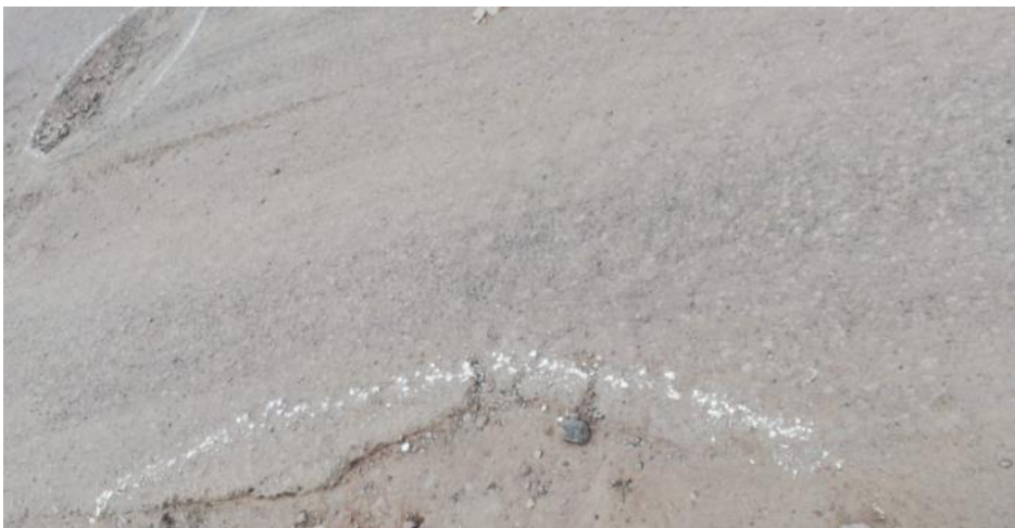
Fotografía 75. "Grieta de borde y desprendimiento de agregados en la unidad de evaluación N°08"
