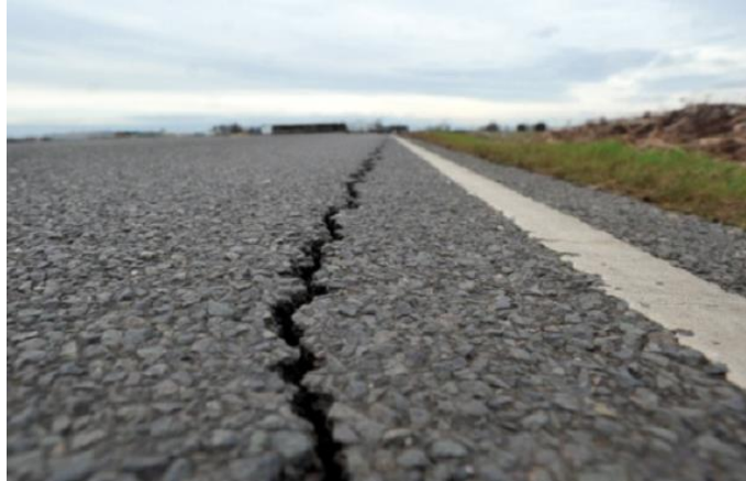
Figura 7. "Fisuras de borde en pavimentos"
