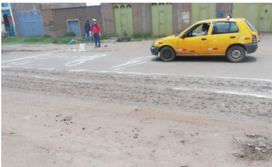
Fotografía 37. "Fallas encontradas en la unidad de evaluación N°01"
