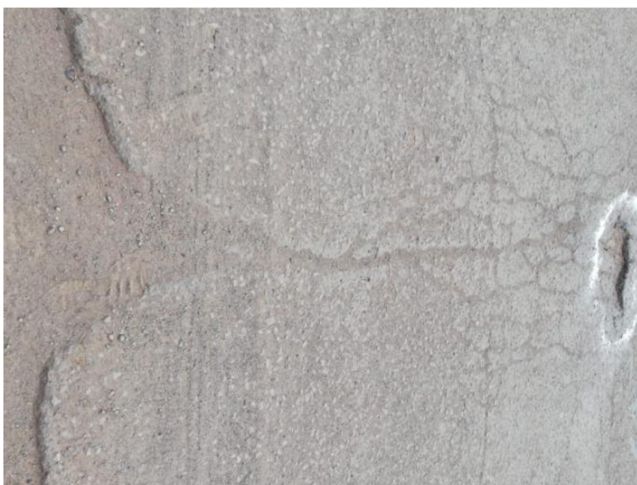
Fotografía 93. "Presencia de grietas de borde, fisuras transversales y huecos de severidad alta en la unidad de evaluación N°11"
