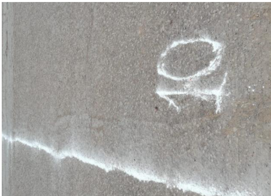
Fotografía 85. "Grietas longitudinales y transversales en la unidad de evaluación N°10"
