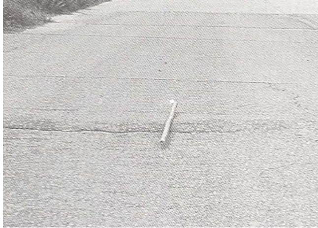
Figura 18. "Hinchamiento presente en el pavimento"
