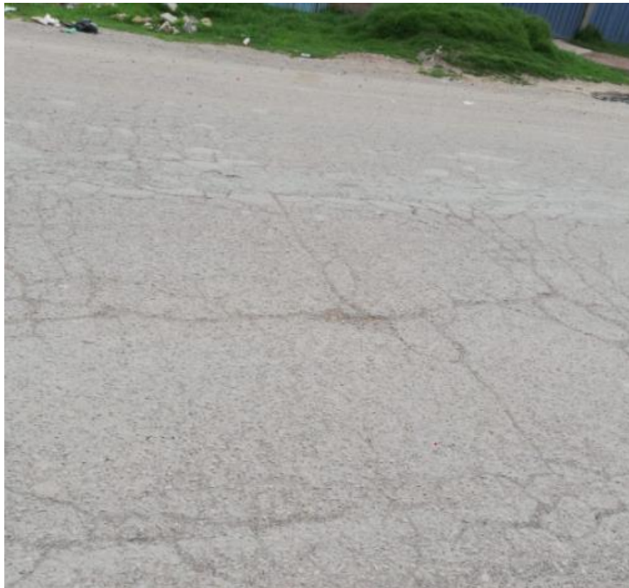
Fotografía 65. "Fisuras longitudinales y transversales de la unidad de evaluación N°07"
