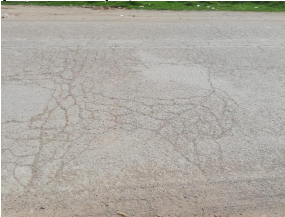
Fotografía 59. "Presencia de parches, fisuras longitudinales, transversales y piel de cocodrilo de severidad alta"
