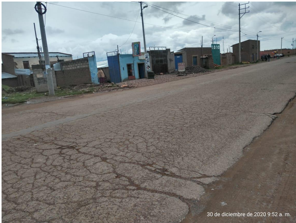
Fotografía 6. "Fisuras transversales y grietas de borde también la presencia de piel de cocodrilo de la vía Juliaca - Lampa"
