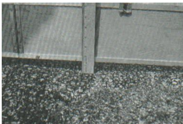
Figura 49. Ahuellamiento de alta severidad.
