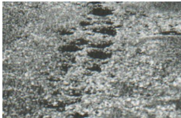
Figura 61. Meteorización alta severidad.
