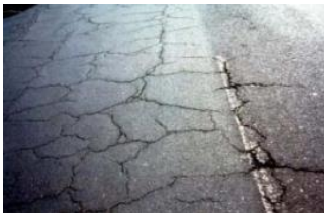
Figura 11. Agrietamiento en bloque de mediana intensidad
