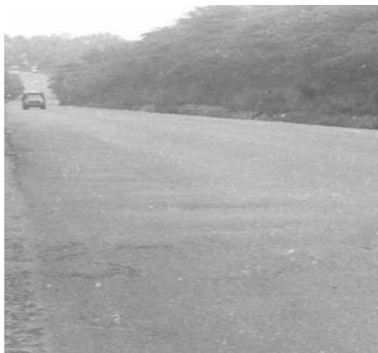
Figura 18. Corrugación de baja severidad.
