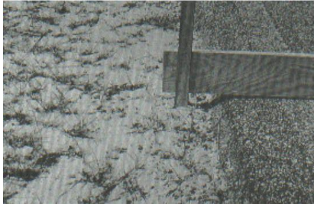
Figura 28. Desnivel carril / berma de baja severidad.
