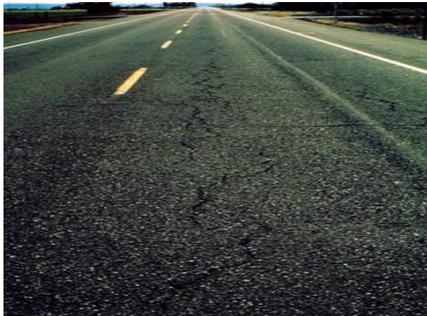
Figura 33. Grietas longitudinales de severidad media.
