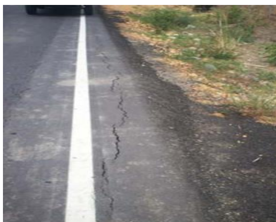
Figura 26. Grietas de borde de severidad media.
