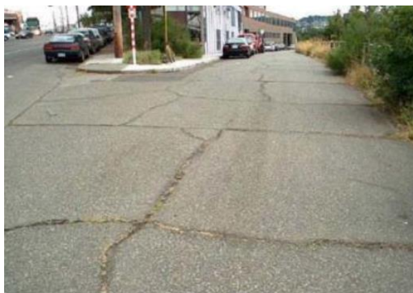
Figura 27. Grieta de borde de alta severidad.
