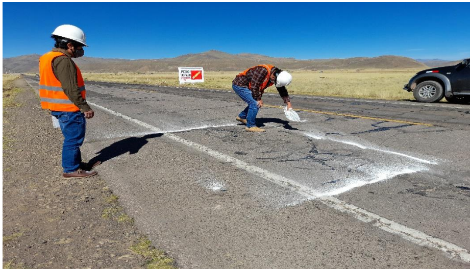
Figura 66. Demarcación de las fallas existentes de la carretera en evaluación. Fuente. Elaboración propia.
