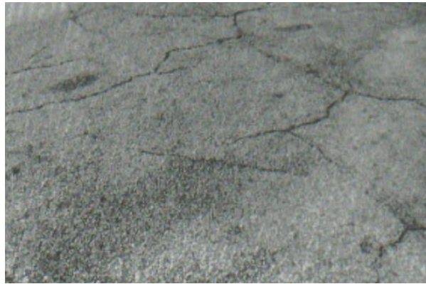
Figura 10. Agrietamiento en bloque de baja intensidad
