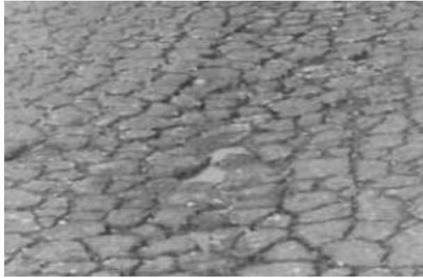
Figura 4. Piel de cocodrilo de Media severidad.
