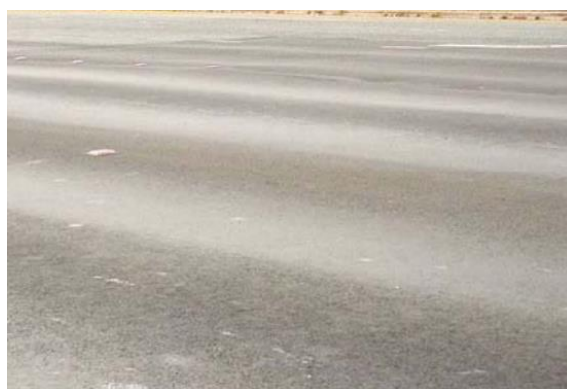
Figura 48. Ahuellamiento de severidad media.
