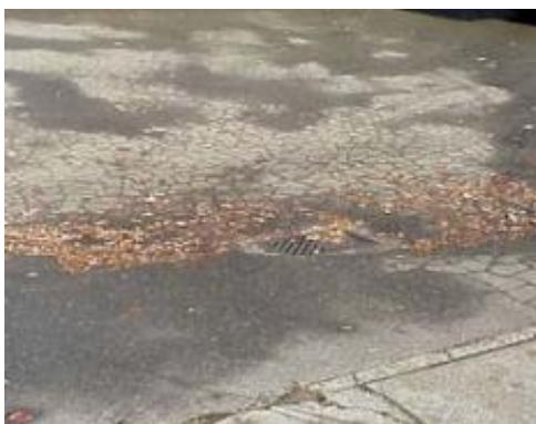
Figura 3. Piel de cocodrilo de Media severidad.
