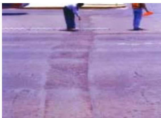
Figura 36. Parche de severidad media.
