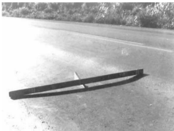
Figura 47. Ahuellamiento de baja severidad.
