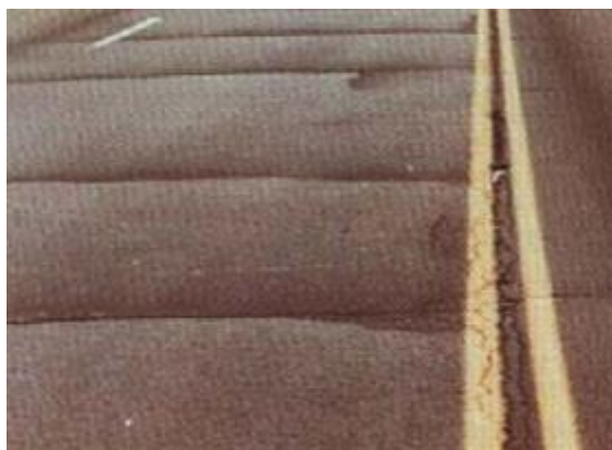
Figura 12. Agrietamiento en bloques de elevada intensidad.
