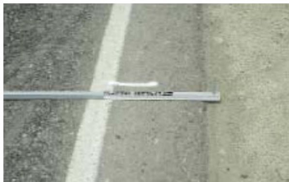
Figura 29. Desnivel carril / berma de severidad media.
