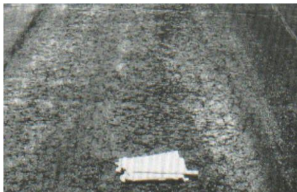
Figura 60. Meteorización severidad media.
