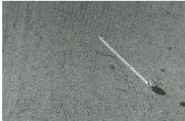
Figura 54. Grieta parabólica de baja severidad.
