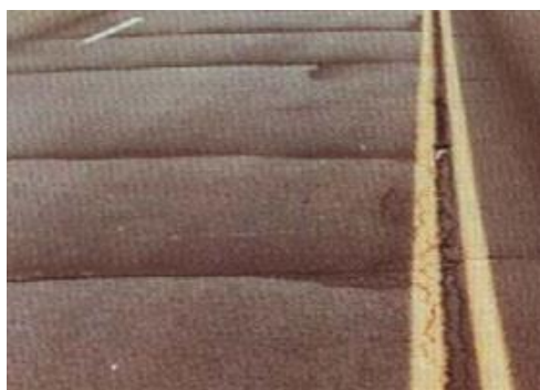
Figura 16. Hundimiento de alta severidad.
