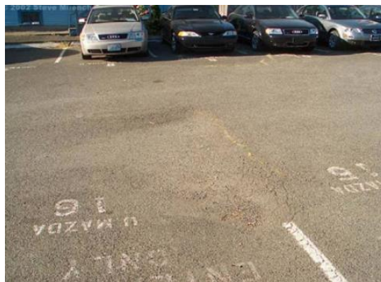
Figura 15. Hundimiento de severidad media.
