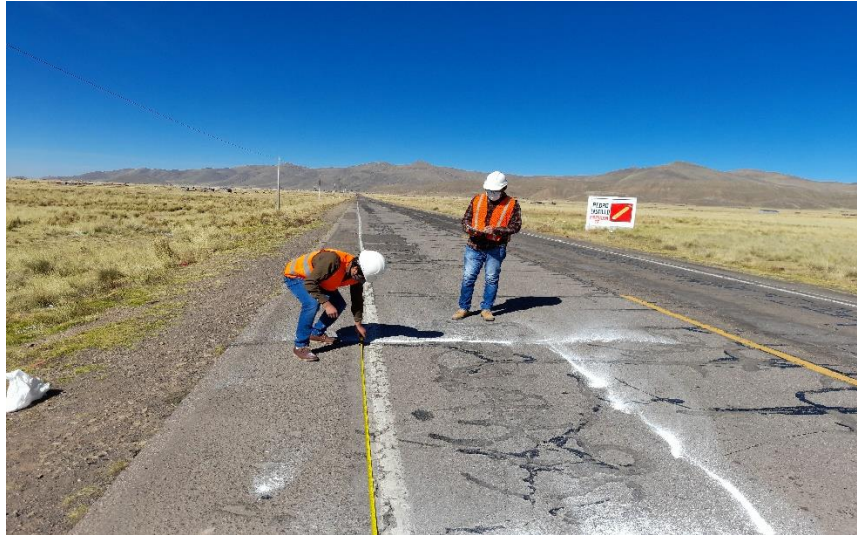
Figura 67. Medición de las fallas demarcadas dentro de la carpeta asfáltica Fuente. Elaboración propia
