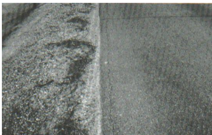
Figura 25. Grietas de borde de baja severidad.
