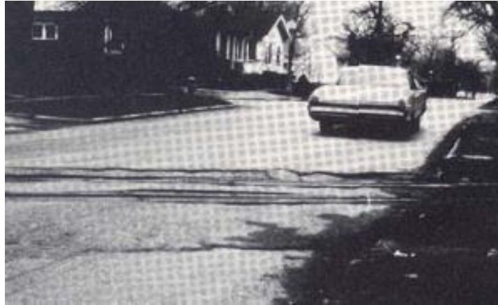
Figura 46. Cruce de vía férrea de alta severidad.
