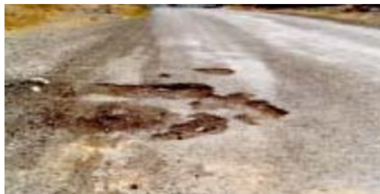
Figura 43. Hueco de severidad alta.
