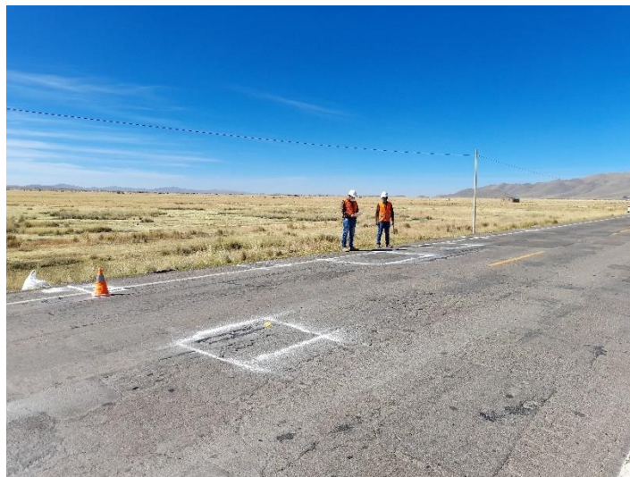
Figura 68. Registro de fallas en el pavimento flexible. Fuente. Elaboración propia.
