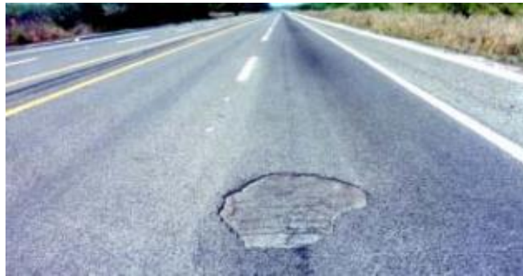
Figura 42. Hueco de severidad media.
