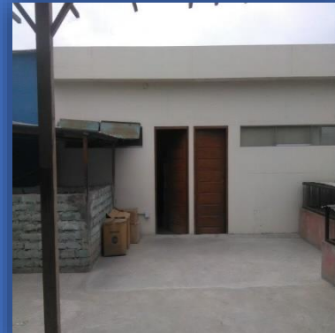
Figura 58: aula y deposito en azotea Fuente: Propia
