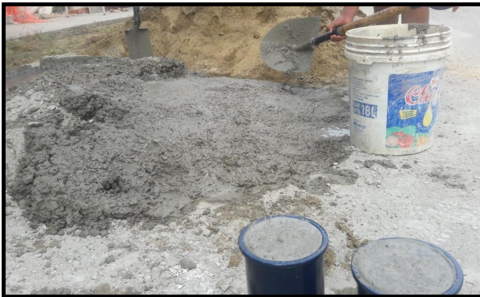
Fotografía N°03 Mezclado manual en obra: se puede apreciar, que por un momento, el maestro dejó mezclando a un menor de edad.
