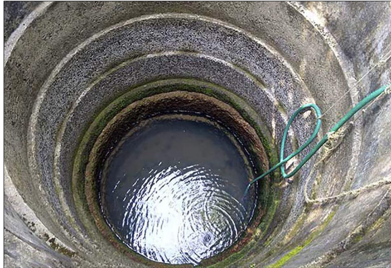
Figura 5. Pozo de agua subterránea. Fuente: buscaragua.com
