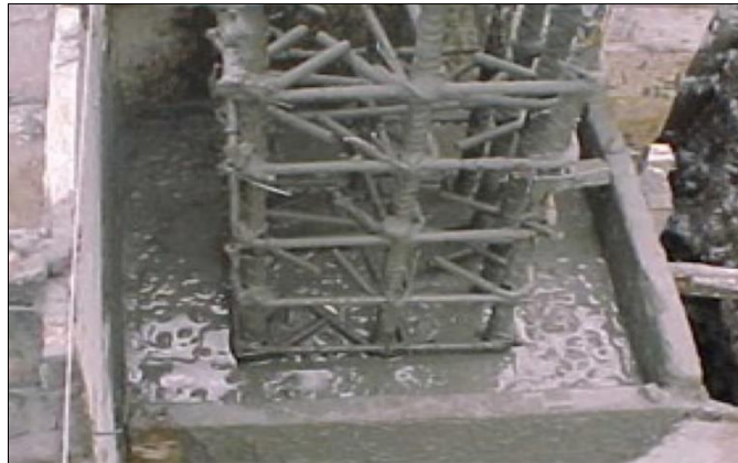
Figura 11. Exudación del concreto. Fuente: UMNG Colombia
