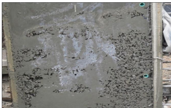
Figura 10. Segregación del concreto. Fuente: UMNG Colombia
