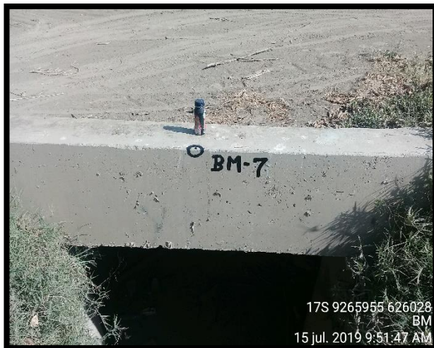
Figura 5: Se observa BM07, localizado en el sardinel del canal rectangular de concreto, (cruce de carretera).
