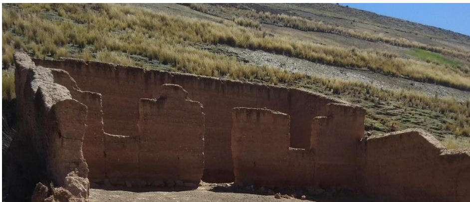
Figura 01. Viviendas de adobe en mal estado.
