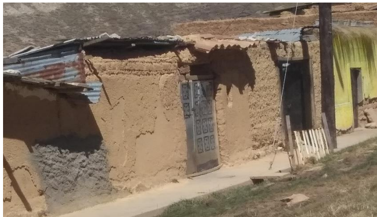
Figura 02. Viviendas de adobe con fallas. Fuente: propia.
