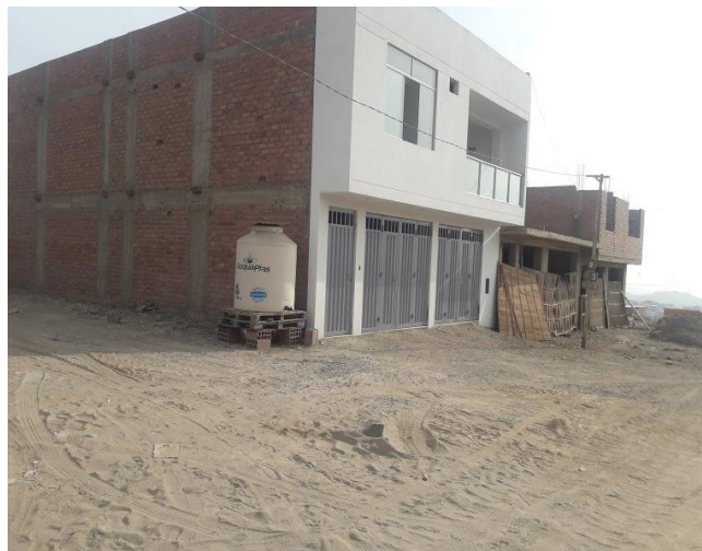
Figura 3: Vivienda de 2 pisos asentado sobre relleno antrópico.
