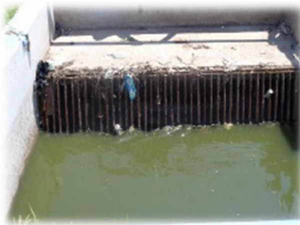
Figura 2.12 Cámara de Rejas Salida PTAR Juliaca Fuente: Diagnostico Situacional de la PTAR de Juliaca
