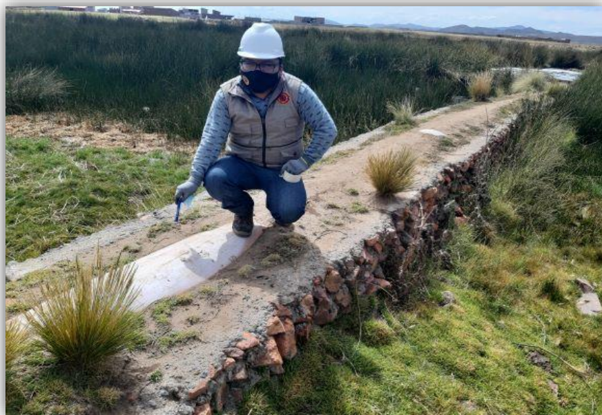
Tubería del efluente de la PTAR Juliaca
