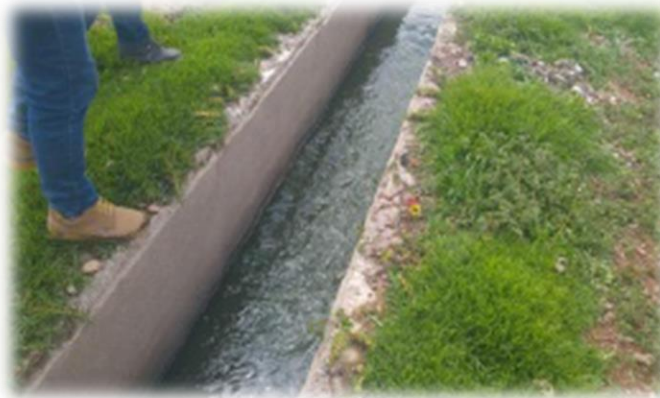
Figura 2.7 Canales de Distribución PTAR Juliaca
