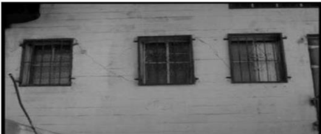
Figura N°4: Grietas formadas por tensión diagonal
