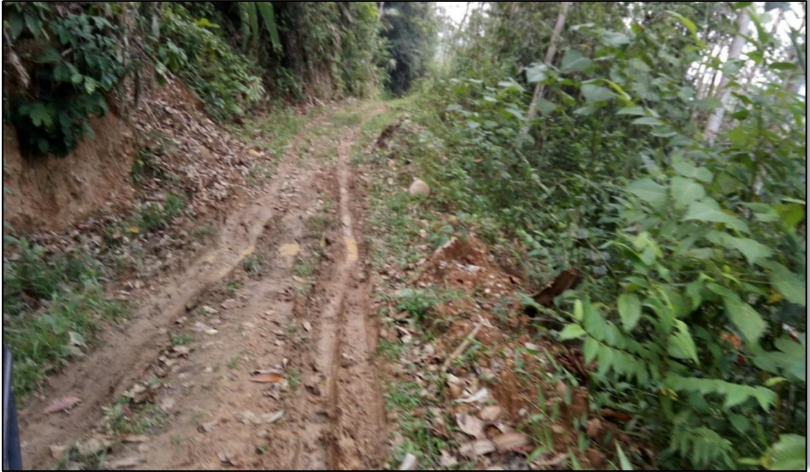
Figura 3: Plataforma sin superficie de rodadura se puede apreciar la necesidad de colocar una capa de afirmado.
