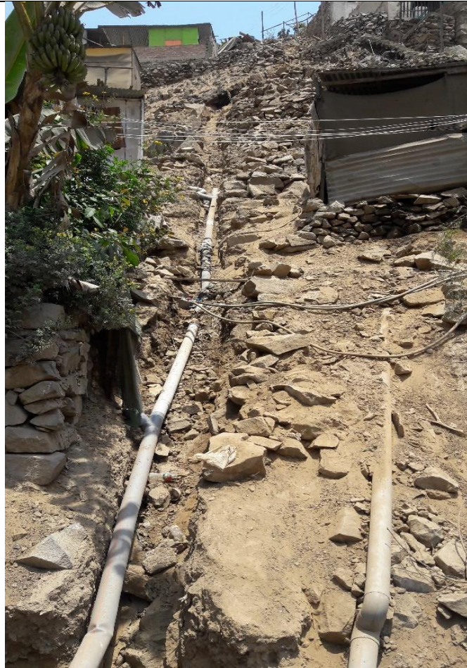
Visualización de instalaciones de desagüe clandestinas
