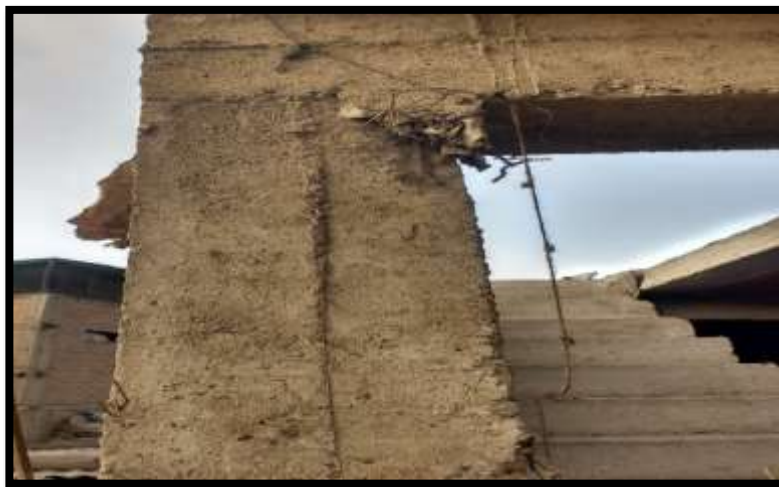
Junta fría entre la columna y la viga
