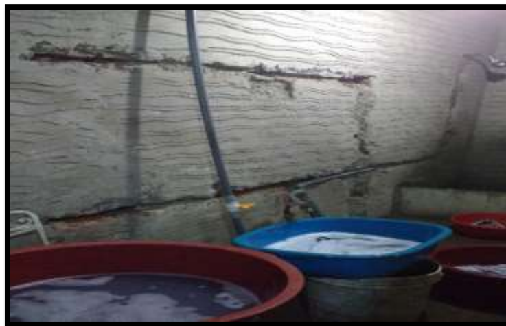
Humedad en muros
