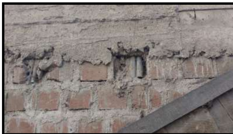
Cangrejas y acero expuesto
