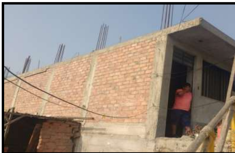
Muros de contención sin armadura
