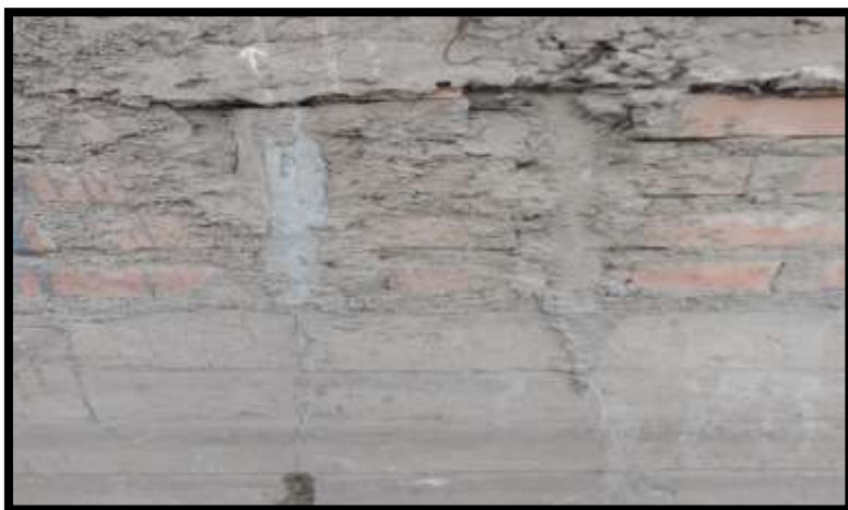
Acero expuesto y cangrejera
