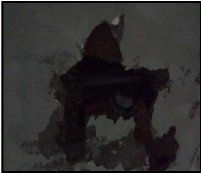
Humedad en muros
