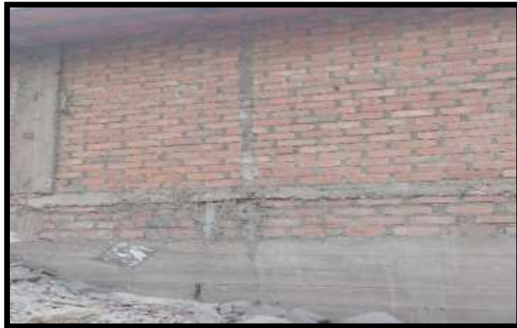
Muro portante debilitado por bajante
