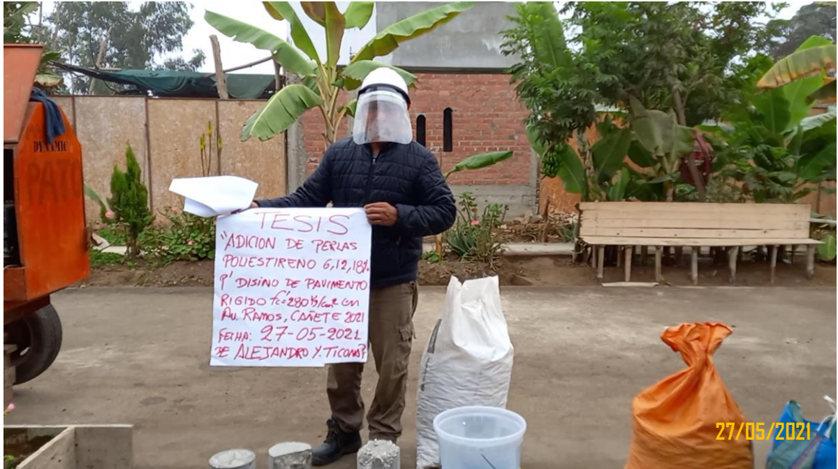
Figura 80: Se muestra preparativos al vaciado del pavimento rígido f'c=280\text{kg/cm}^2 con adición de 18% perlas de poliestireno, en la av. Ramos Cañete, fecha 27/05/2021.
