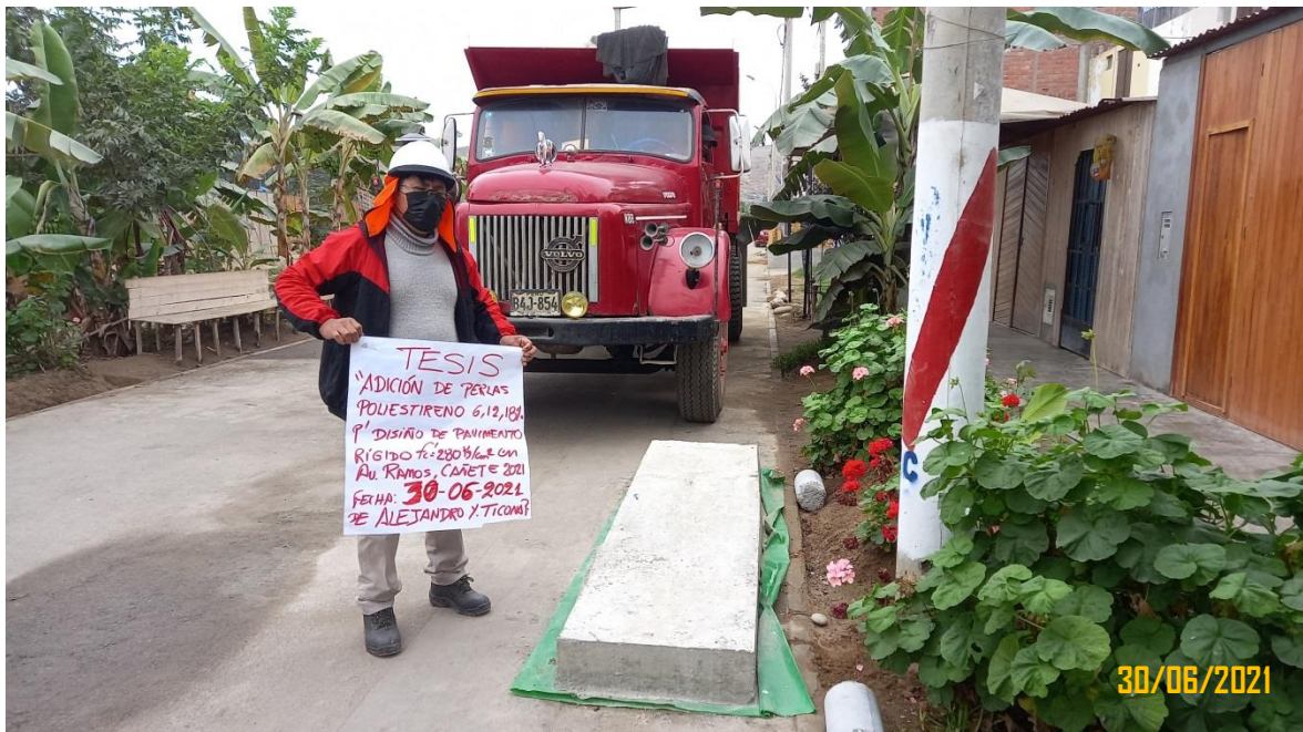
Figura 86: Se muestra acciones previas al sometimiento de la fuerza viva (camión volquete) en la cual se pretende evidencias la deformación real del pavimento rígido f'c=280\text{kg/cm}^2 en campo, mediante un vehículo de peso de 20TN.
